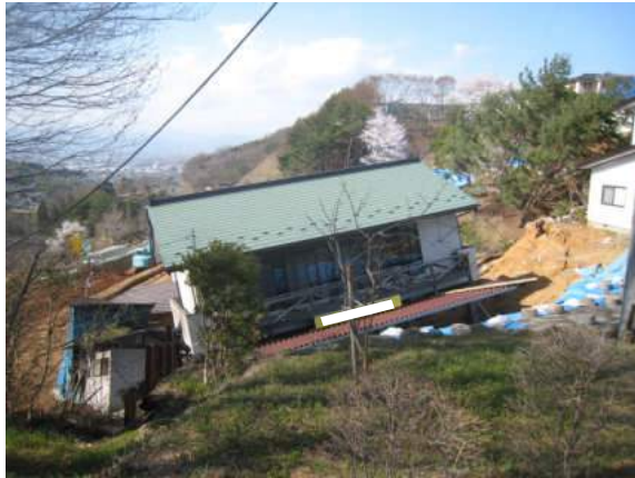
写真 5.5.2.3-49 写真 5.5.2.3-47 の地すべりで滑り落ちかけた住宅
