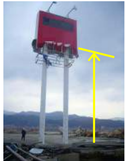
写真 6. 2. 1-9 広告塔の損傷状況
