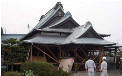
写真 5.2.2-17 大きく傾斜した寺社建築
