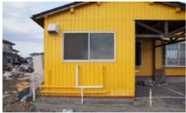
写真6.3.13-2 建物外装材に残る浸水痕
