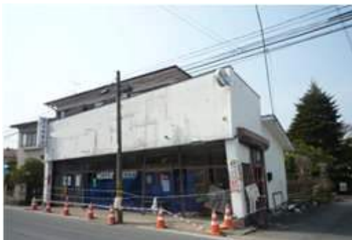
写真 5.2.2-13 残留変形が大きい店舗併用住宅
