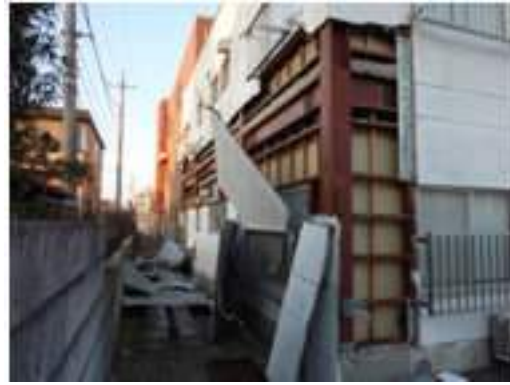
写真 5. 4-198 鉄骨造建築物の外壁仕上げの剥落
