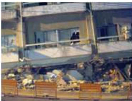
写真 5.4-109 ピロティ部の柱の破壊
