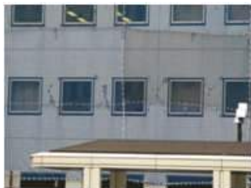
写真 5.4-7 外壁タイルの剥落
