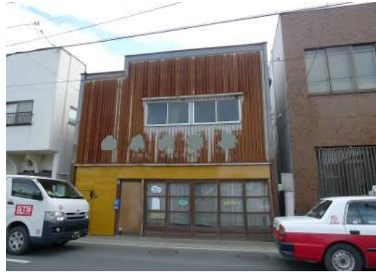
写真 5.2.4-6 傾斜した店舗併用木造住宅
