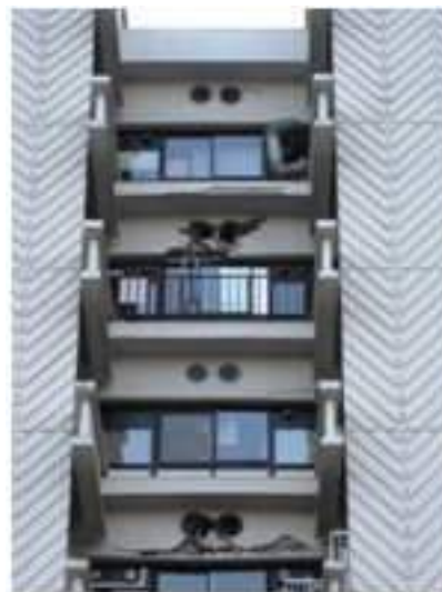
写真 5. 4-32 開口付き境界梁の損傷
