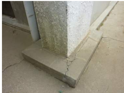
写真 5.3-33 ひび割れ (MIT-13)
