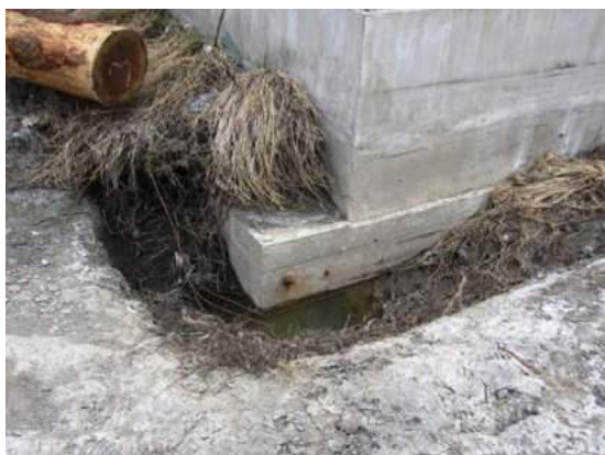
写真3 洗掘した基礎
