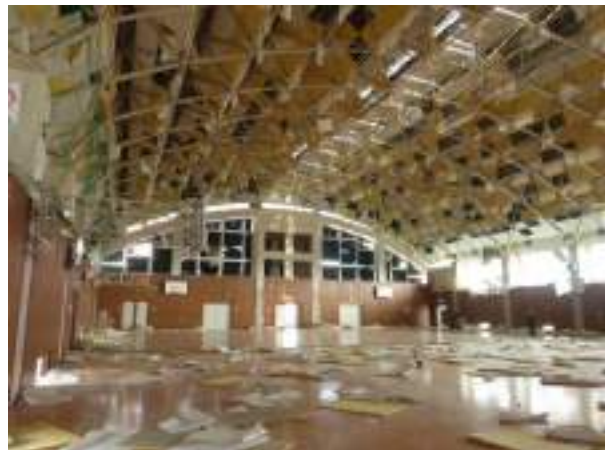
写真 5. 6-47 グラスウール板の脱落
