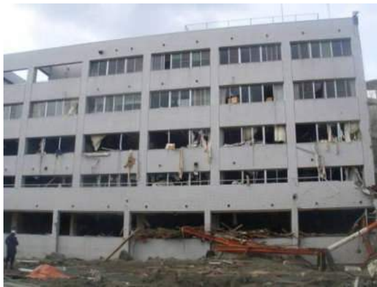
写真3 新館開口部の被害状況 (4階までの窓ガラスに破損が認められる)
