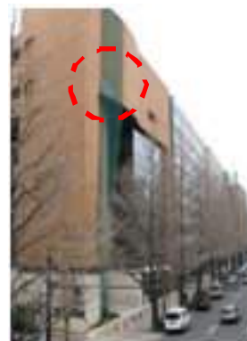
写真 5.4-8 外壁タイルの剥落
