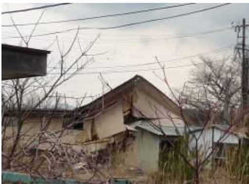
写真 5.2.6-27 倒壊した建築物
