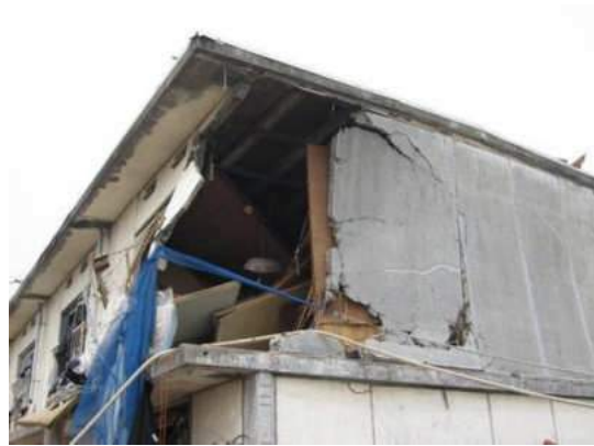
写真2 漂流物の衝突による2階部分の損傷
