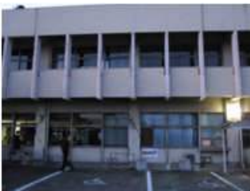
写真 5. 4-199 建築物の被害の外観
