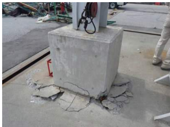
写真 3 曲げ破壊した基礎
