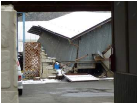
写真 5.2.1-15 作業小屋の倒壊 (栗原市栗駒桜田)
