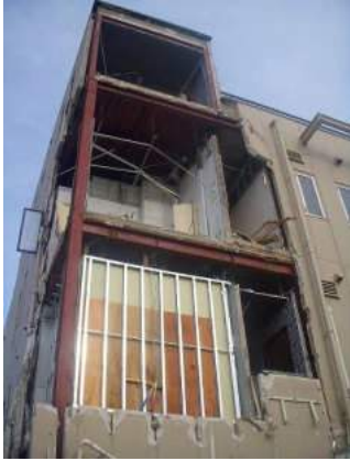
写真 5.3-5 外装材の脱落 (二本松市)
