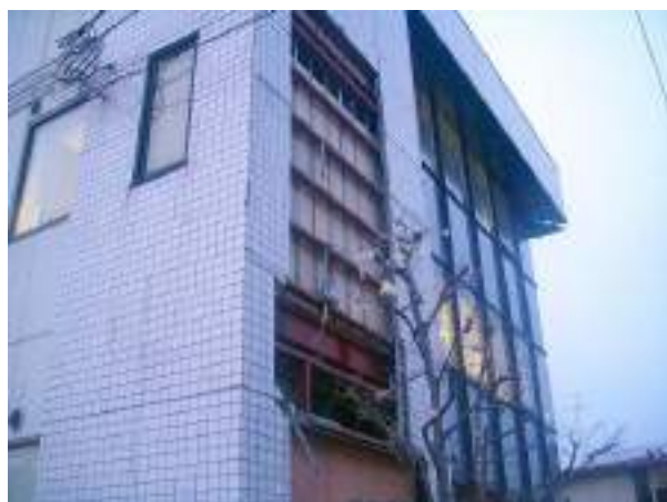
写真 5.6-16 ラスモルタル外壁の脱落被害
