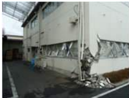
写真 5.4-40 腰壁付き短柱の軸崩壊
