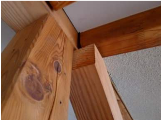
写真5.2.10-11 写真5.2.10-10の筋かいのはずれ
