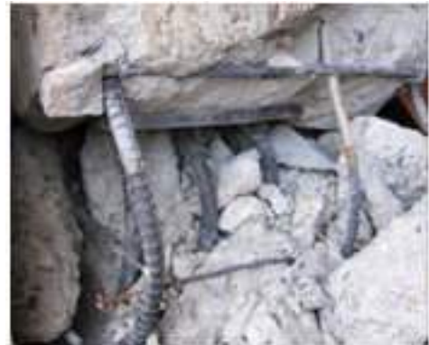
写真 5.4-172 SRC柱脚部の損傷
