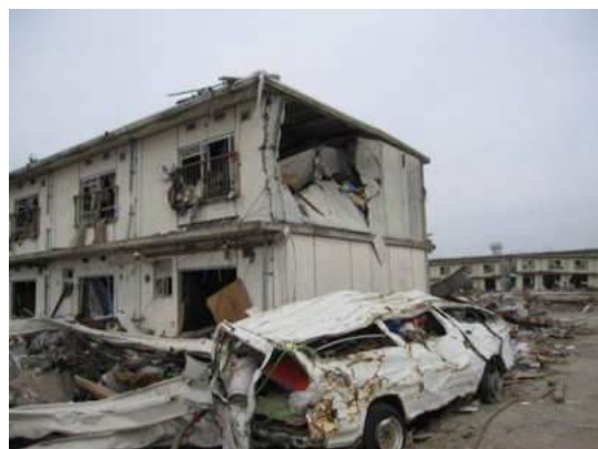
写真2 2階妻壁の損傷
