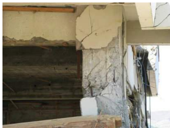
写真4 損傷した2階RC柱部分
