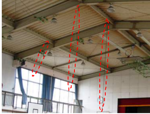
写真 5.3-29 ターンバックルの端部破断による垂れ下がり (KSM-1)
