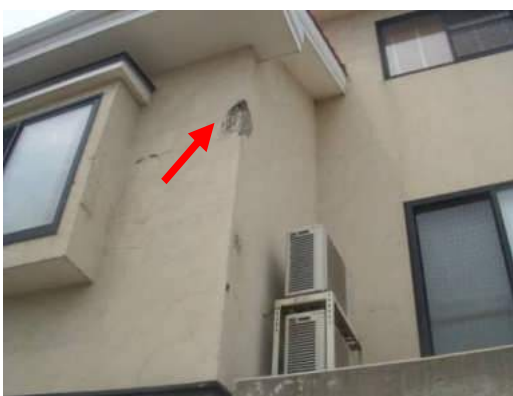
写真4 2階外壁の衝突痕
