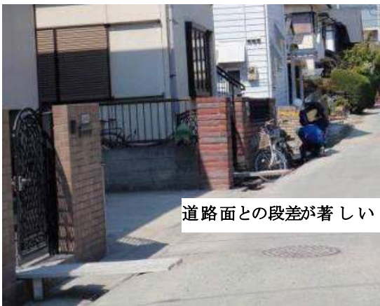
写真 5.5.2.2-7 傾斜住宅の裏側の沈下状況 (写真 5.5.2.2-5 の被害住宅の裏側)
