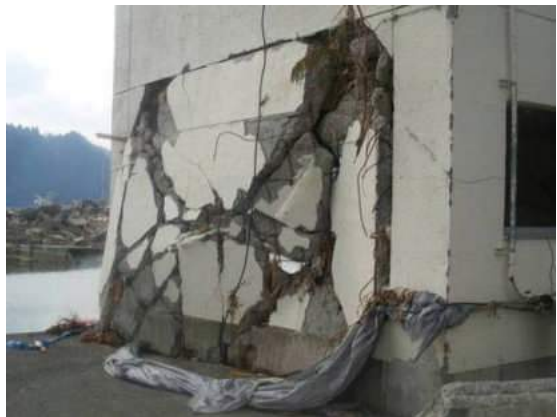
写真4 外壁の破壊状況
