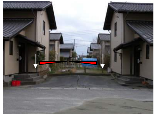
写真 5.5.2.1-30 空気を挟んだ2棟の沈下
