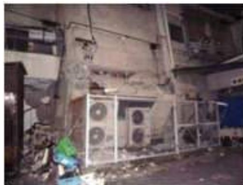
写真 5.4-111 1階耐力壁頂部の曲げ破壊
