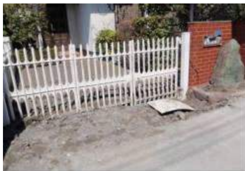
写真 5.5.2.2-3 沈下と敷地内噴砂の状況
