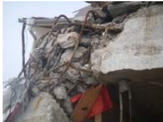
写真 6. 3. 11-40 1F 柱頭の損傷
