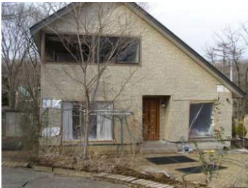
写真 5.2.7-11 サイディングの剥落 (豊原乙地区)
