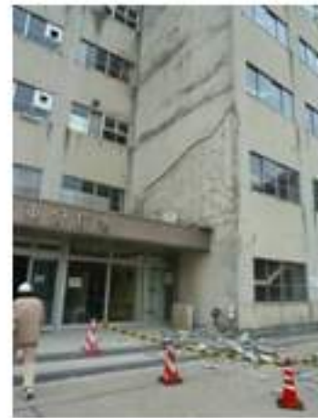
写真 5.4-66 エントランス脇の外壁仕上げの剥落
