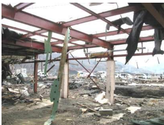
写真3 ブレースの破断と屋根版の流失
