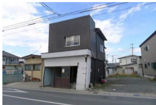
写真 5. 2. 4-4 傾斜した店舗併用木造住宅
