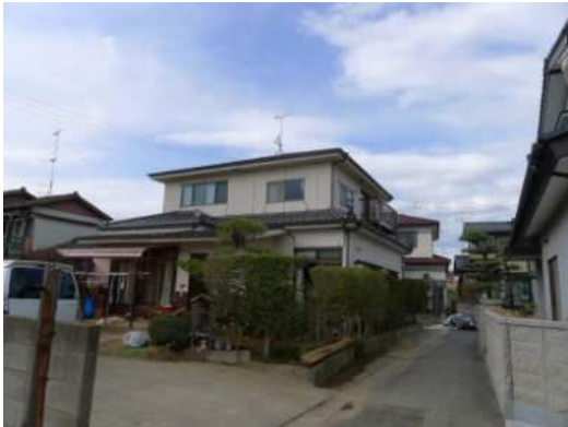
写真 5.2.4-9 外壁に亀裂の入った木造住宅
