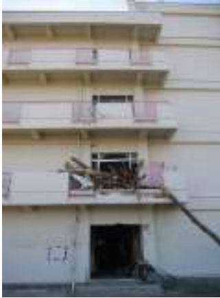
写真 6. 3. 10-15 東側妻面の破損状況 (3 階手摺に損傷が認められる)
