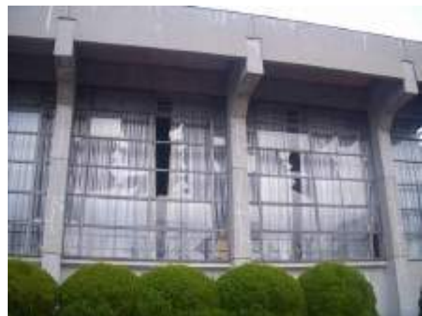
写真 5.6-23 体育館の窓ガラスの被害
