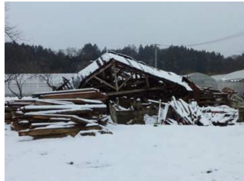
写真 5.2.1-16 木材小屋の倒壊 (栗原市栗駒桜田)
