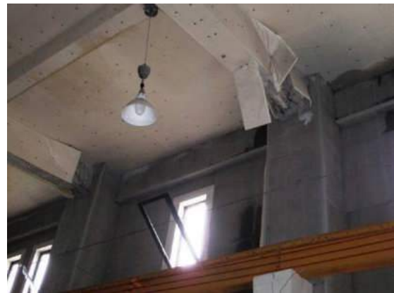
写真 2 3階梁下端筋の降伏
