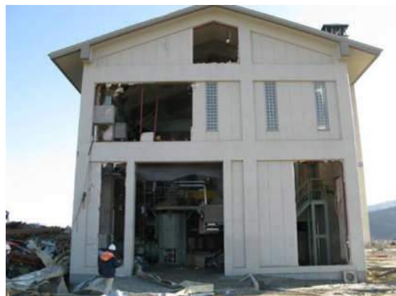
写真 2 脱落した ALC パネル
