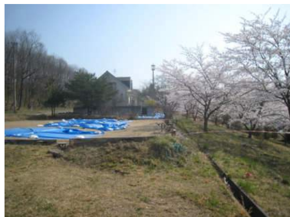
写真 5.5.2.3-30 緑ヶ丘1丁目の斜面地①および頂部に生じた地割れ（一部ブルーシート掛け）
