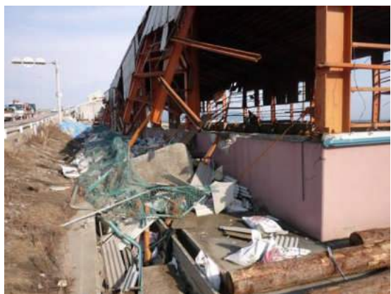
写真4 損傷状況（倉庫2、道路側）
