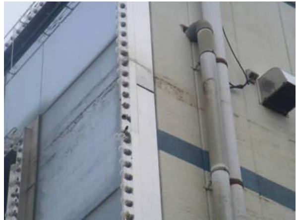
写真2 壁面に残った浸水痕
