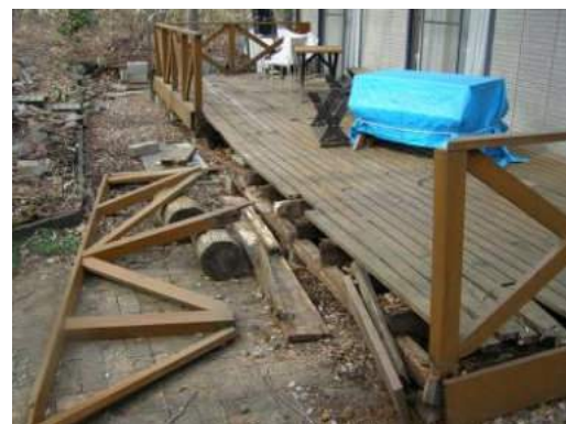
写真 5.2.7-6 ウッドデッキの損壊 (豊原乙地区)
