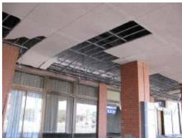
写真 5.6-25 軒天井の被害
