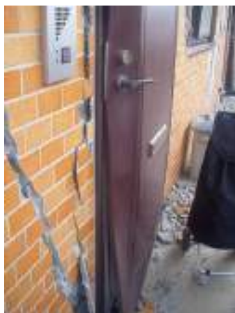
写真 5.6-24 玄関ドアの被害
