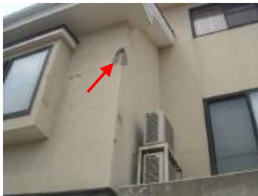
写真 6.3.13-34 2階外壁の衝突痕
