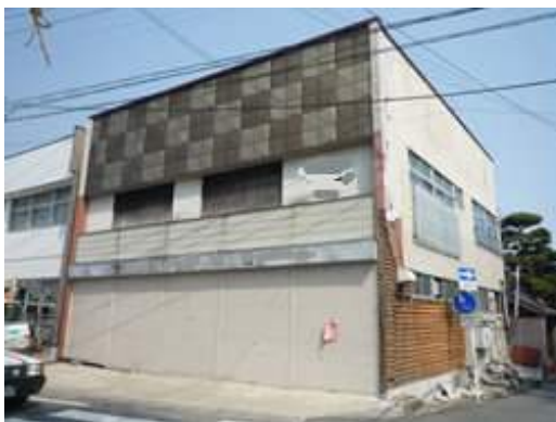
写真 5.2.2-4 残留変形がある店舗併用住宅
