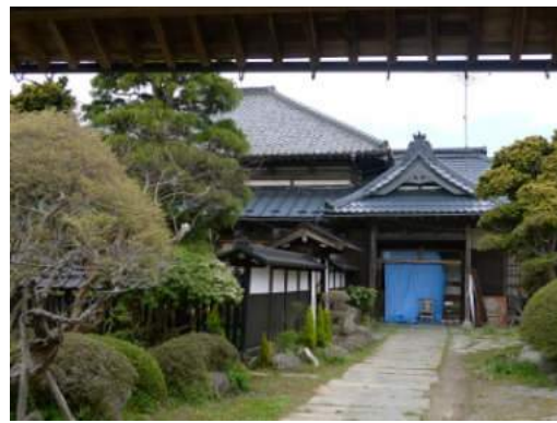
写真 5.2.3-14 残留変形が認められる軸組構法住宅
