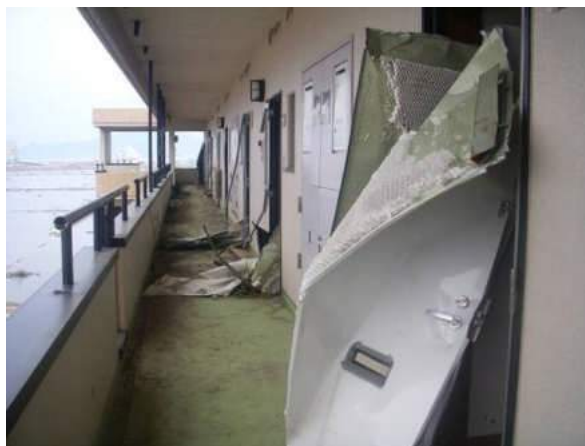
写真4 3階外廊下の被害状況
