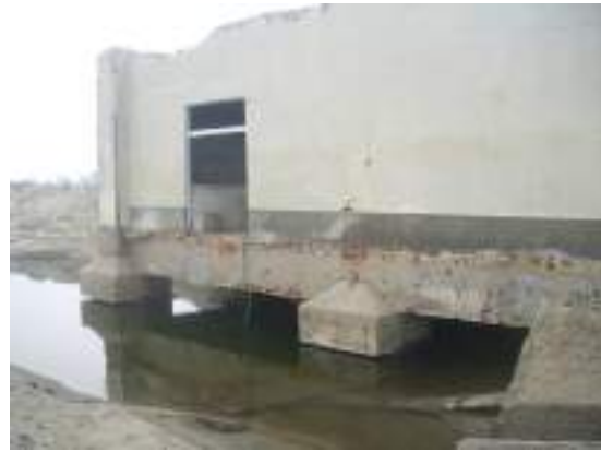
写真 6. 3. 11-44 周辺地盤の洗掘
