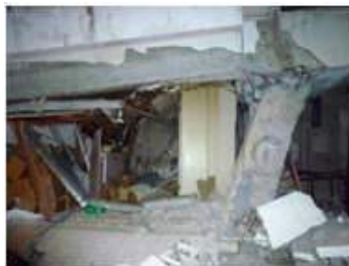
写真 5.4-110 1階柱頭・柱脚の曲げ破壊
