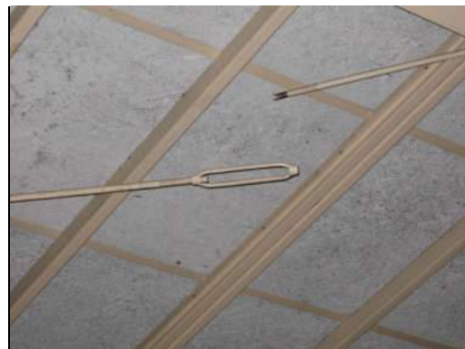
写真 5.3-28 ターンバックルの破断(MIT-25)
