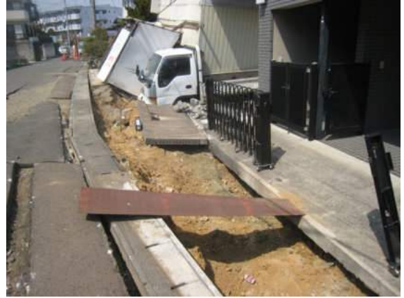
写真 5.5.2.3-4 写真 5.5.2.3-3 の住宅と前面道路との間に生じた隙間
