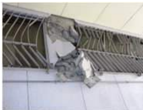
写真 5.4-142 2階の短柱のせん断破壊
