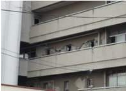
写真 5.4-125 非構造壁の損傷
