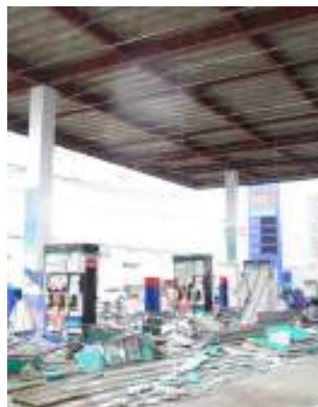
写真 5.6-13 ガソリンスタンドの天井の被害
