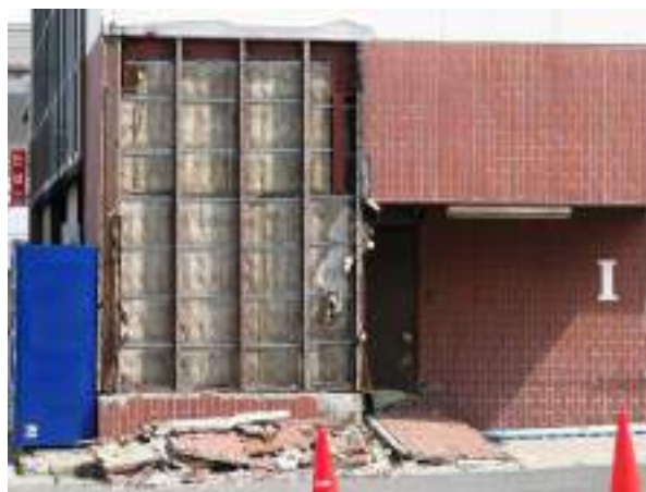
写真 5.6-15 ラスモルタル外壁の脱落被害
