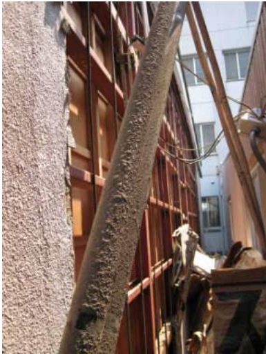
写真 5.3-46 外装仕上げの落下 (MIT-5)
