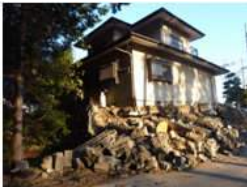
写真 5.4-195 地盤変状の被害
