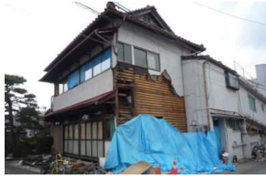
写真 5.2.6-10 階段室部分が崩壊した木造 が落下する危険性のある状態
