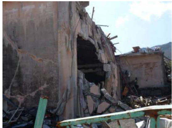
写真2 柱折損 (建物西面)
