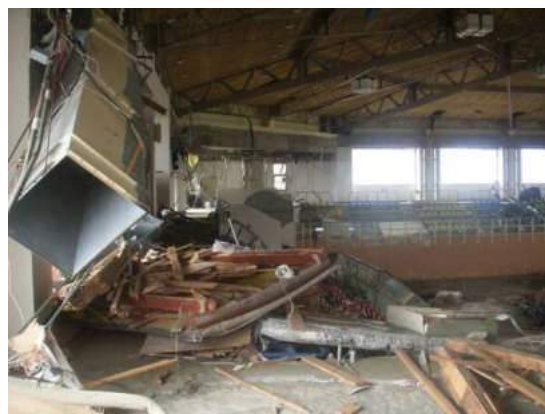
写真3 体育館内部の状況
