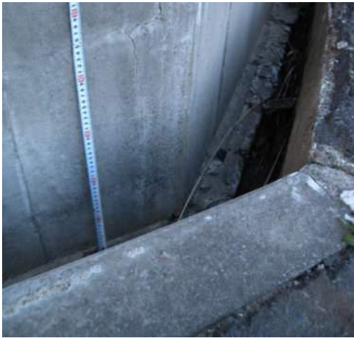
写真 5.5.2.1-39 外周部塀と前面道路との段差
