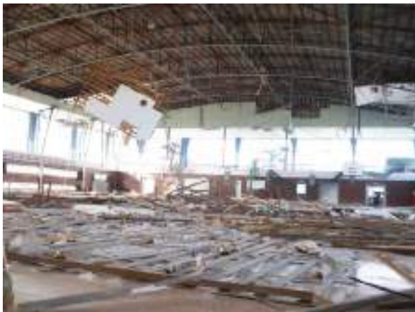
写真 5.6-38 木下地による天井の脱落被害
