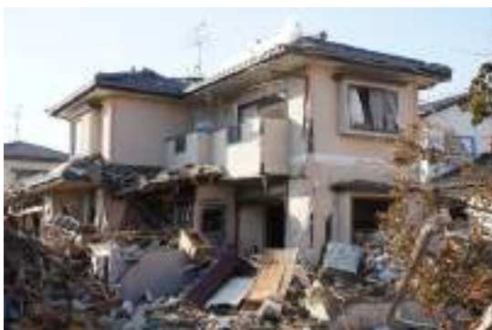
写真 6.3.10-40 残存する木造建物(㉑)
