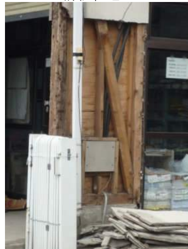
写真 5.2.3-16 写真 5.2.3-15 の隅角部の柱の腐朽
