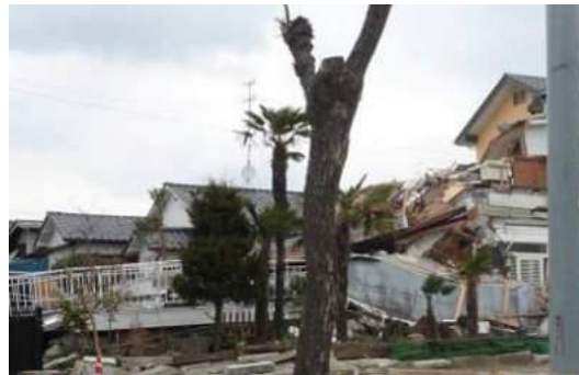
写真 5.2.6-22 倒壊家屋 (構造種別不明)
