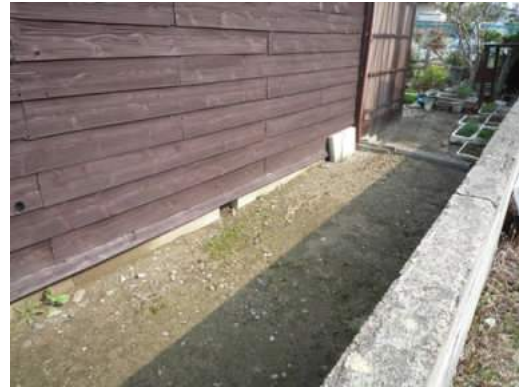
写真 5.2.2-16 写真 5.2.2-15 の液状化した敷地
