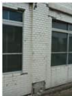
写真 5.4-130 柱脚部の損傷
