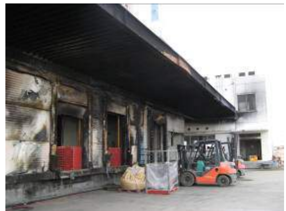
写真 7.3.1-2 仙台塩釜港北側の倉庫1の火災
