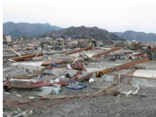
写真 6.4.2-6 1階柱の残存 (大槌町)
