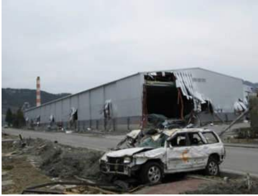
写真 6.4.2-24 倉庫（大船渡市） （津波の流出口として妻壁及び開口部が外側に変形）
