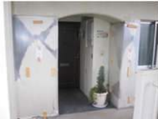
写真 5.4-22 非構造壁のせん断破壊 （損傷部分が養生されている）
