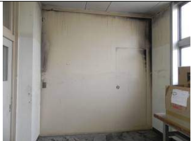
写真 7.3.16-6 防火戸（非火災側）
