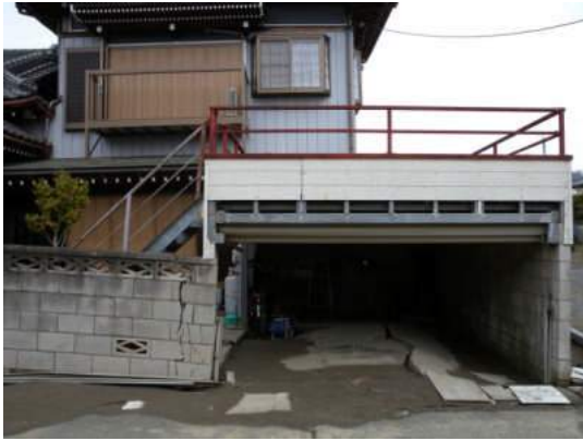
写真 5.5.2.1-5 周囲の住宅被害 (土間コンクリート破損)
