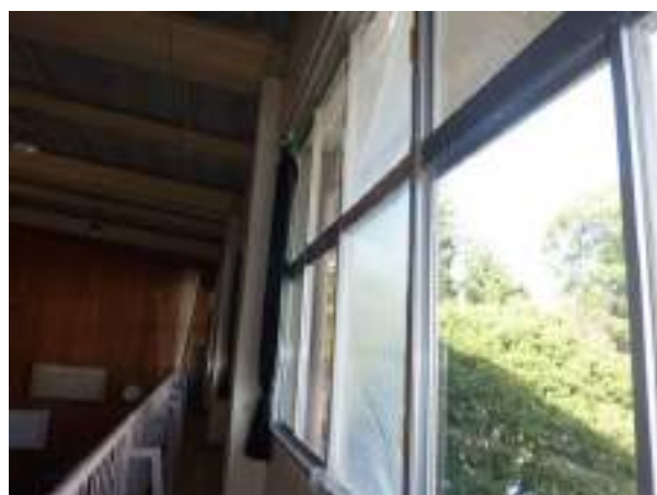
写真 5.6-55 はめ殺し窓のガラスの被害
