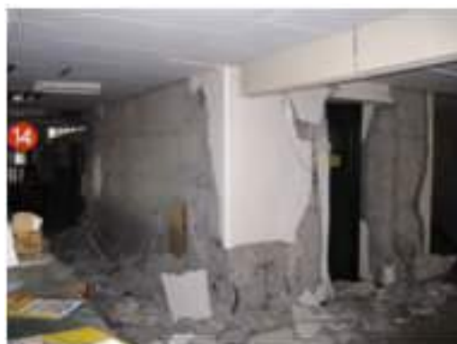
写真 5.4-120 コア壁のせん断破壊
