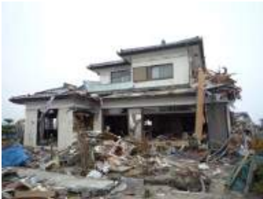
写真 6.3.11-10 残存した木造家屋 (⑧)
