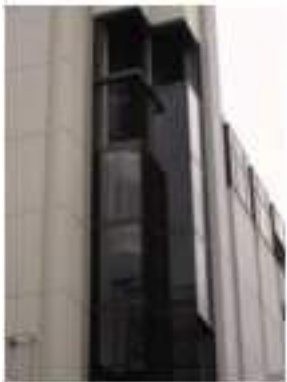
写真 5.4-9 エレベータ回りのガラスの落下
