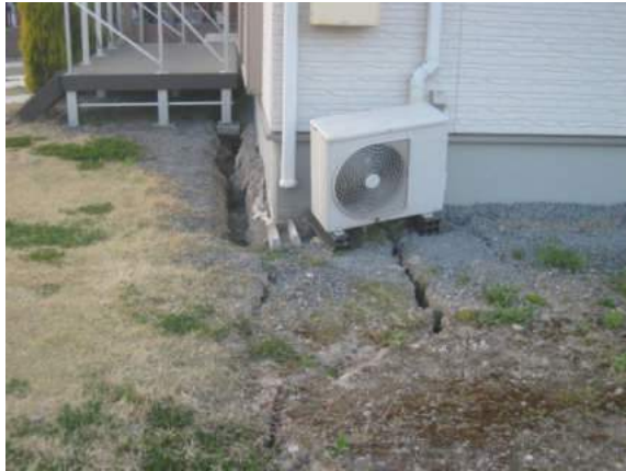
写真 5.5.2.3-53 写真 5.5.2.3-52 の住宅の地盤の変状
