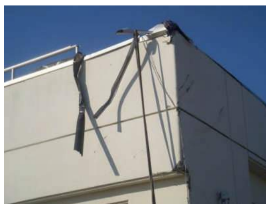
写真2 2階手摺の破損
