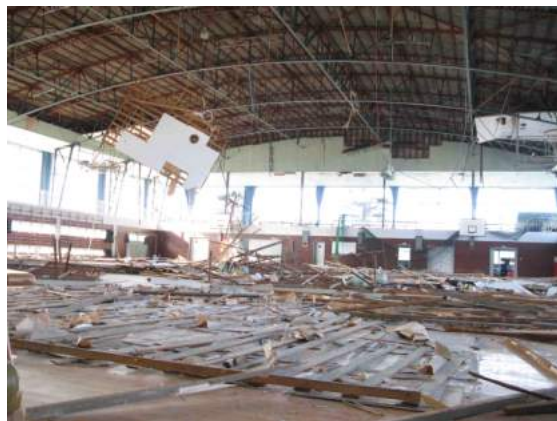
写真 5.3-40 天井材脱落 (HTC-4)
