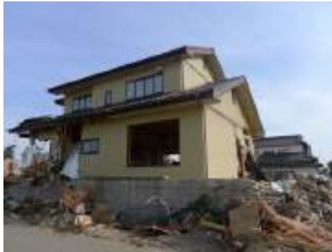
写真 6. 3. 11-61 残存した木造住宅 (⑦)
