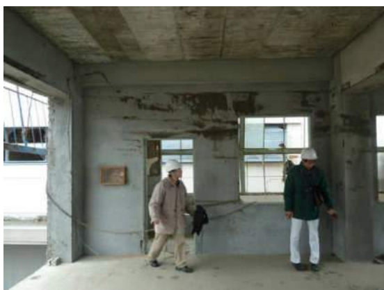
写真3 建物1階の浸水痕
