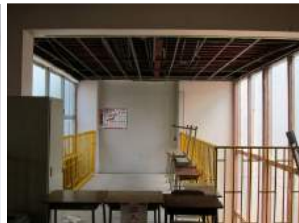
写真 5. 6-37 建物接続箇所での天井の被害
