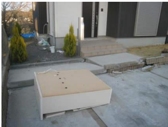
写真 5.5.2.3-55 宅地地盤の変状による損傷
