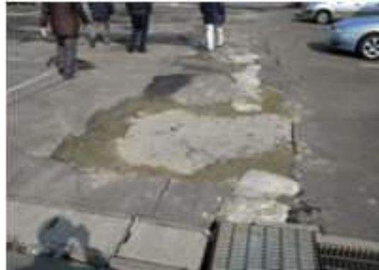
写真 5.4-62 地盤の変状の跡
