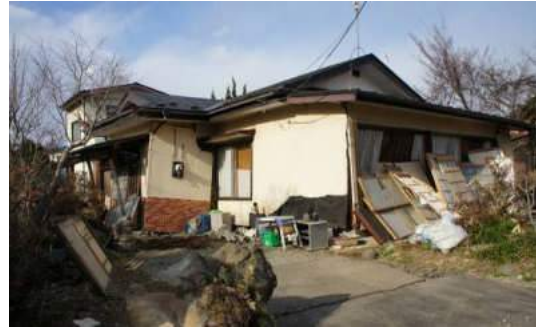
写真 5.2.7-18 地盤変状に伴う住宅被害 (西大久保地区)
