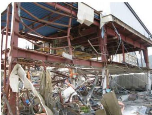
写真 6.4.2-27 間柱等の非構造部材の変形（釜石市）
