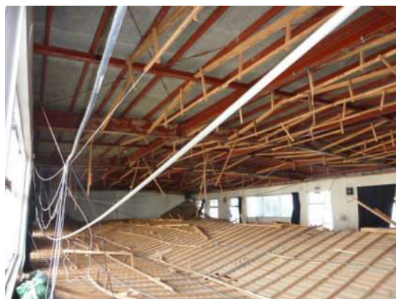
写真 5.3-42 天井材脱落 (MIT-5)
