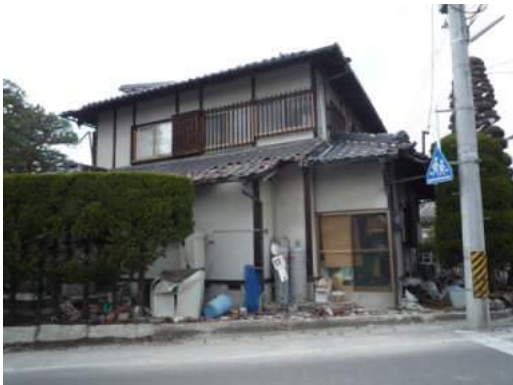
写真 5.2.6-15 屋根瓦の被害
