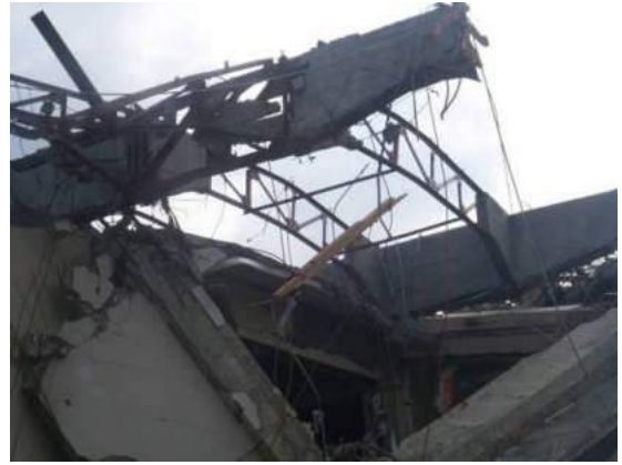
写真6 屋根の倒壊状況
