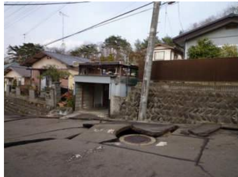
写真 5.2.5-4 道路の路面破壊 (青葉区折立 5 丁目)
