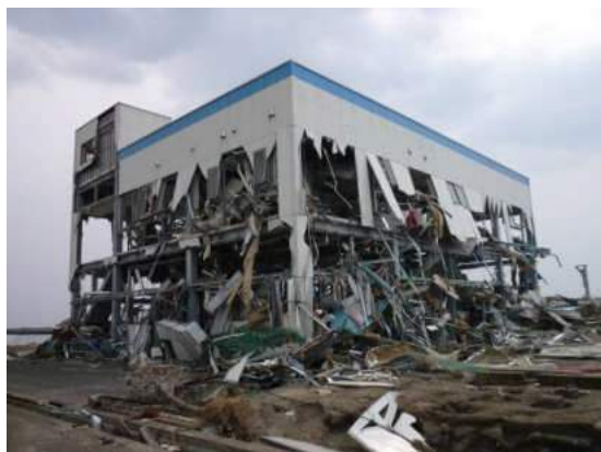
写真3 2階天井より下の外装材が流失
