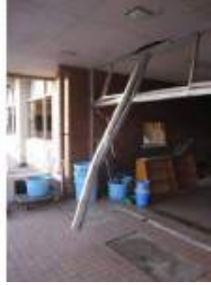
写真 6. 3. 13-3 玄関開口部のアルミフレームの面外変形
