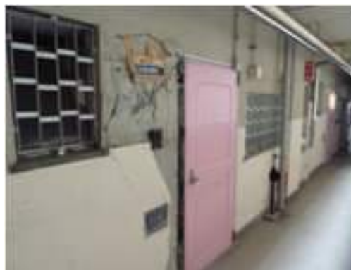
写真 5.4-15 非構造壁のせん断破壊
