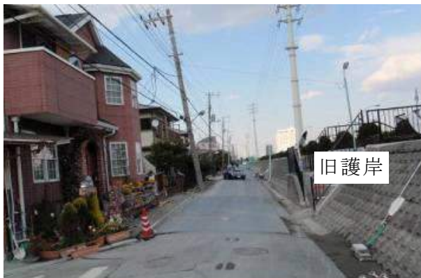
写真 5.5.2.2-11 右側に傾斜した道路
