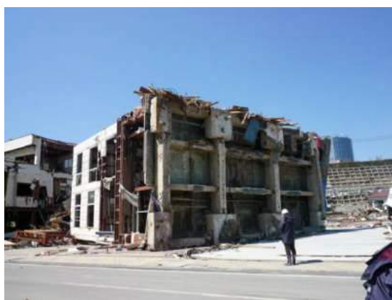
写真 1 転倒建物全景
