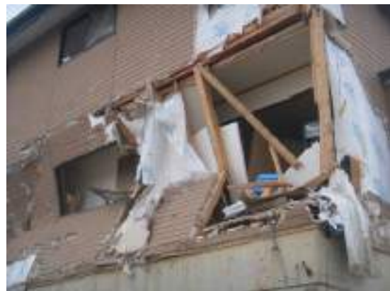
写真 6. 3. 11-42 壁及び柱の破損
