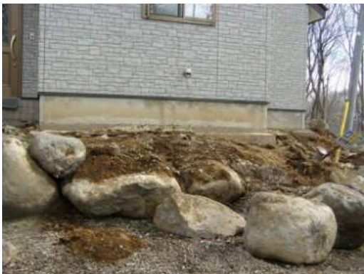
写真 5.2.7-7 外構の石の崩壊 (豊原乙地区)
