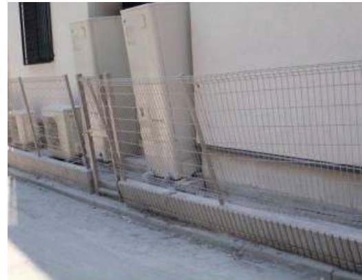
写真 5.5.2.2-2 変形したフェンス
