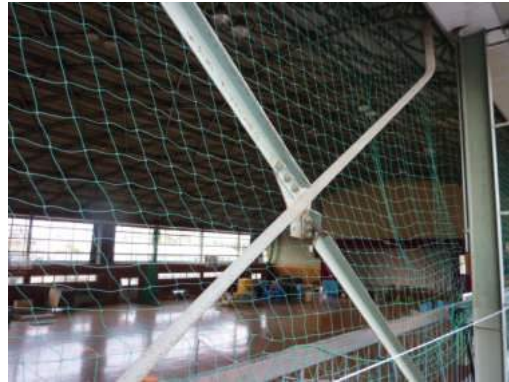
(b) 座屈と接合部の破断
