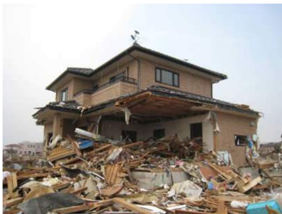
写真3 1階の一部が損壊
