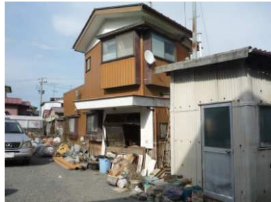
写真 5.2.4-8 大きく傾斜した木造住宅
