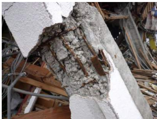
写真4 コンクリートのジャンカと鉄筋腐食
