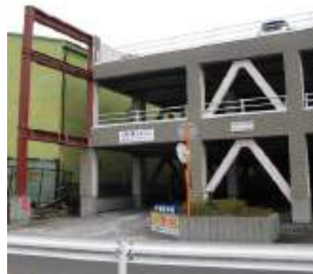
写真 5. 6-9 ALC パネルの脱落被害
