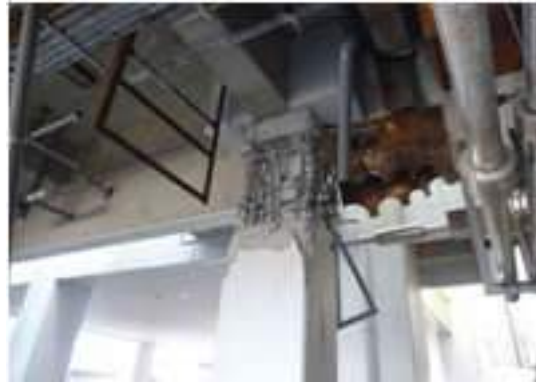
写真 5.4-60 柱頭での曲げ破壊
