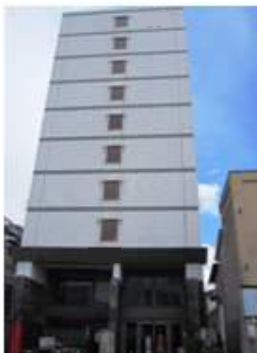
写真 5.4-135 建築物外観 1 (3階壁にせん断ひび割れ)
