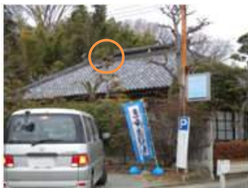
写真 5.4-184 瓦屋根の被害
