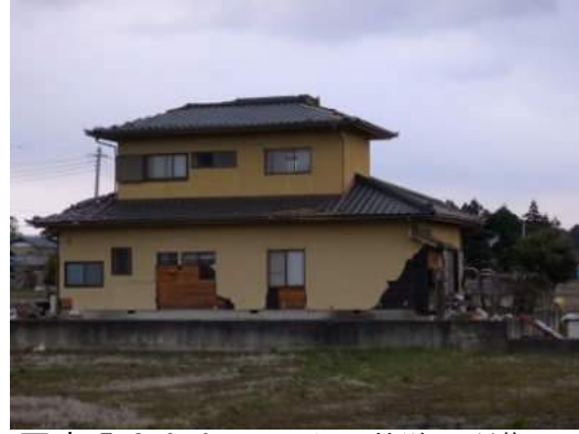
写真 5.2.9-4 モルタル外壁の剥落
