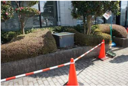
写真 5.2.7-1 那須町震度計設置状況
