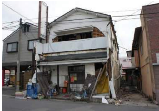
写真 5.2.6-4 大きく損壊した店舗併用住宅
