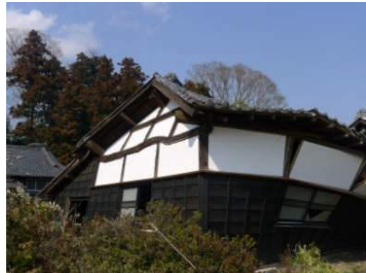
写真 5.2.10-2 大きく傾斜した納屋 (那珂市門部)
