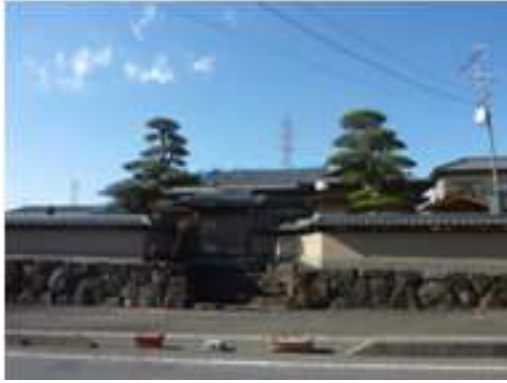
写真 5.4-210 木造住宅の瓦の被害
