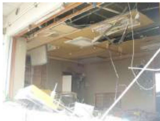
写真 6. 3. 11-34 1F 天井仕上げ材の破損
