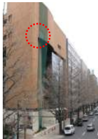
写真 5.6-2 外壁タイルの脱落被害
