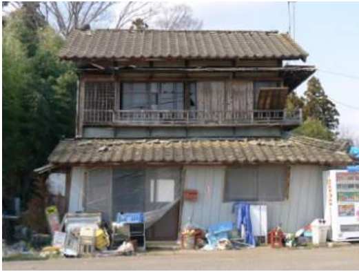
写真 5.2.10-3 店舗併用住宅の被害 (那珂市門部)
