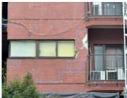
写真 5.4-17 短スパンの間柱のせん断破壊
