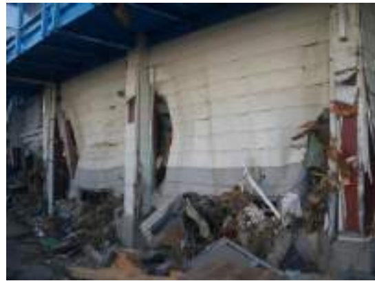
写真 6. 3. 10-18 外壁材の面外変形
