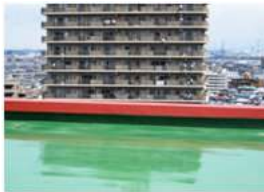
写真 5.4-54 屋上床の傾斜 (パラペットの天端が遠方建築物の床の水平ラインから傾いている)
