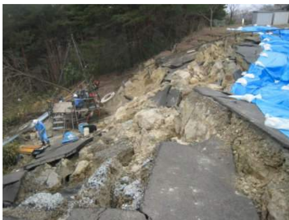
写真 5.5.2.3-37 高台の端部斜面①の地すべり(ボーリング調査が行われている)
