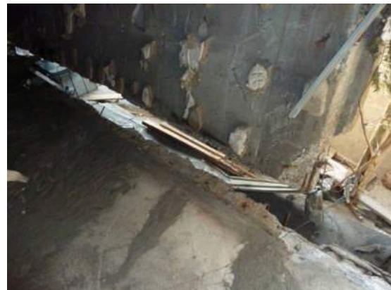
写真 4 主筋が破断した壁脚部
