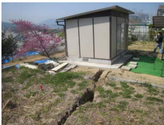
写真 5.5.2.3-29 緑ヶ丘1丁目の斜面地①および頂部に生じた地割れ（一部ブルーシート掛け）
