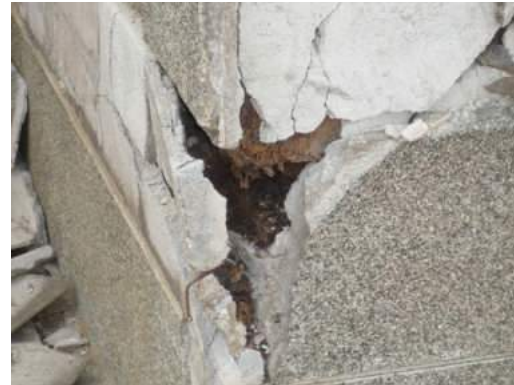
写真5.2.7-4 写真5.2.7-3柱脚部の生物劣化
