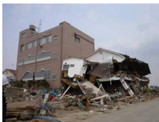
写真2 隣の建物が倒れ掛かっている
