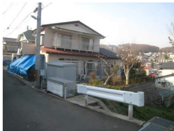
写真 5.5.2.3-10 宅地盛土の滑动・地盤変状による住宅の変形（青山2丁目付近）
