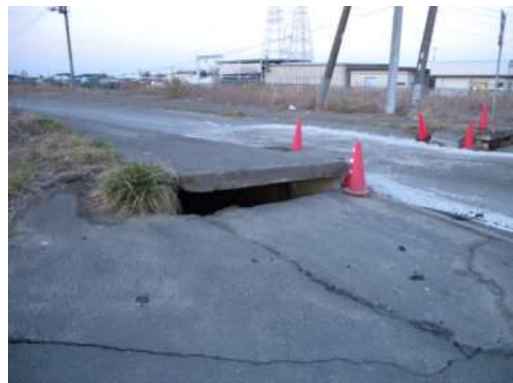
写真 5.5.2.1-42 周辺歩道部分の被害(段差約40cm)
