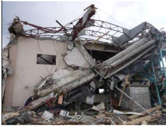
写真5 ホール側の被害状況
