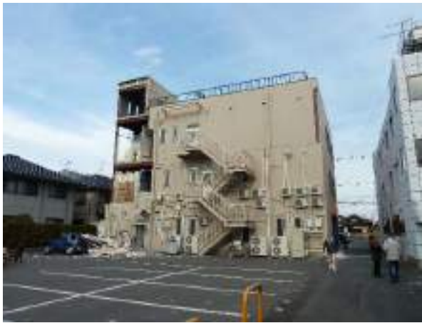
写真 5.6-18 ALC パネル外壁の脱落被害
