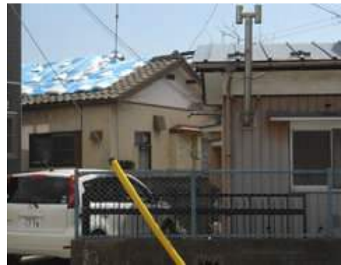
写真 5. 2. 4-2 日和が丘 屋根の被害
