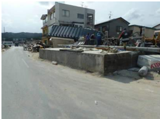
写真4 移動した水門
