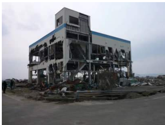
写真2 外装材の被害
