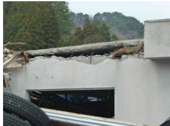
写真2 損傷した屋根部分
