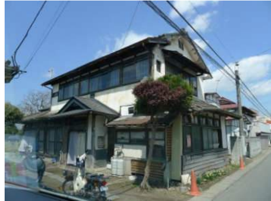
写真 5.2.2-19 外壁が剥落し、傾斜した木造住宅
