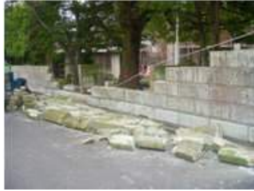
写真 5.4-73 知事公館の石塀の崩壊
