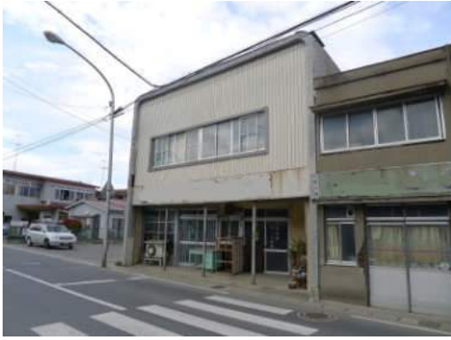
写真 5.2.4-5 傾斜した店舗併用木造住宅
