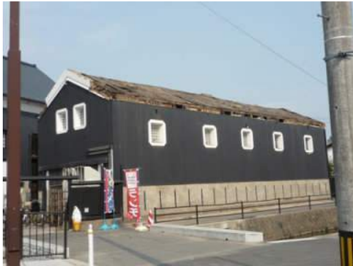
写真 5.2.2-2 屋根が崩落した土蔵
