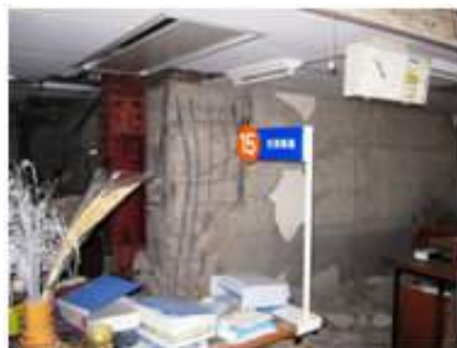
写真 5.4-121 耐震壁側柱の主筋の座屈
