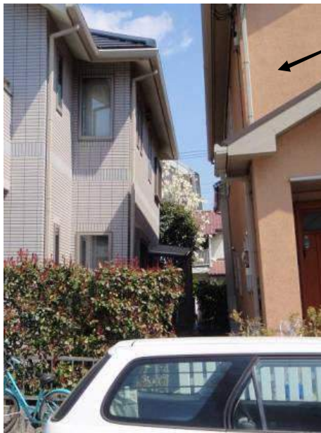
写真 5.5.2.2-5 沈下・傾斜した住宅
