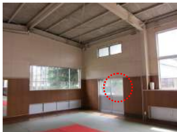
写真 5.6-57 両開きドアのガラスの被害
