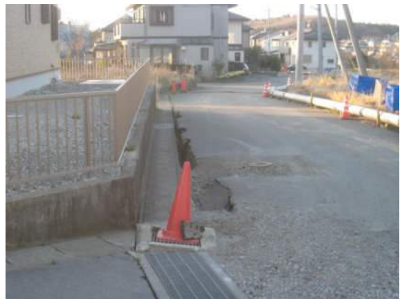
写真 5.5.2.3-56 地割れの痕跡
