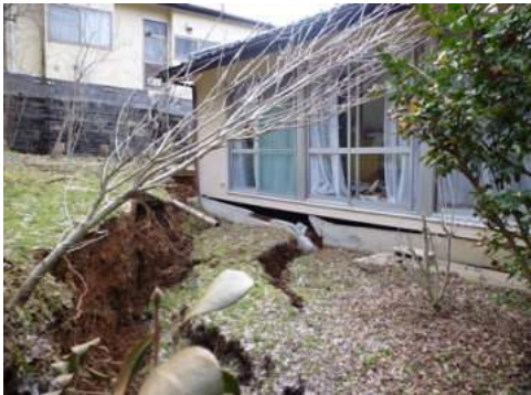
写真 5.2.5-3 写真 5.2.5-4 の住宅、 基礎が 90 cm 程度沈下 (青葉区折立 5 丁目)
