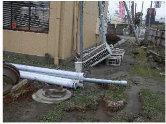
写真 5.5.2.1-16 写真 5.5.2.1-15 の周囲の変状 (右側が県道 11 号)
