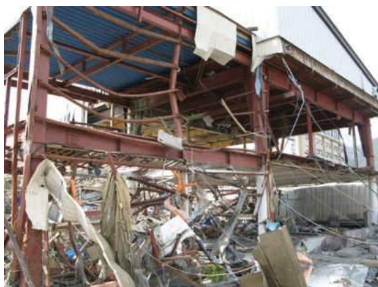
写真 4 座屈した耐震二次要素
