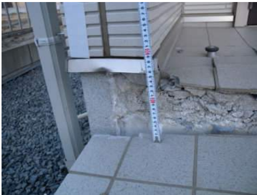
写真 5.5.2.1-41 建築物入口付近の段差
