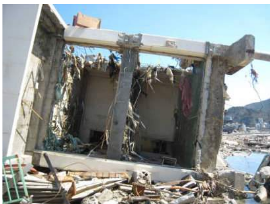
写真3 建物正面(有開口外壁の破壊)
