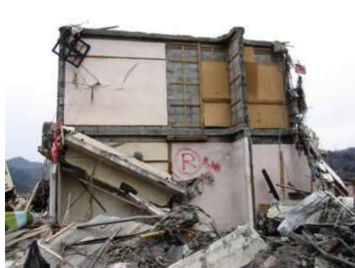
写真5 損壊した住戸の部分
