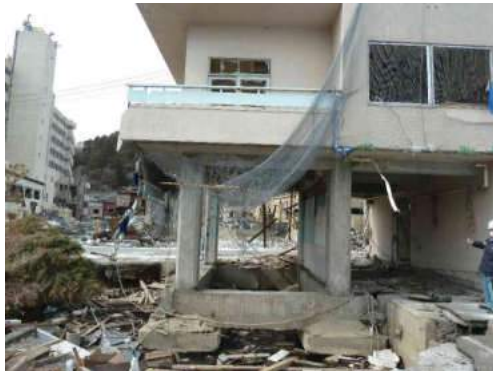
写真 6.4.1-9 洗掘による基礎露出
