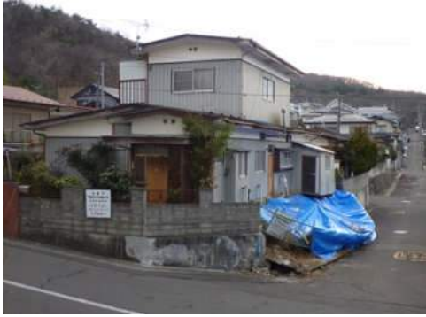
写真 5.2.5-1 擁壁破壊と住宅被害 (青葉区折立 6 丁目)
