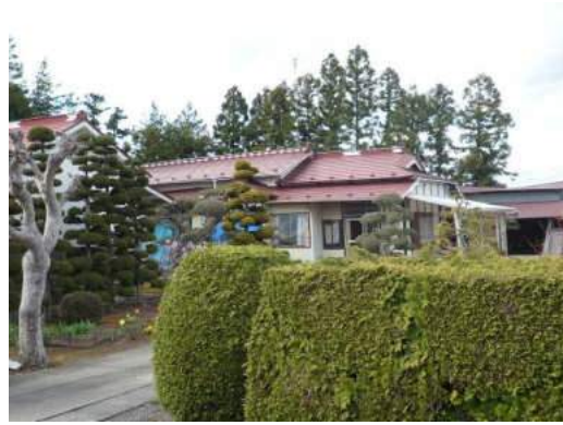
写真 5.2.3-6 残留変形が認められる住宅
