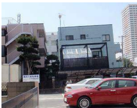
写真 5.5.2.2-15 沈下・傾斜した建物
