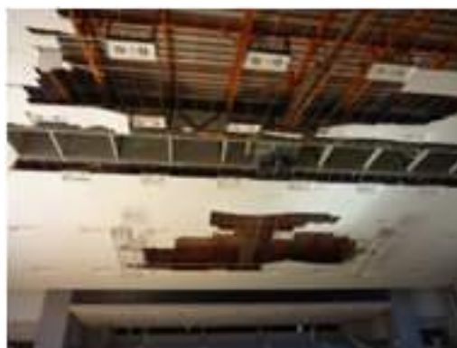
写真 5.4-209 脱落部分の拡大2
