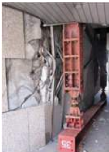
写真 5.4-140 1階柱のせん断破壊
