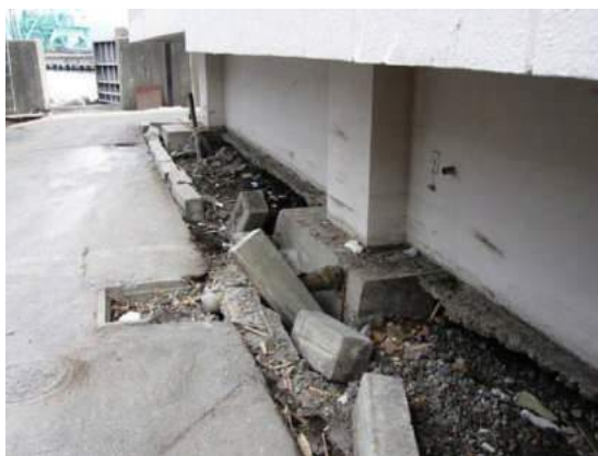
写真3 洗掘された基礎
