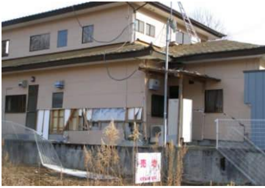
写真 5.2.7-17 残留変形が大きい家屋 (西大久保地区)
