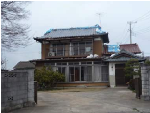
写真 5.2.12-3 常総市上蛇町の屋根瓦の被害
