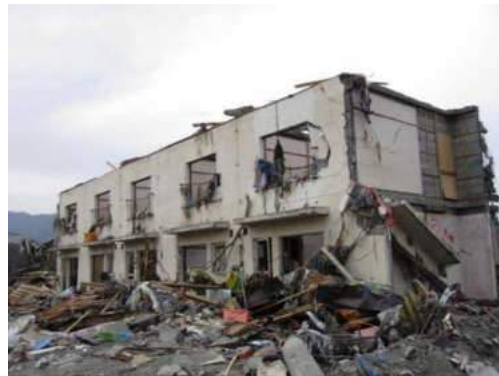
写真4 一住戸分が損壊した住棟
