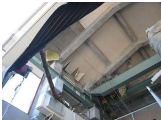
写真 4 天井材の剥落
