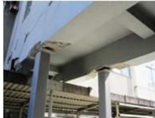
写真 5.4-126 渡り廊下の損傷
