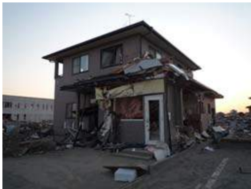
写真 6. 3. 11-5 津波作用方向から見て残存建物の反対側で流失を免れた木造店舗併用住宅 (④)
