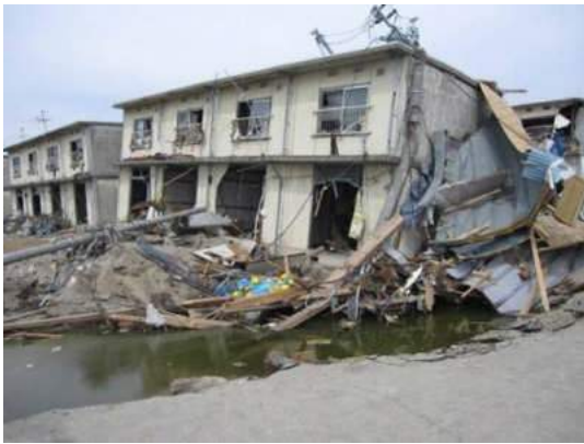
写真1 周辺地盤の洗掘による建物傾斜
