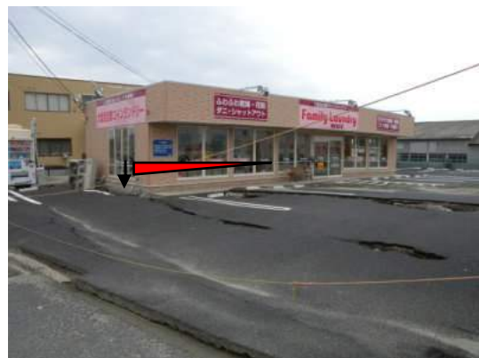
写真 5.5.2.1-14 片側が不同沈下した建築物(同)
