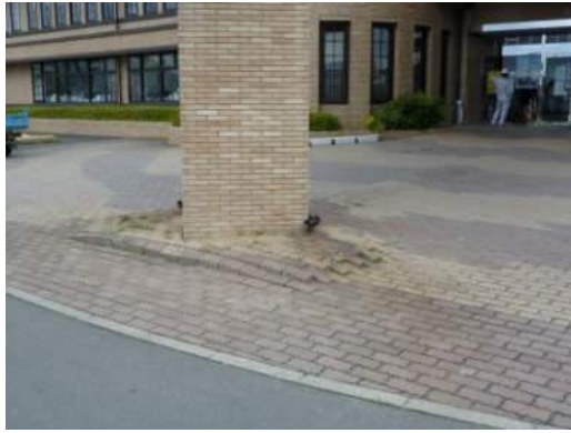
写真 5.2.3-11 南郷支所の地盤変状
