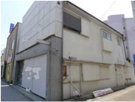
写真 5.2.2-31 く の字に変形した店舗併用住宅
