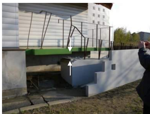
写真 5.5.2.1-35 スロープ部の段差
