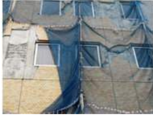
写真 5.4-4 RC 造柱及び非構造壁の損傷
