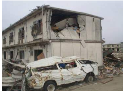
写真 6.4.1-14 漂流物の衝突による壁脱落
