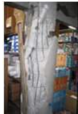
写真 5.4-44 長柱のせん断破壊
