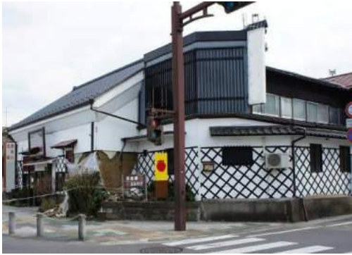
写真 5.2.6-1 土蔵を利用した店舗の被害
