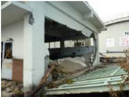
写真 6. 3. 10-46 センター内での非構造壁脱落
