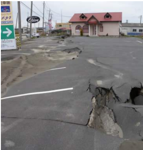
写真 5.5.2.1-13 駐車場路面の変状 (左側が県道 11 号)
