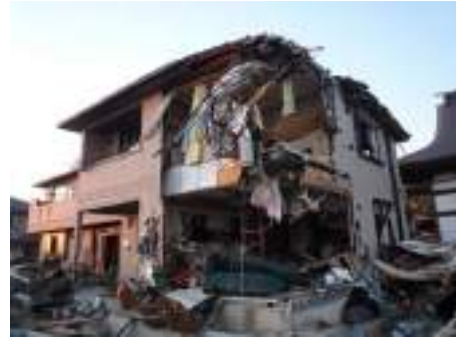
写真 6. 3. 11-4 大きく損傷したものの残存した鉄骨造住宅 (③)
