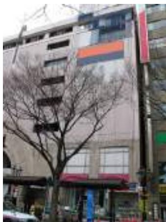
写真 5. 6-8 ALC パネルの脱落被害
