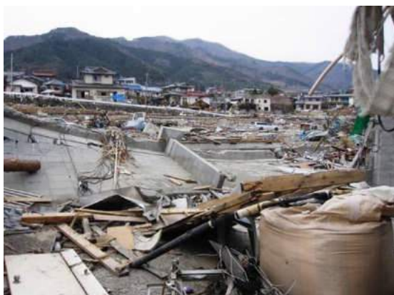
写真3 転倒したコンクリートブロック壁(1)
