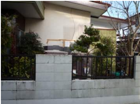
写真 5.2.5-7 モルタル外壁の損傷 （仙台市青葉区貝ヶ森）
