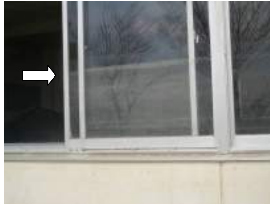
写真 6.3.11-51 1F 窓ガラスの浸水痕
