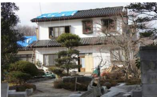
写真 5.2.7-15 住宅の外壁の剥落 (西大久保地区)
