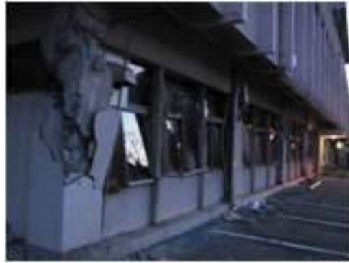
写真 5.4-202 外柱のせん断破壊
