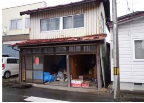
写真 5.2.1-6 町屋形式の住宅の被害
