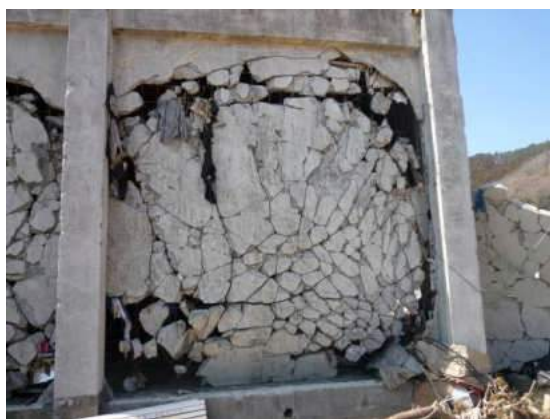
写真3 RC造壁の面外破壊
