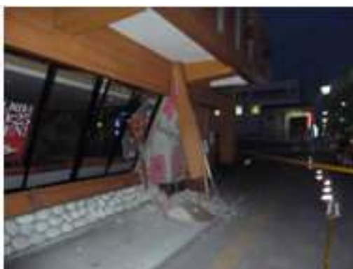
写真 5.4-105 1階柱のせん断破壊
