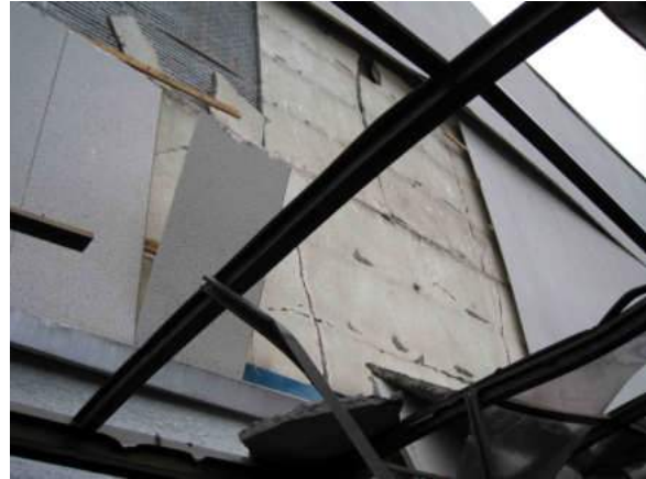
写真 5.3-47 外装仕上げの落下 (MIT-12)
