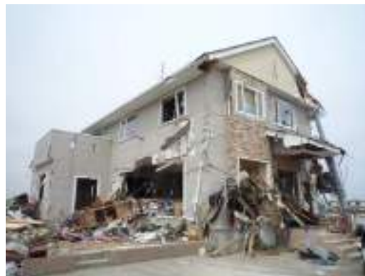
写真 6.3.11-13 単独で残存する枠組壁工法 (⑩) 住宅
