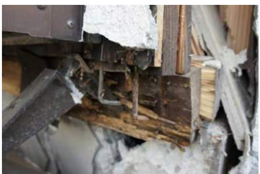
写真 5.2.7-24 写真 5.2.7-23 の柱脚接合部 及び生物劣化
