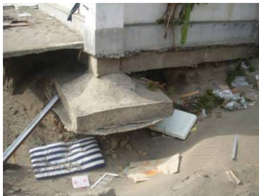
写真3 周辺地盤の洗掘
