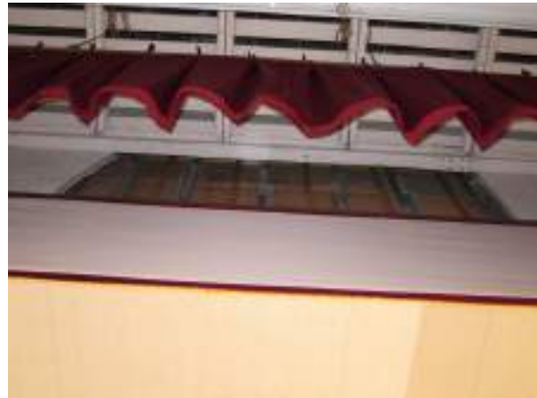
写真 5. 6-51 舞台上部の内壁の脱落被害
