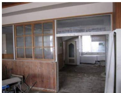
写真2 室内の浸水痕
