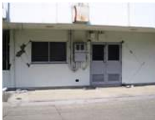
写真 5.4-144 袖壁付き短柱のせん断破壊 及び非構造壁のせん断ひび割れ
