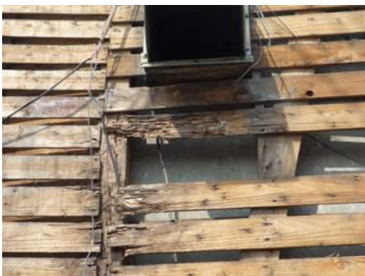
写真 5.2.2-5 写真 5.2.2-4 の南側における生物劣化
