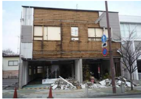
写真 5.2.6-2 ほぼ全面に渡り外壁モルタルが剥落した店舗併用住宅
