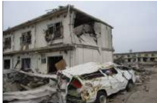
写真 6.3.11-26 2階妻壁の損傷
