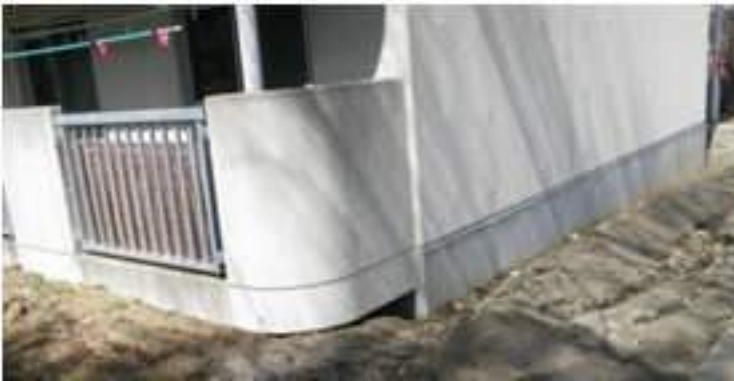
写真 5.4-165 a 棟 (沈み込みの大きい妻面)
