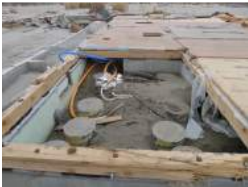
写真 6. 3. 14-7 流失した木造住宅の 地盤改良の痕跡 (⑦)
