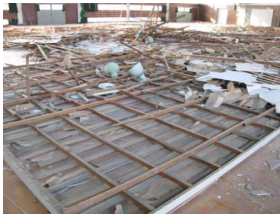
写真 5.3-41 落下した天井と照明 (HTC-4)
