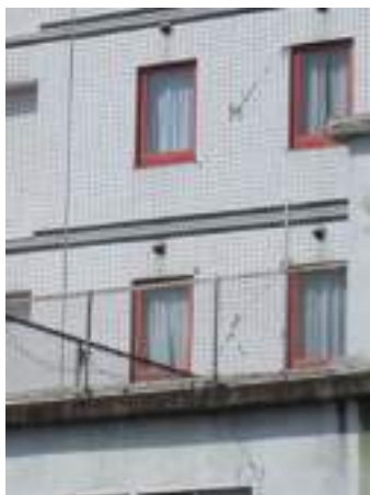
写真 5.6-14 外壁タイルの脱落被害
