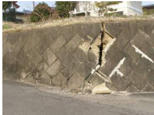
写真 5.2.8-6 擁壁のひび割れ
