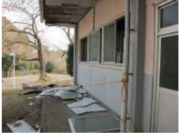
写真 5. 6-49 ラスモルタルによる軒天井の被害
