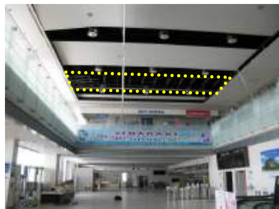
写真 5.6-66 出発ロビー（黄点線が脱落箇所）
