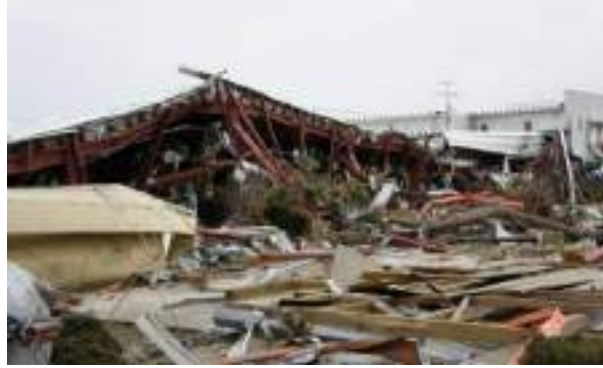
写真 6.3.11-23 写真 6.3.11-22 柱材が大きく変形 した低層棟部分
