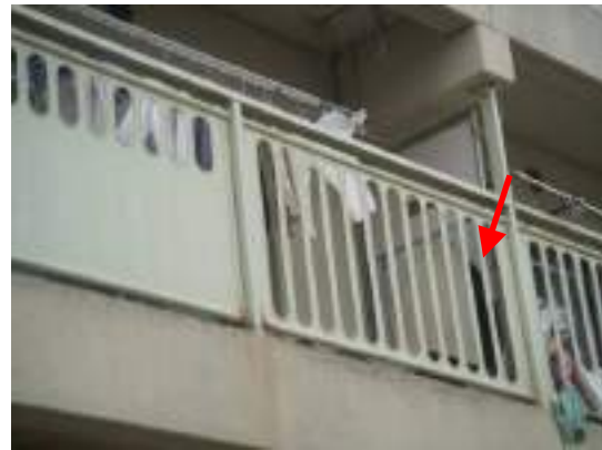
写真 6. 3. 11-32 住戸間の仕切りの破損状況 (2階)
