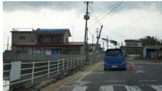
写真 5.2.6-26 傾倒した信号機
