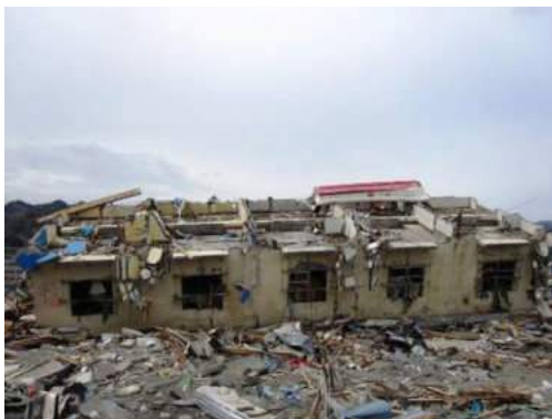
写真 12 移動し転倒した住棟 3 (1階部分は破損し流失している)
