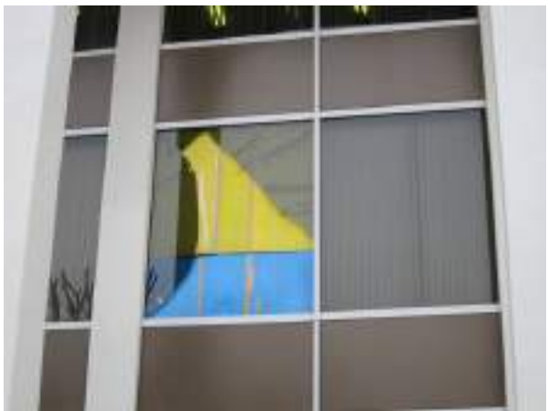
写真 5. 6-34 窓ガラスの被害
