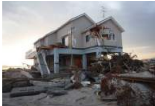
写真 6.3.13-6 残存する立面混構造建物 (②)
