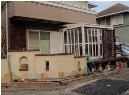
写真 5.5.2.2-9 バルコニー基礎部の被害
