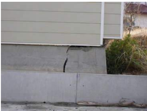
写真 5.2.8-9 住宅基礎の割れ
