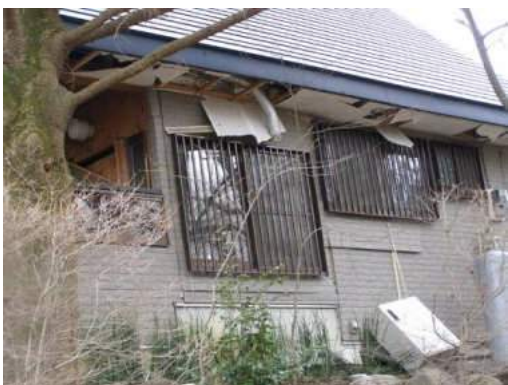
写真 5.2.7-13 軒裏天井の落下 (豊原乙地区)
