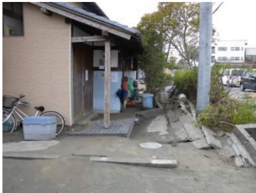
写真 5.5.2.1-29 住宅玄関付近の沈下
