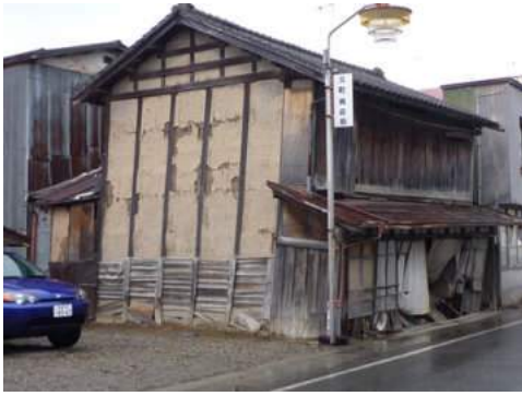
写真 5.2.1-5 町屋形式の住宅の被害
