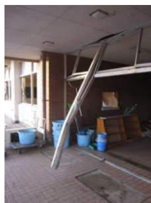
写真2 玄関開口部のアルミフレームの面外変形
