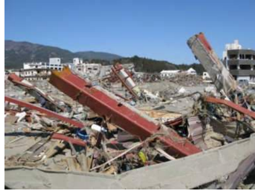
写真 6.4.2-4 1階柱の残存 (陸前高田市)
