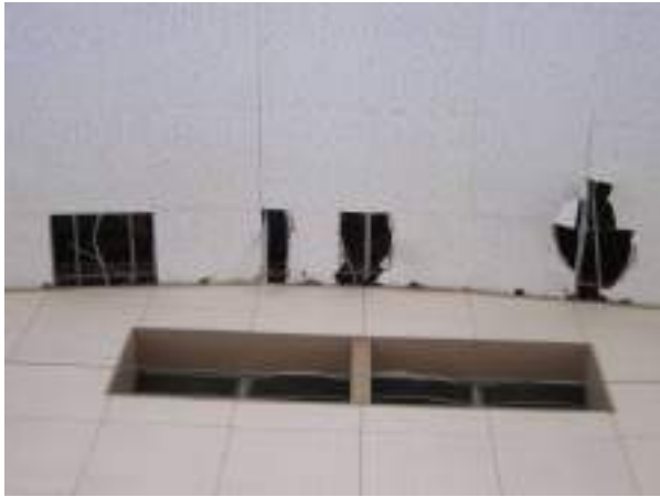
写真 5. 6-42 在来工法による天井の端部での被害
