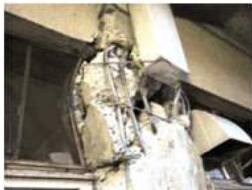
写真 5. 4-200 極短柱のせん断破壊
