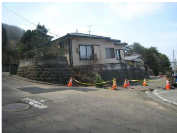
写真 5.5.2.3-7 宅地盛土の滑動・地盤変状により被災した住宅（全景）
