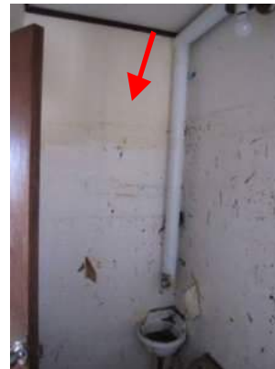
写真2 2階手洗いの浸水痕
