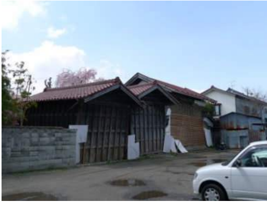
写真 5.2.2-25 傾斜した土蔵、倉庫
