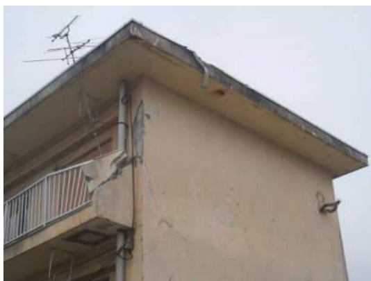
写真3 パラペットの破損
