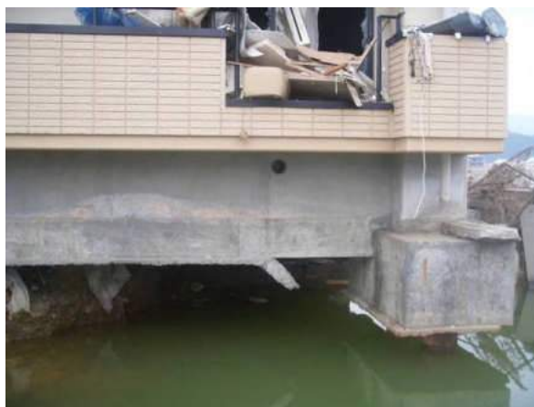
写真2 地盤の洗掘状況
