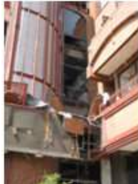
写真 5.4-174 外壁仕上げの落下
