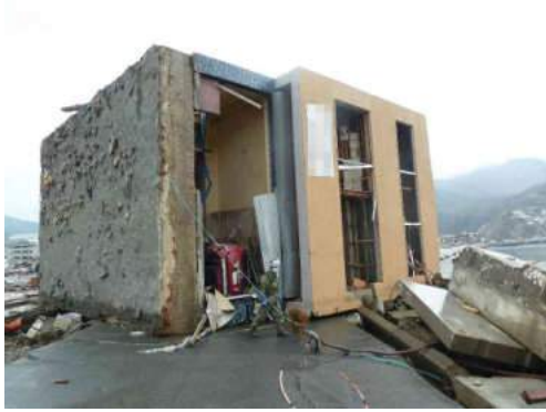
写真 6.4.1-3 3階建て建築物の転倒
