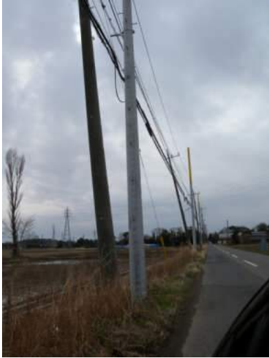
写真 5.5.2.1-1 電柱の傾斜（復旧中）
