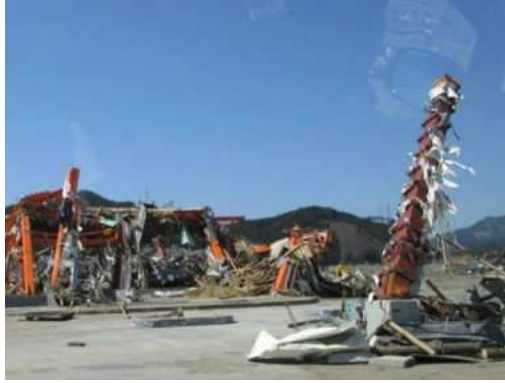
写真 6.4.2-3 根巻柱脚の1階柱の残存 (陸前高田市)
