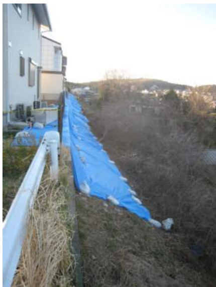
写真 5.5.2.3-51 宅地盛土の沼地側（紙面の右側）への滑動による地盤の変状と、それに伴う擁壁の被害（ブルーシート掛け）
