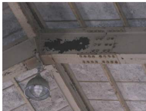
写真 5.3-39 梁ウェブの塗装の剥がれ (MIT-22)
