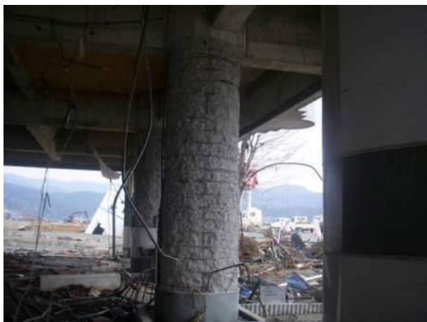
写真3 1階エントランスの被害状況
