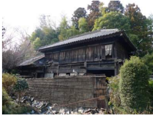
写真 5.2.10-4 下屋の被害 (那珂市門部)
