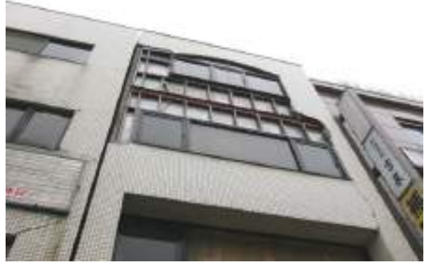
写真 5.6-29 ラスモルタル外壁の脱落被害
