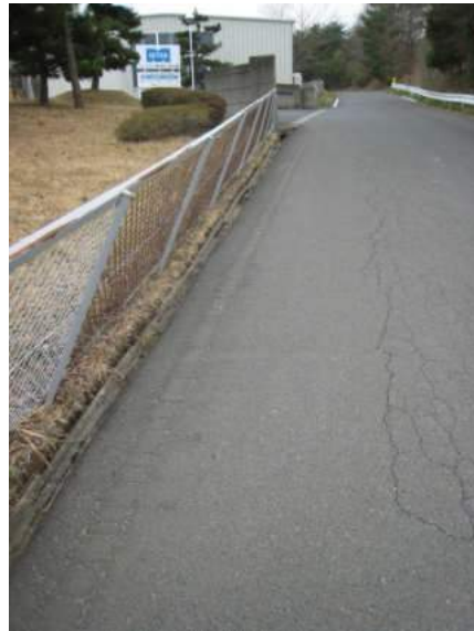
写真 5.5.2.3-42 地盤変状③により押し潰された道路の側溝
