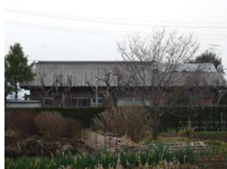
写真 5.2.13-2 屋根瓦の落下 (龍ヶ崎市高須町)
