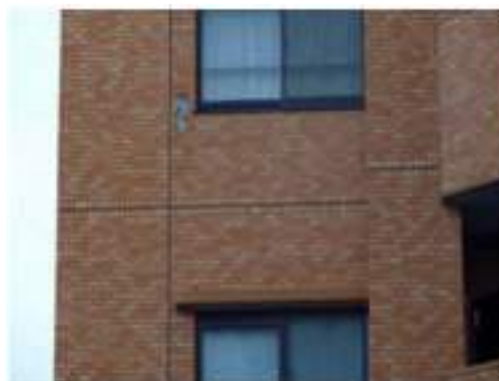
写真 5.4-103 非構造壁の損傷（ひび割れ）
