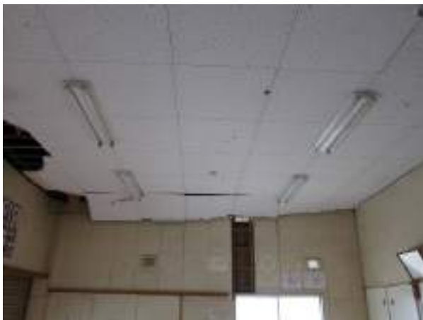
写真 5. 6-44 在来工法による天井の周辺部の被害
