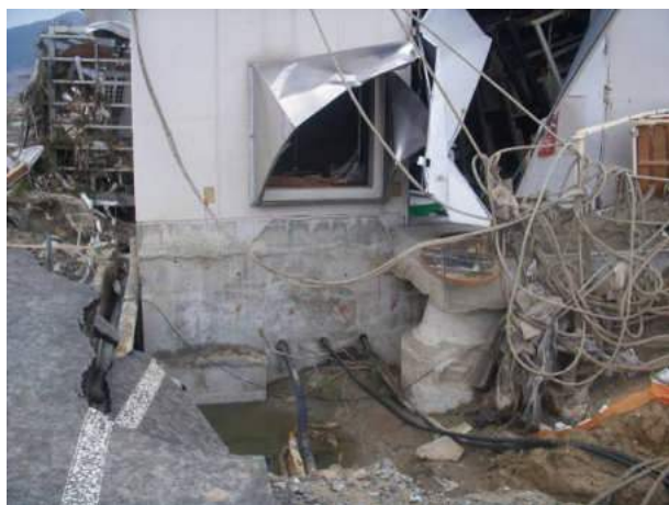
写真3 地盤の洗掘状況
