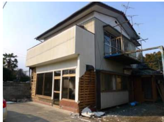
写真 5.2.10-6 モルタルの剥落 (那珂市瓜連)
