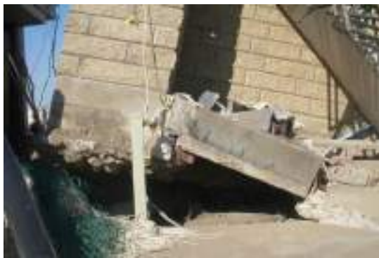
写真 6. 3. 10-11 写真 6. 3. 10-10 の地盤の洗掘状況
