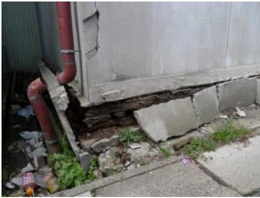
写真 5.2.2-27 写真 5.2.2-26 の剥落部の 土台の腐朽
