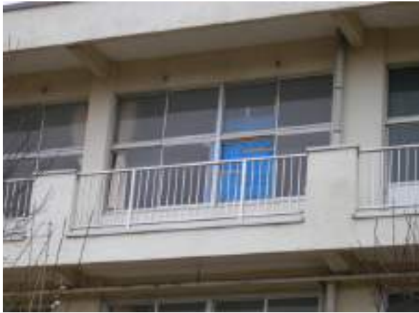
写真 5. 6-32 窓ガラスの被害
