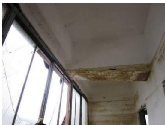
写真4 建物1階の浸水痕
