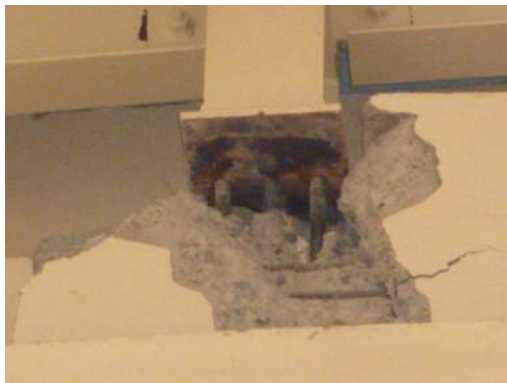
写真 5.3-19 コンクリートの剥落とアンカーボルトの曲げ (MIT-3)
