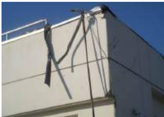
写真 6. 3. 10-13 写真 6. 3. 10-12 の 2 階手摺の破損
