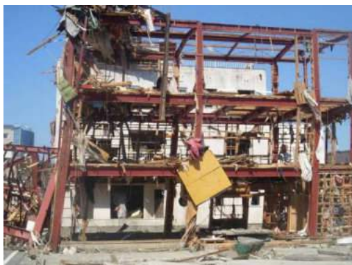
写真 6.4.2-12 傾斜した重層建築物（女川町）
