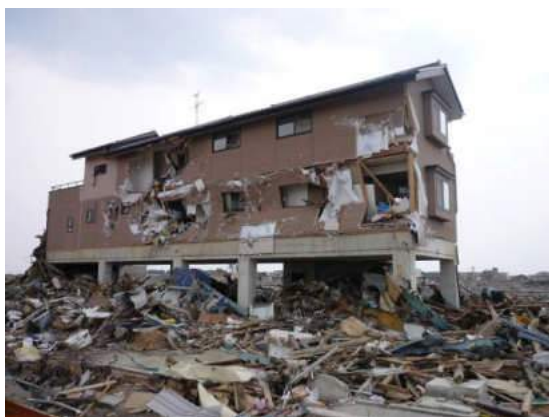
写真3 漂流物の衝突による被害
