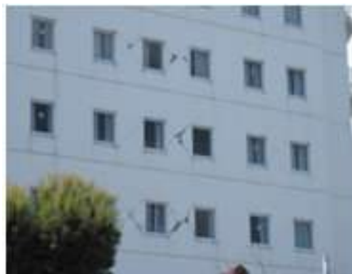
写真 5.4-134 非構造壁のせん断ひび割れ
