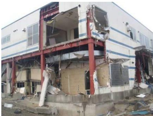
写真3 ALCパネルの脱落
