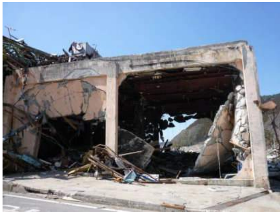
写真3 壁の破壊・脱落 (建物東面)
