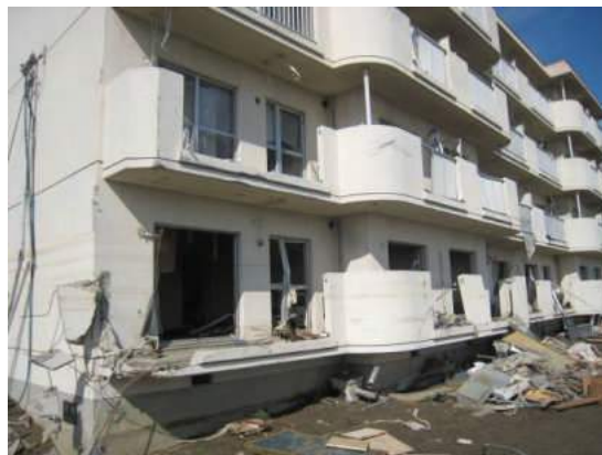
写真3 窓ガラスの破損
