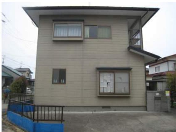
写真 5.5.2.3-43 高台平地部の住宅の被害（障子の破れ）
