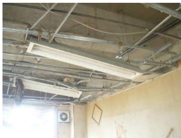
写真3 1階天井仕上げ材の被害状況
