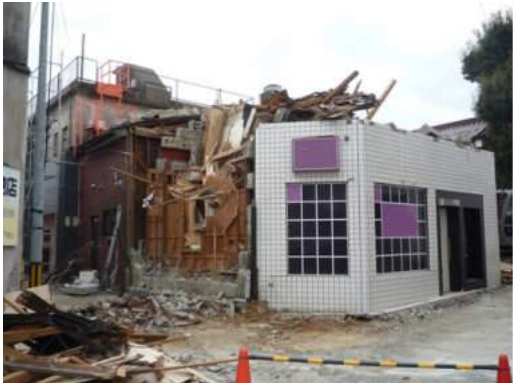
写真 5.2.6-13 大被害と推測される木造
