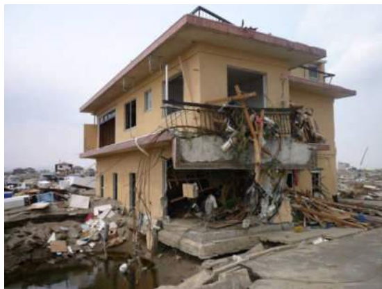
写真 2 1階妻壁の被害
