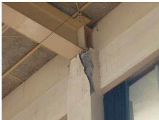
写真 5.3-21 仕上げモルタルの剥落 (MIT-25)
