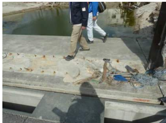
写真2 破断した壁筋
