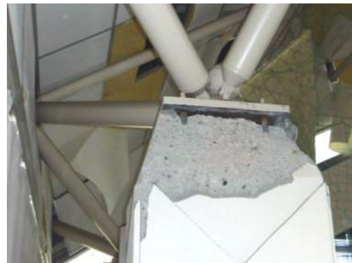
写真 5.3-20 コンクリートの剥落 (MIT-8)
