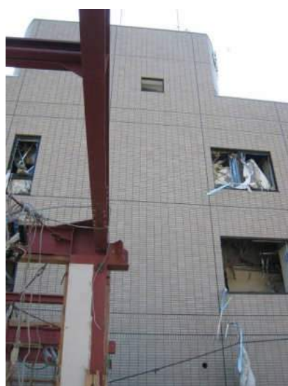
写真 4 ペントハウス天井に痕跡
