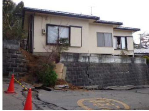
写真 5.2.5-2 擁壁破壊と住宅被害 (青葉区折立 5 丁目)
