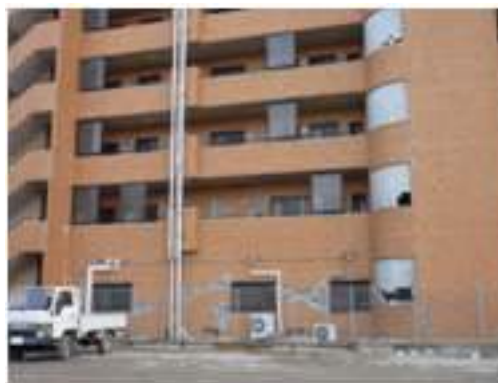
写真 5.4-94 非構造外壁の損傷
