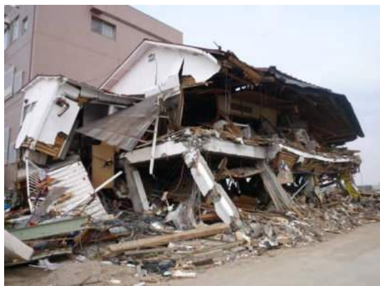
写真1 倒壊した混合構造建物
