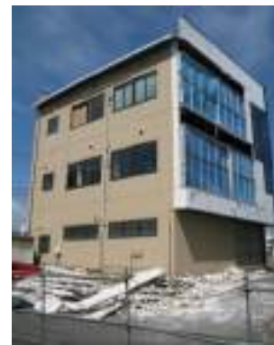
写真 5.3-10 ALCパネルの脱落 (白河市)
