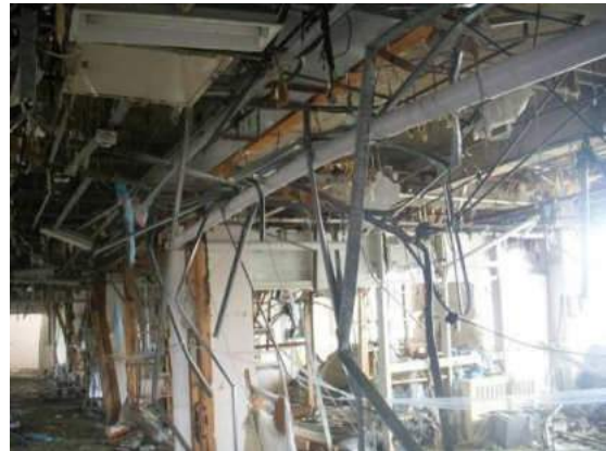
写真9 内部の被害状況（3階）
