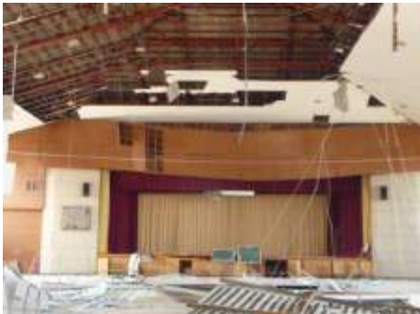
写真 5. 6-50 舞台上部の内壁での被害
