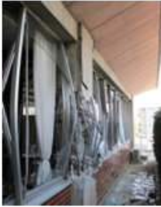
写真 5.4-122 1階柱のせん断破壊
