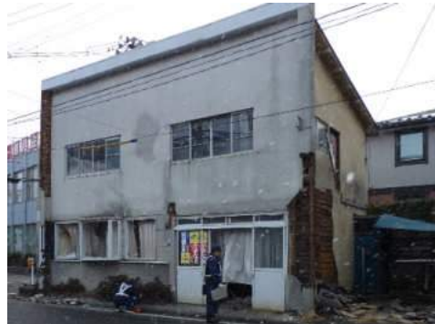
写真 5.2.5-8 モルタル外壁の剥落 （仙台市青葉区小松島）
