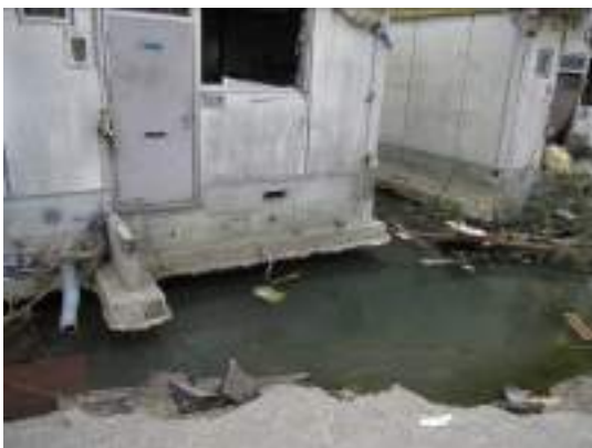
写真 6.3.11-27 周辺地盤の洗掘
