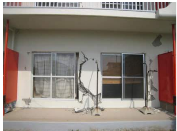
写真 5.5.2.3-28 建物 A の傾斜していない棟の 1 階における非構造壁の損傷
