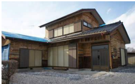
写真 5.2.7-14 住宅の外壁の剥落 (西大久保地区)
