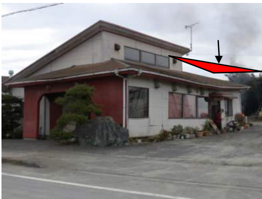
写真 5.5.2.1-17 中央が不同沈下した建築物 (手前側が県道 11 号)
