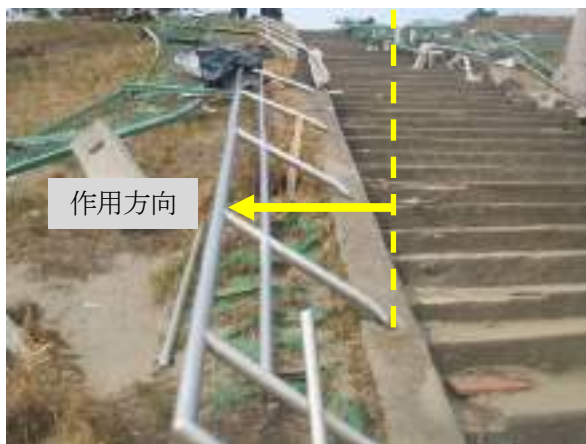
写真 6.2.1-2 手すりの津波による折損状況
