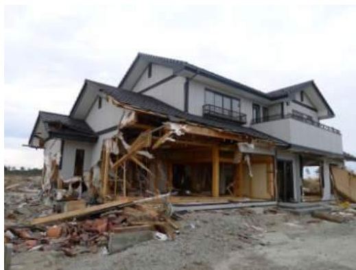
写真 6. 4. 3-6 建築物隅部を流失しつつも残存した事例(1)
