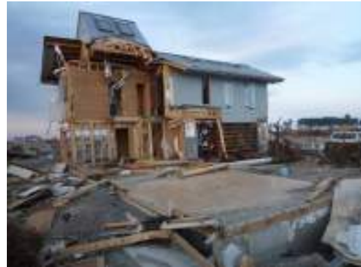
写真6.3.13-4 残存する木造住宅木造住宅
