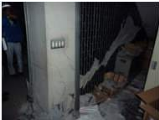
(a) 耐震壁のせん断破壊
