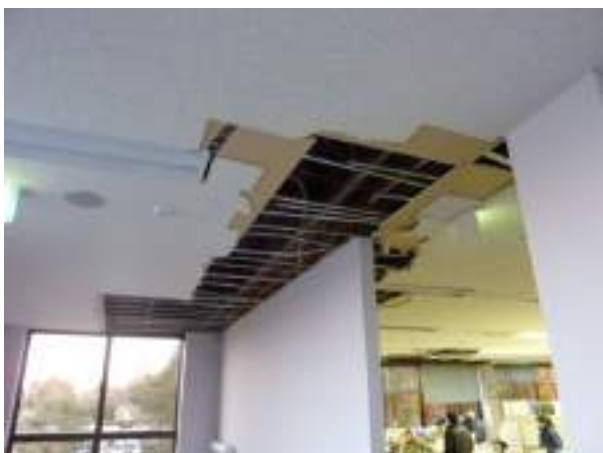
写真 5. 6-36 間仕切り上部での天井の被害
