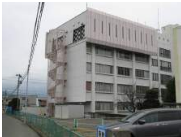
写真 5.6-21 ALC パネル外壁の脱落被害
