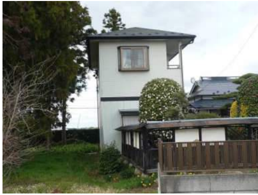
写真 5.2.3-5 2階増築と思われる建物の 残留変形
