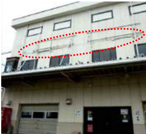
写真 5. 6-5 ALC パネルの損傷被害
