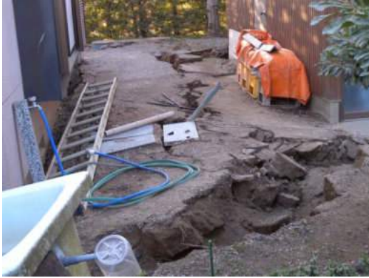
写真 5.5.2.1-37 敷地内の地割れ
