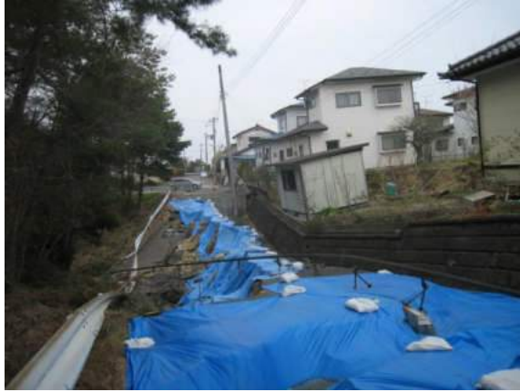
写真 5.5.2.3-39 高台の端部斜面①の地すべりによる盛土擁壁の破壊と住宅の傾斜
