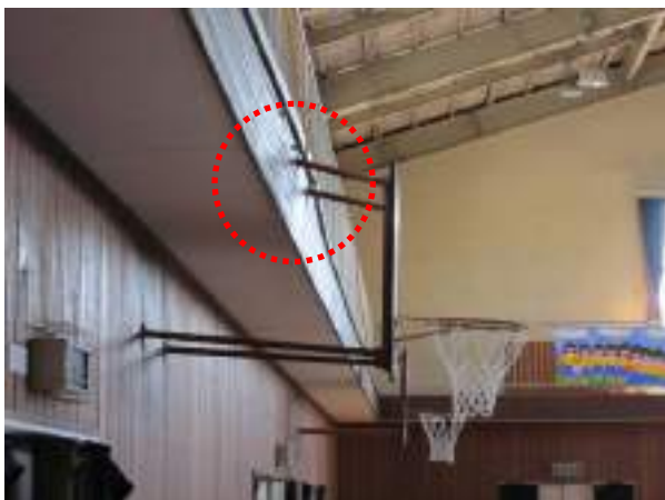
写真 5. 6-52 バスケットゴール周辺の内壁の被害
