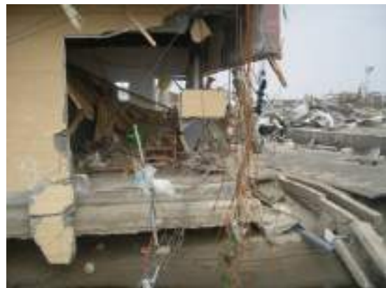
写真 6. 3. 11-49 周辺地盤の洗掘
