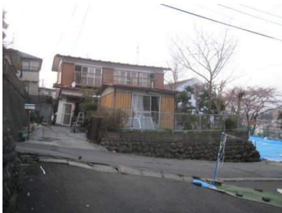
写真 5.5.2.3-15 宅地盛土の滑動・地盤変状による住宅の大変形
