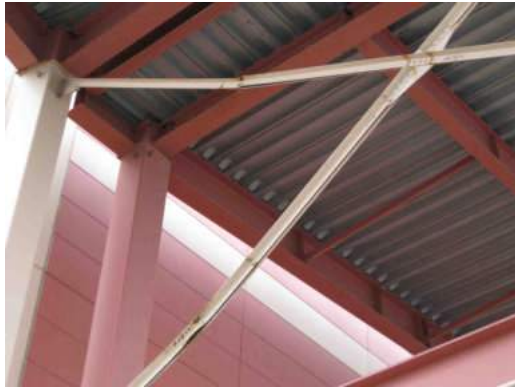
(a) ブレース（山形鋼ダブル）の座屈
