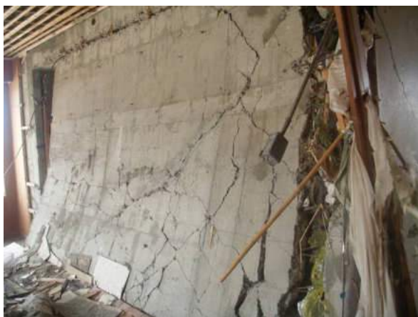
写真2 間仕切り壁の破壊
