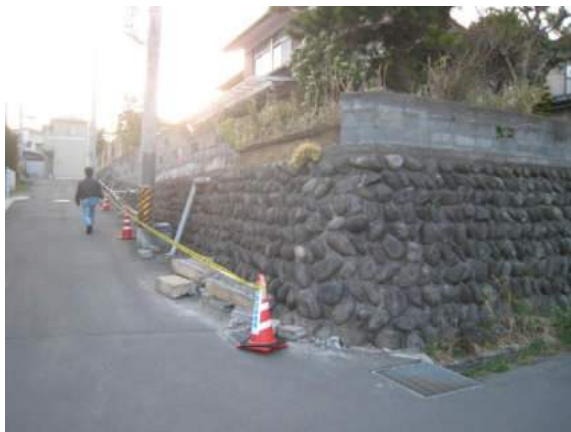
写真 5.5.2.3-19 擁壁の上部に設置された土留めブロック塀の剥落の痕跡
