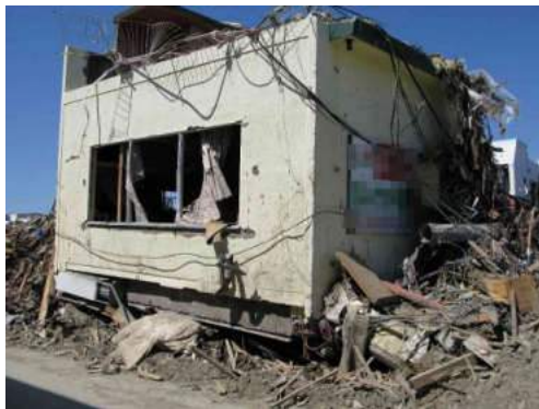
写真 6.4.1-1 2階建て建築物の層崩壊
