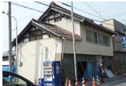
写真 5.2.2-12 残留変形が大きい店舗併用住宅
