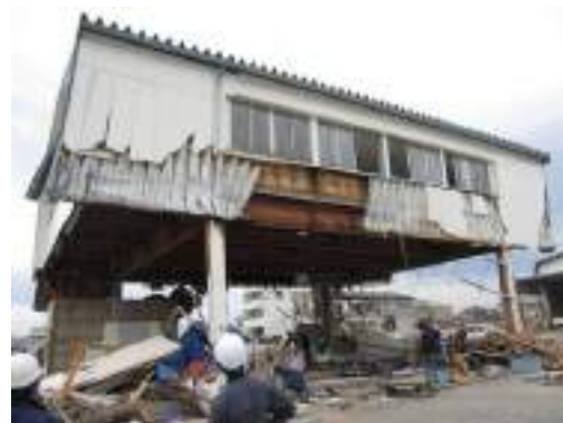
写真 6.3.13-36 2階外壁の破損状況
