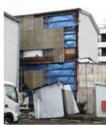
写真 5. 6-4 ラスモルタル外壁の脱落被害
