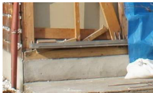
写真 5.2.7-16 写真 5.2.7-14 の柱脚、筋かい端部接合部
