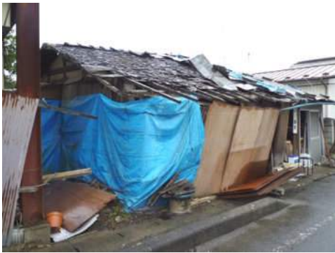
写真 5.2.1-9 老朽化した家屋の倒壊
