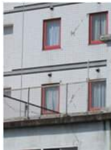
写真 5.4-137 非構造壁の せん断ひび割れ
