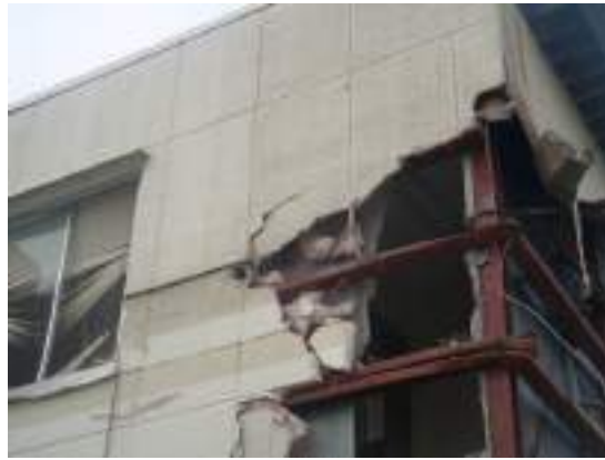
写真 6. 3. 11-36 外装材の流失
