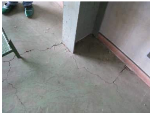
写真 5.3-31 柱脚部のひび割れ (HKT-1)
