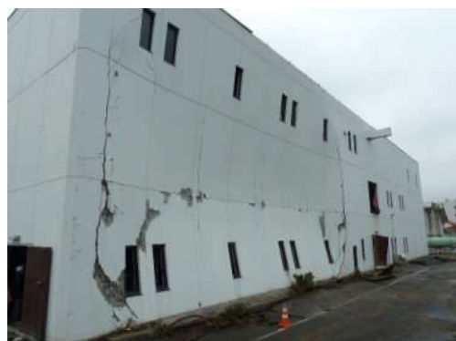
写真 6.4.1-12 床を持たない連層壁の面外破壊
