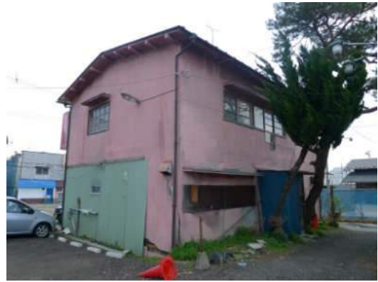
写真 5.2.2-28 傾斜した木造住宅
