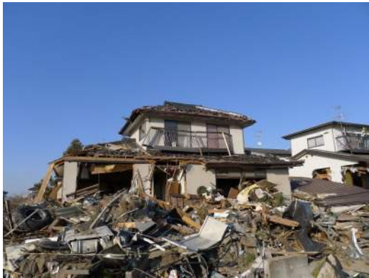
写真 6. 3. 10-29 1F の損傷の激しい木造 (14)
