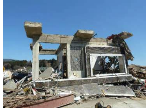
写真 6.4.1-4 上下逆さまになった2階建て建築物
