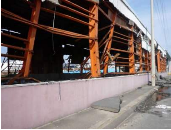
写真 5 柱の変形（倉庫 2）
