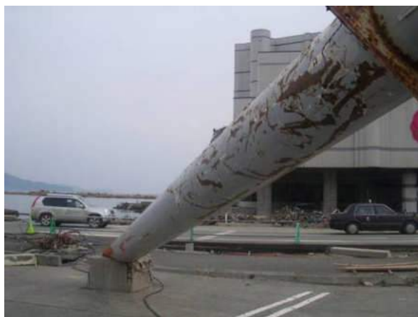
写真1 鋼製柱の折損状況
