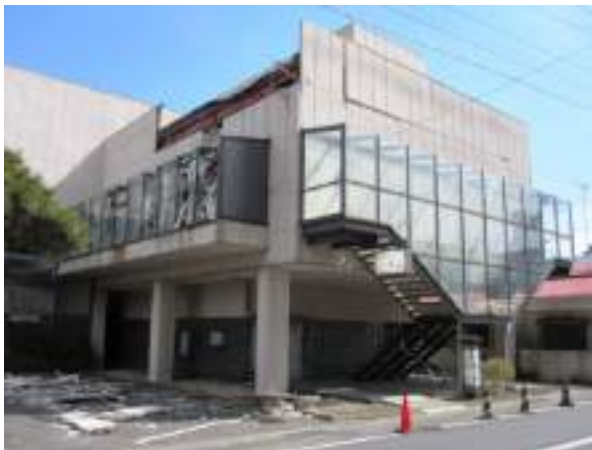
写真 5.6-20 ALC パネル外壁の脱落被害
