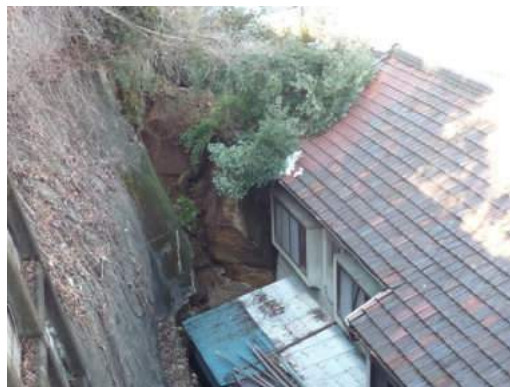
写真 5.2.5-13 崩壊した旅館の裏山
