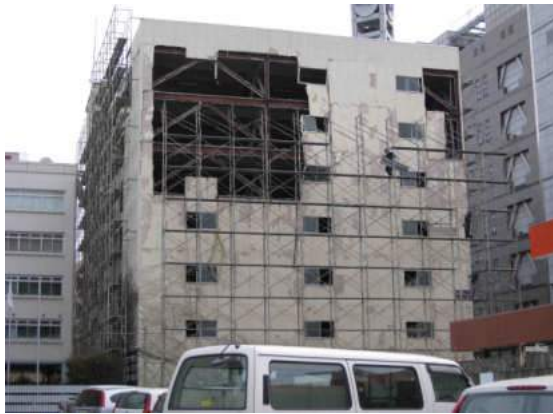
写真 5.3-11 駐車場の外装材の脱落（水戸市）
