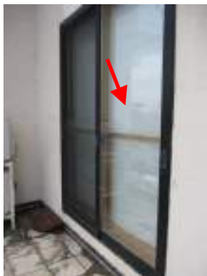
写真 6.3.13-33 2階窓ガラスの浸水痕
