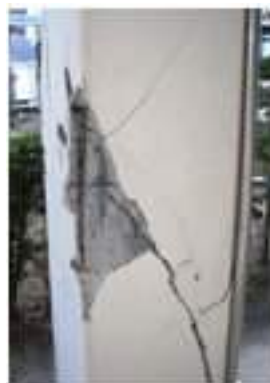
写真 5.4-35 1 階柱のせん断破壊
