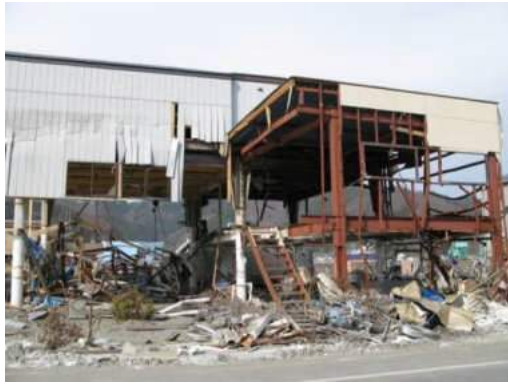
写真 6.4.2-18 残存するS造（釜石市）
