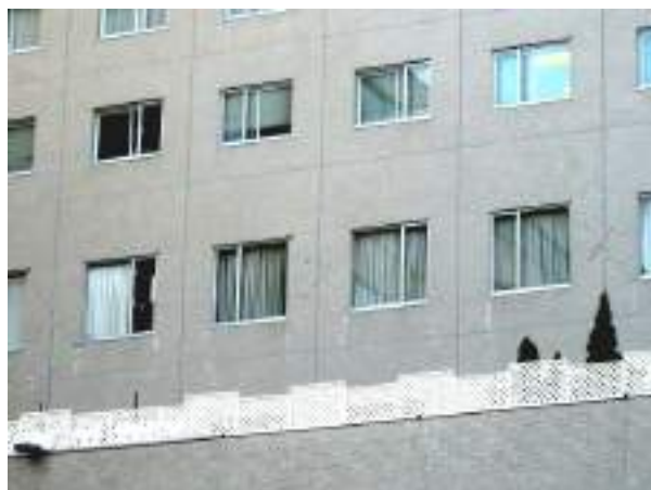
写真 5.6-26 外壁タイルの被害
