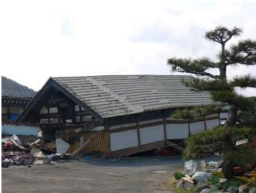
写真 5.2.10-1 倒壊した納屋 (那珂市門部)
