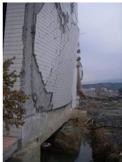
写真2 外壁の面外変形
