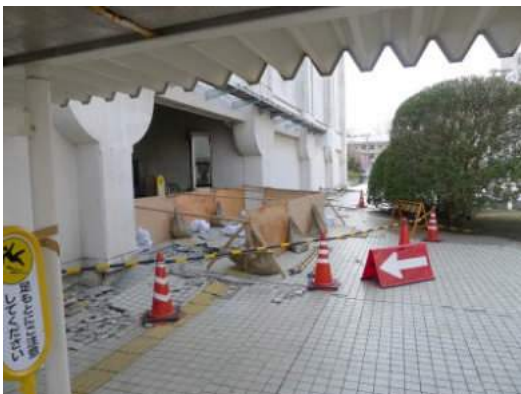
写真 5.2.11-1 市役所周辺の地盤変状
