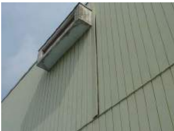
写真 5. 6-64 外壁の金属サイディングの外れ
