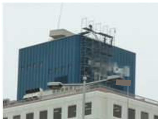
写真 5.4-12 ペントハウスの傾斜
