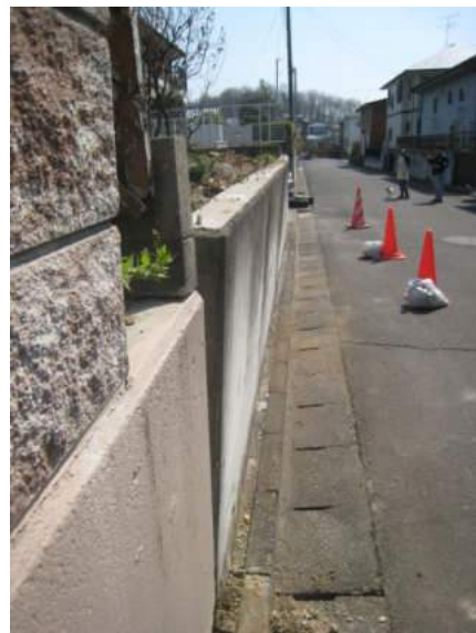
写真 5.5.2.3-36 写真 5.5.2.3-33 の住宅に隣接する盛土擁壁のはらみ出し
