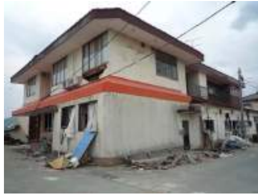
写真 6. 3. 13-22 残存した鉄骨造建築物 (14)
