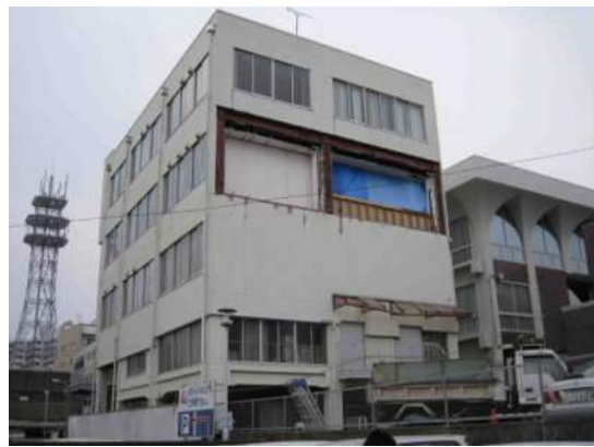
写真 5.3-12 事務所の外装材の脱落（水戸市）
