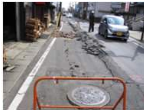
写真 5.4-154 道路の地盤変状
