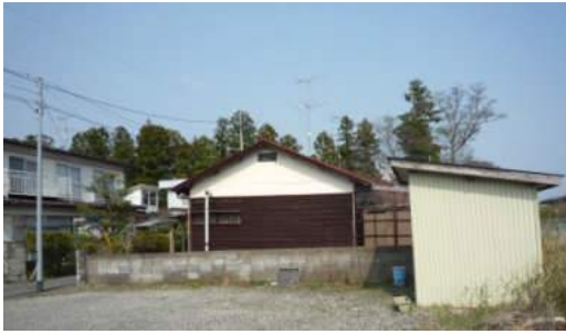
写真 5.2.2-15 大きく傾いた平屋建て住宅
