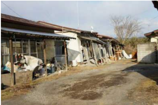
写真 5.2.7-19 地盤変状に伴う木造の 被害 (塩阿久津上地区)
