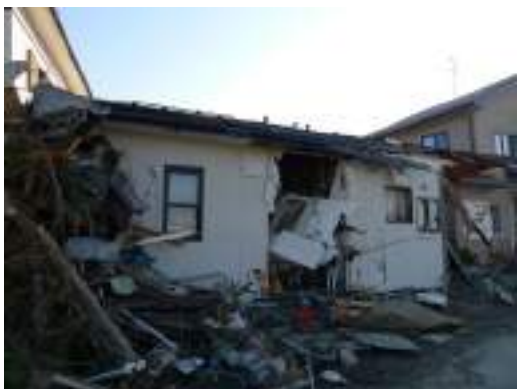
写真 6. 3. 10-33 損傷の激しい木造
