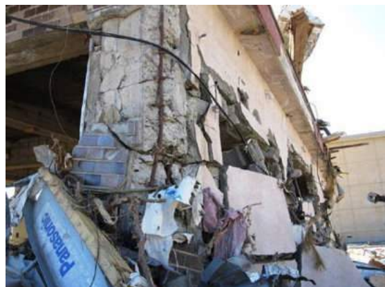
写真4 損傷したコンクリートブロック壁
