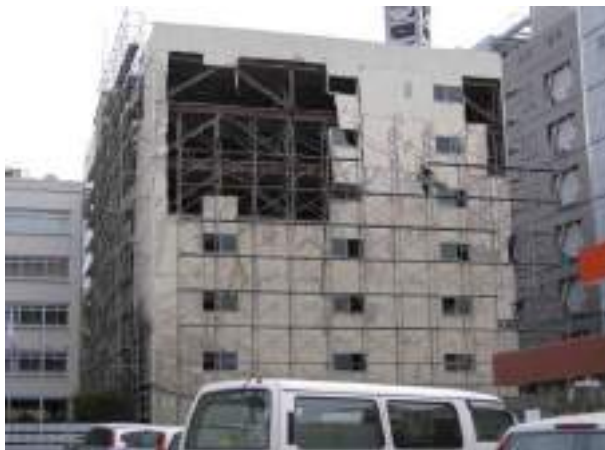
写真 5.6-31 ALC パネル外壁の被害
