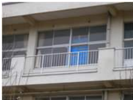
写真 5.4-179 ガラス窓の脱落 （写真 5.4-178 の○印内）
