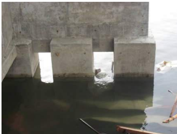
写真3 基礎周辺の洗掘の状況
