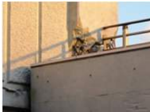
写真 5.4-29 高層棟 3F 側柱脚部の圧壊
