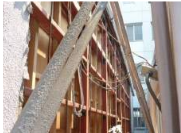
写真 5. 6-62 ラスモルタル外壁の被害
