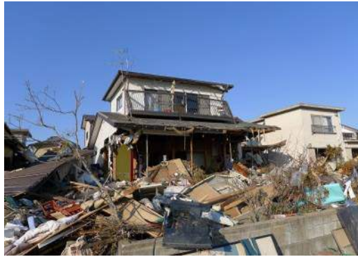
写真 6. 3. 10-28 1F の損傷の激しい木造
