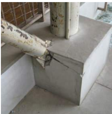
写真 5.3-32 ひび割れ (HKT-2)
