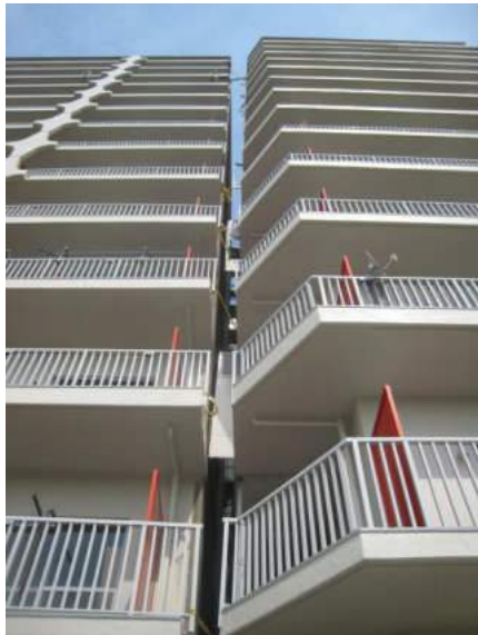
写真 5.5.2.3-25 建物 A の L 字型連結部に生じた隙間 (右側の棟が紙面右方向に傾斜)
