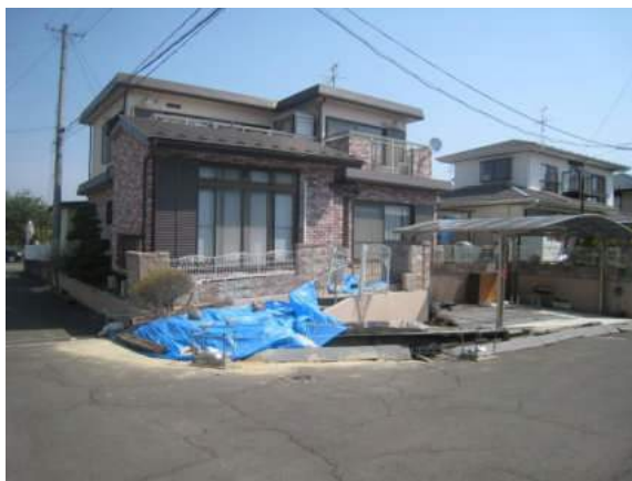
写真 5.5.2.3-33 丘陵地の頂部付近③で宅地盛土の変状により被災した住宅
