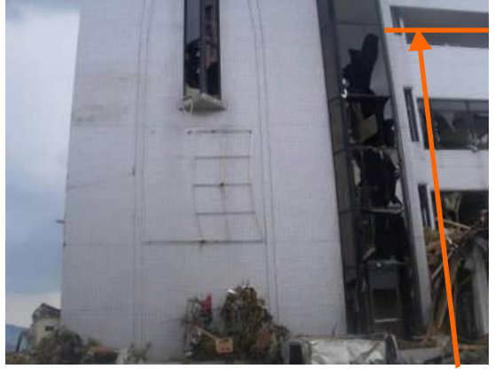
写真4 窓ガラスの破損状況からの浸水深の推定
