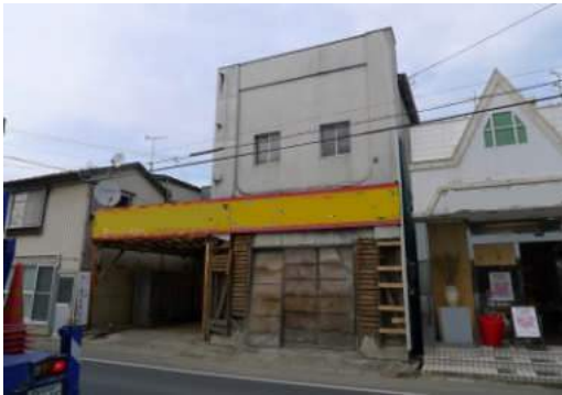
写真 5.2.4-7 外壁が剥落した店舗併用木造住宅
