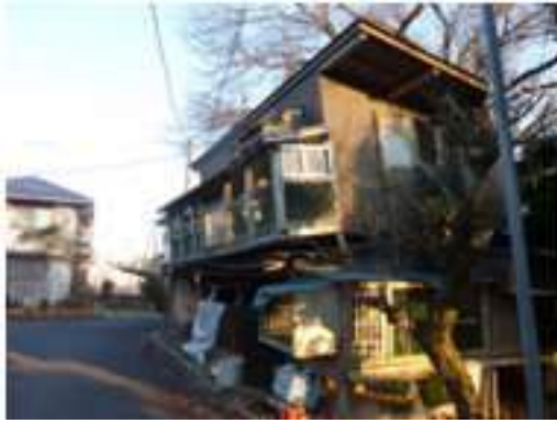
写真 5. 4-197 木造住宅の被害
