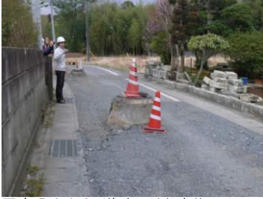
写真 5.2.9-3 道路の地盤変状 (写真 5.2.9-2 の前面道路)
