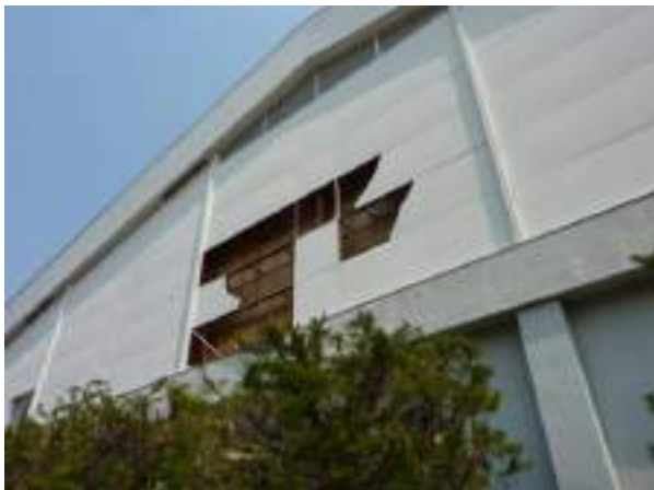
写真 5. 6-61 外装板の破損・脱落
