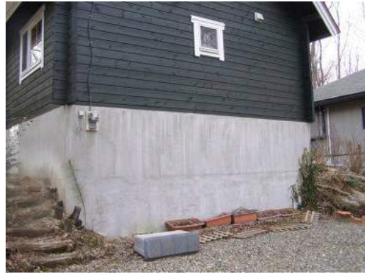
写真 5.2.7-10 高基礎部分のひび割れ (豊原乙地区)
