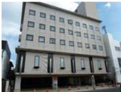
写真 5.4-138 外壁の損傷、タイルの落下
