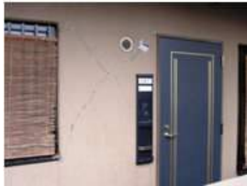
写真 5.4-146 玄関横の非構造壁のせん断ひび割れ
