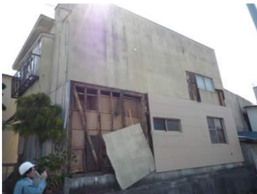
写真 5.2.2-6 外壁モルタルが剥落して、筋かいの生物劣化が顕著
