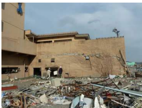
写真 6.4.1-11 非構造壁の面外破壊
