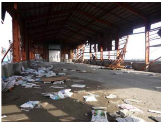
写真3 胴縁の損傷（倉庫2）
