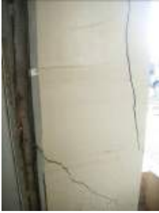
写真 6.3.11-50 壁のひび割れ
