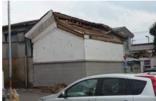
写真 5.2.6-12 屋根だけが崩壊した土蔵
