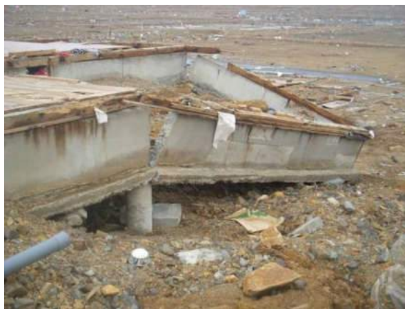
写真4 基礎直下の地盤の洗掘状況 (上部構造も流失している)
