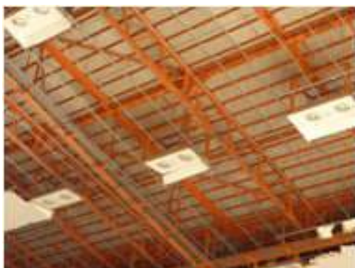
写真 5.4-208 脱落部分の拡大1
