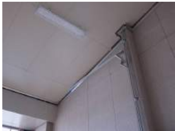
写真 5. 6-45 在来工法による天井の周辺部の被害
