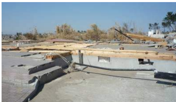
写真 6.4.3-1 上部構造が流失し土台が残った例
