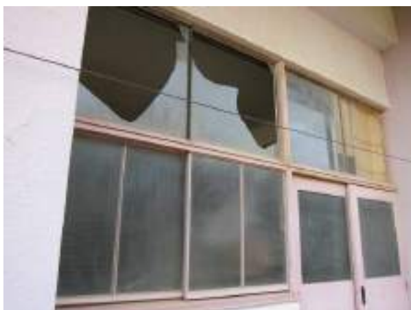
写真 5.6-54 硬化性パテどめによるガラスの被害
