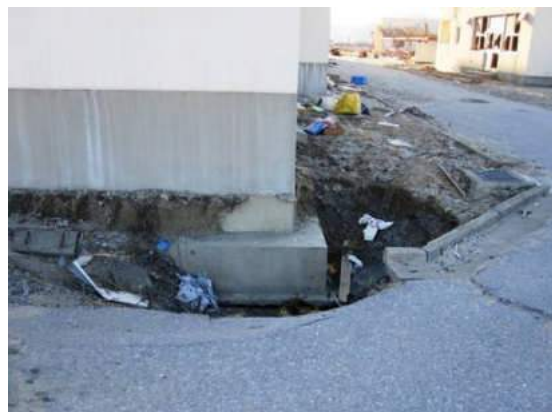
写真4 洗掘した杭基礎(2)
