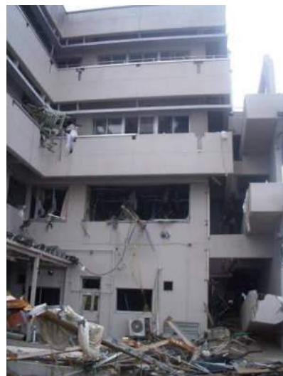
写真4 窓ガラスの破損状況
