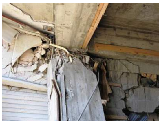
写真4 損傷した RC 柱頭
