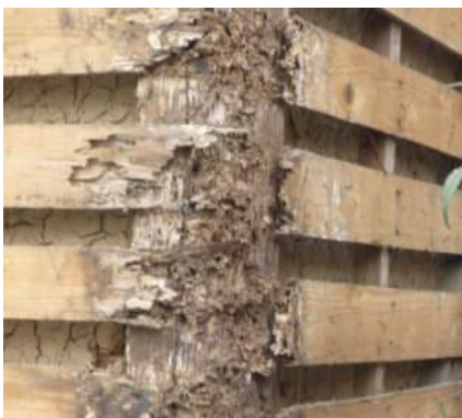
写真 5.2.6-7 写真 5.2.6-6 の柱・下地の生物劣化
