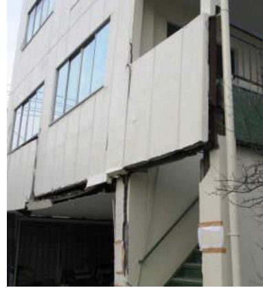
写真 5.3-6 外装材の剥離、腐食した隅柱の破断 (郡山市)
