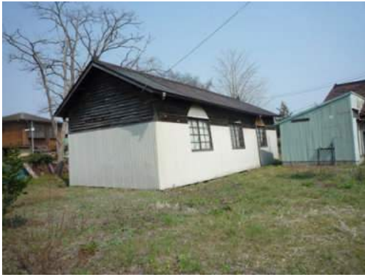
写真 5.2.2-7 残留変形が大きな倉庫
