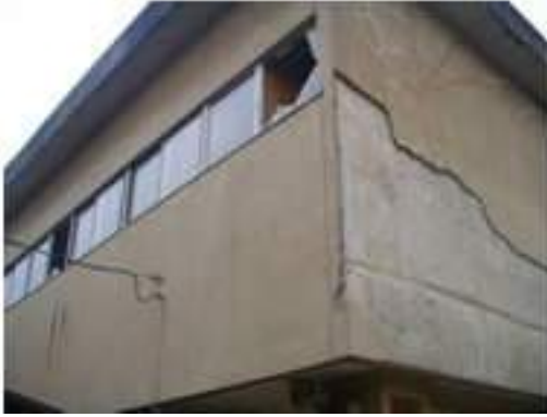
写真 5.4-72 体育館の外装被害
