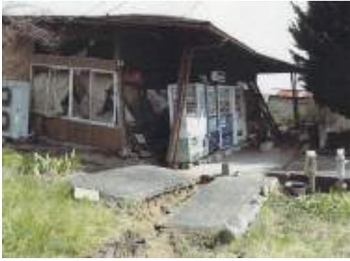
写真 5.2.12-1 大きく損壊したレストハウス（常総市上蛇町、常総市提供）
