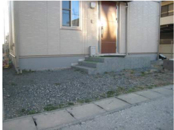
写真 5.5.2.3-54 住宅に対する地盤の相対沈下
