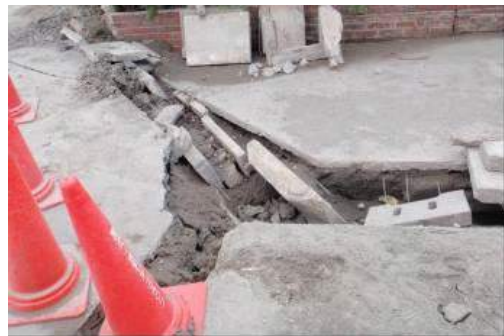
写真 5.5.2.2-12 破断した道路面
