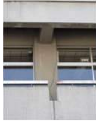
写真 5.4-124 2階柱のせん断ひびわれ
