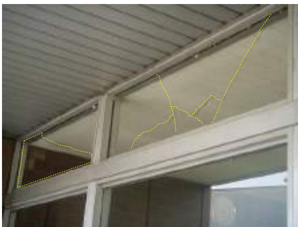
写真 5.6-22 建物入口のガラスの被害
