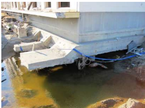
写真3 洗掘した杭基礎(1)
