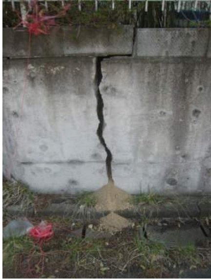
写真 5.5.2.3-31 写真 5.5.2.3-30 の住宅の盛土擁壁の破壊
