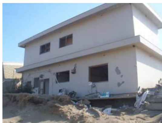
写真2 北側地盤の洗掘
