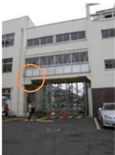
写真 5. 4-189 使用禁止の渡り廊下
