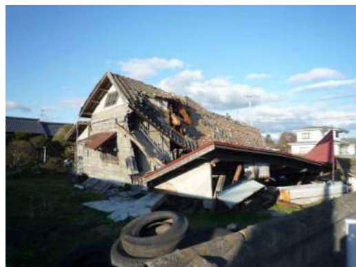
写真 5.2.3-10 倒壊した納屋
