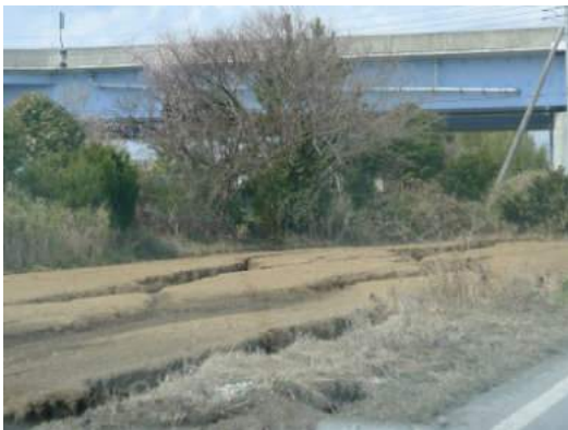
写真 5.2.11-7 道路沿いの地盤変状 (水戸市大野地区)
