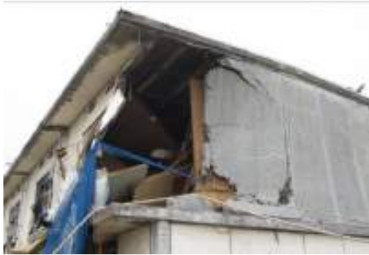
写真 6. 3. 11-29 漂流物の衝突による 2階部分の損傷
