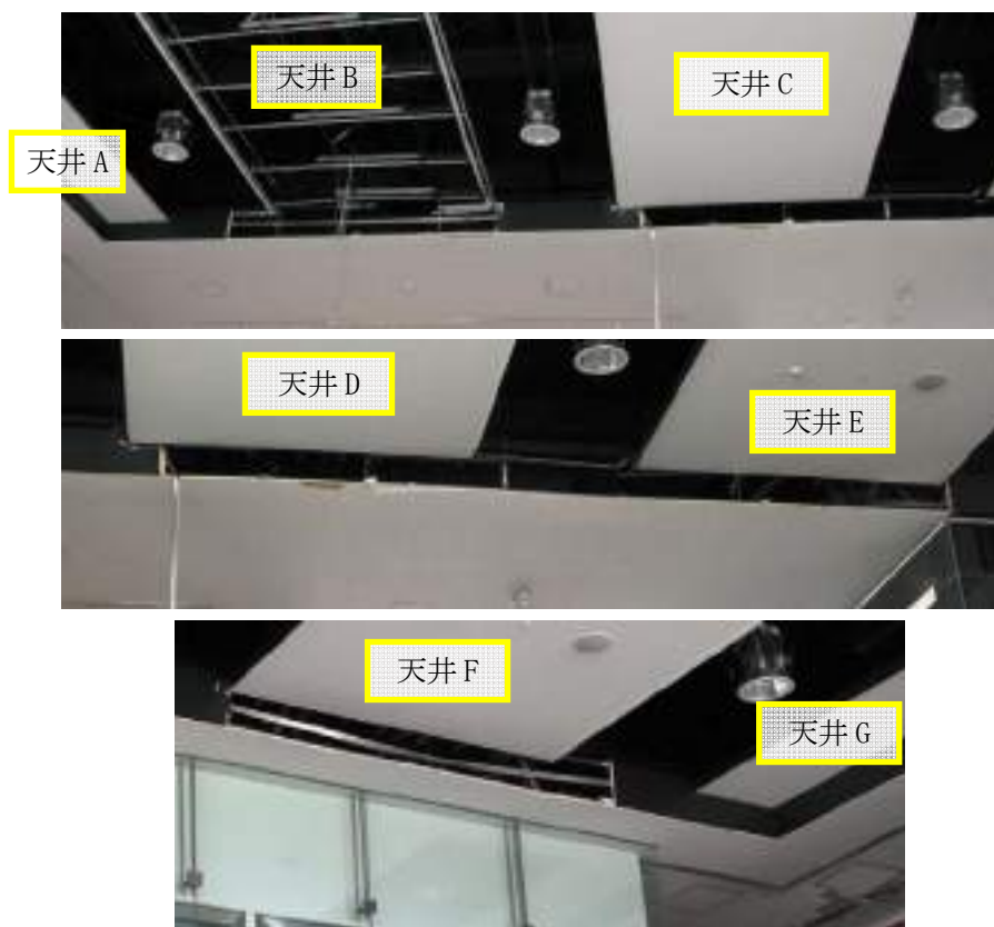
写真 5.6-70 搭乗口側の幕板の状況
