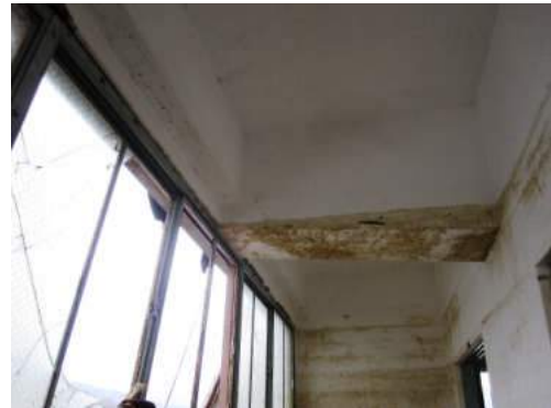
写真 6.4.1-6 建物内部の水の汚れの痕跡
