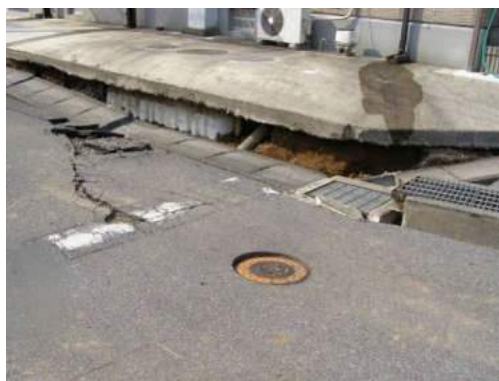
写真 5.2.8-8 宅地地盤の浮沈
