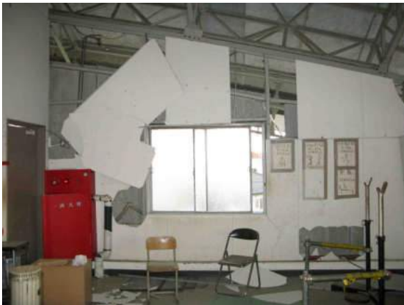
写真 5.3-48 内装仕上げの落下 (HKT-2)
