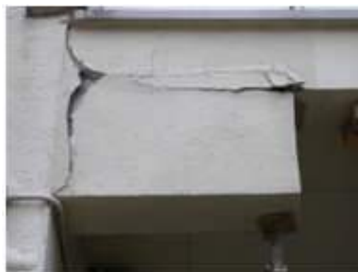
写真 5. 4-190 支持部分の損傷 （写真 5. 4-189 の○印内）
