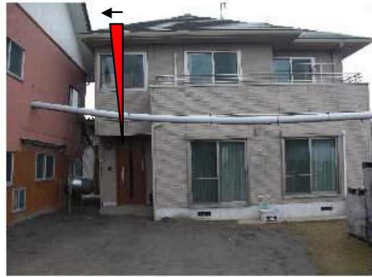
写真 5.5.2.1-25 傾斜した住宅 (写真 5.5.2.1-24 の左端)
