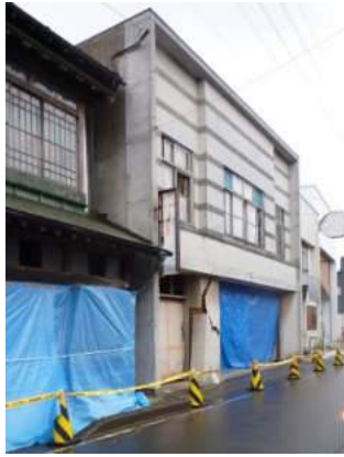
写真 5.2.1-13 商店建築物の被害
