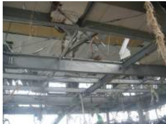
写真 6. 3. 11-47 内外装の破損
