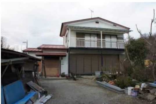
写真 5.2.7-23 大きく損壊した木造住宅 (茶臼地区)
