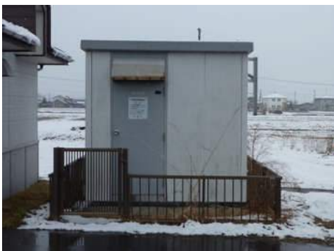
写真 5.2.1-19 栗駒の地震計設置状況
