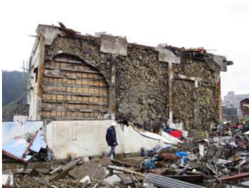
写真 6.4.1-7 塀を乗り越えた2階建て建築物
