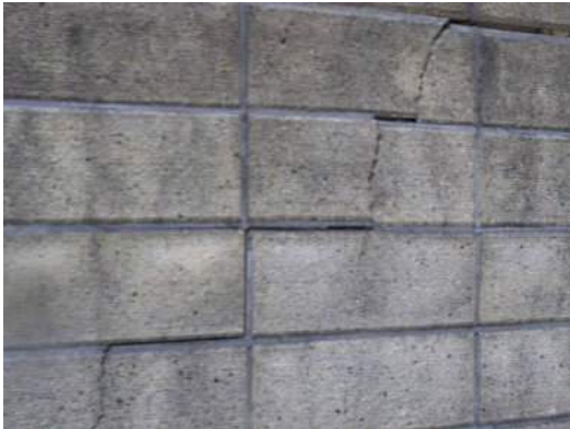
写真 5.2.8-5 塀のひび割れ
