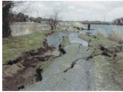
写真 5.2.12-2 レストハウス近辺の地盤の損傷（常総市提供）
