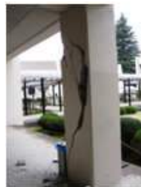
写真 5.4-36 余震でせん断破壊した柱
