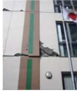
写真 5.4-150 2階袖壁脚部の損傷と打ち継ぎ部の水平ひび割れ
