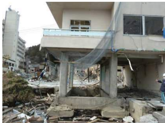
写真4 洗掘された基礎
