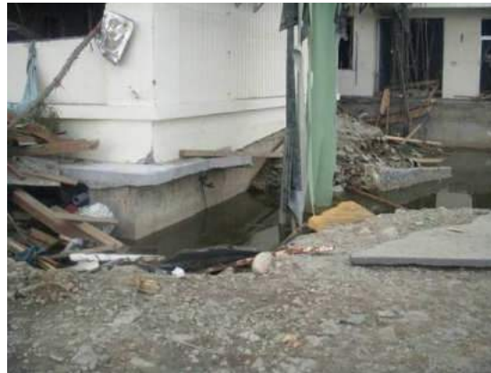
写真7 地盤の洗掘（妻面基礎部分）
