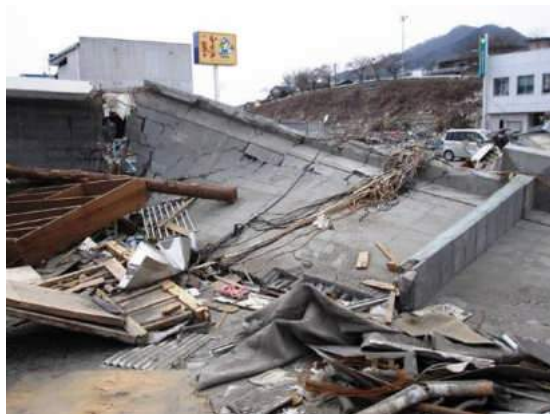
写真2 転倒したコンクリートブロック壁(1)
