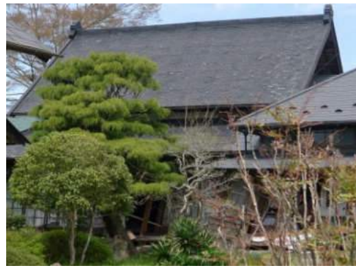
写真 5.2.3-12 残留変形が極めて大きい軸組構法住宅
