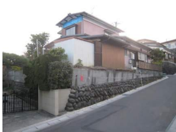
写真 5.5.2.3-20 擁壁の上部に設置されたブロック塀の転落の痕跡
