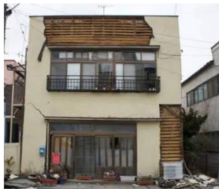
写真 5.2.6-6 外壁モルタルが剥落した住宅
