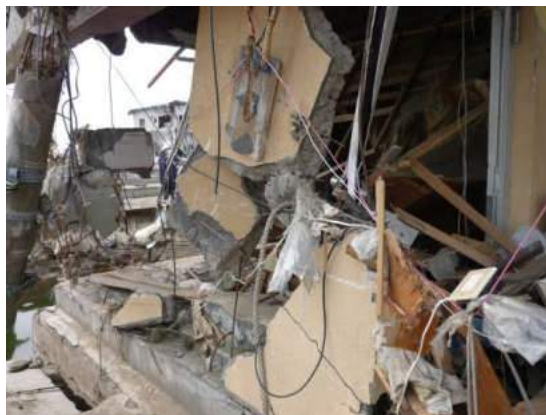
写真 3 破壊された壁部分
