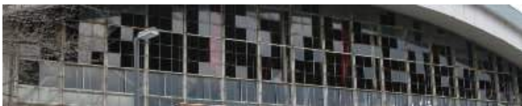
写真 5.3-50 ガラス窓の破損 (HKT-2)
