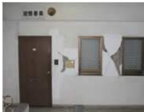
写真 5.4-19 非構造壁のせん断ひび割れ
