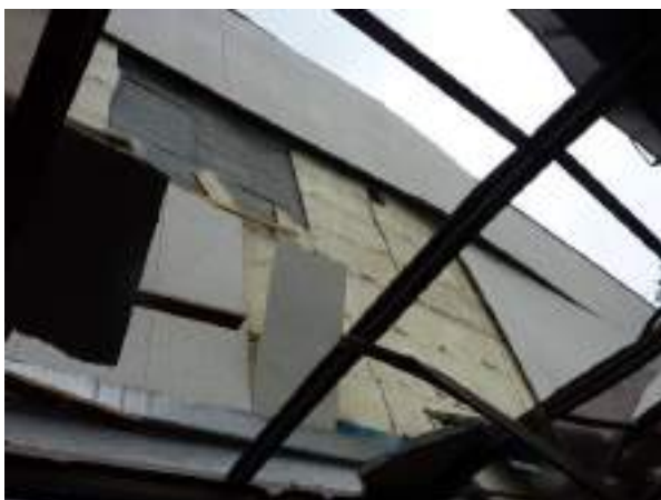
写真 5. 6-63 外装板とラスモルタル外壁の被害
