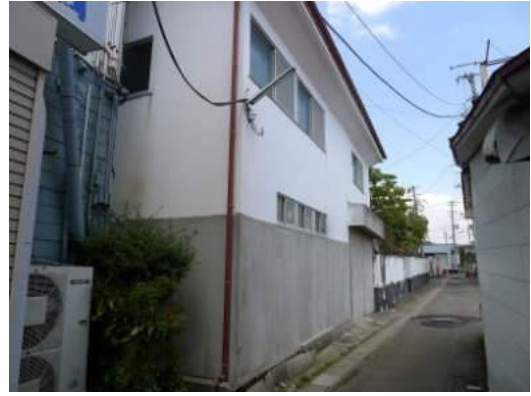
写真 5.2.2-26 外壁モルタルが剥落した倉庫
