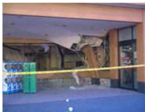
写真 5.4-106 1階入隅部の柱と天井の破壊
