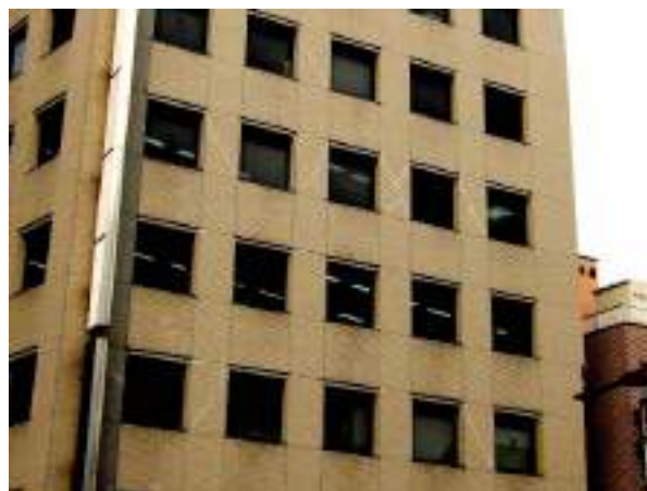
写真 5.6-27 外壁タイルの被害
