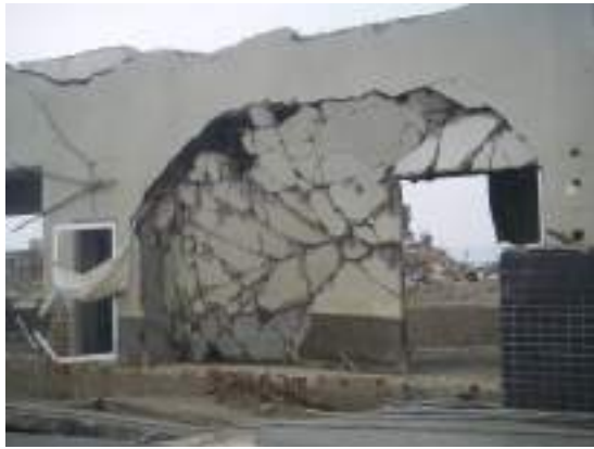
写真 6. 3. 11-43 外壁の面外へのはらみ出し
