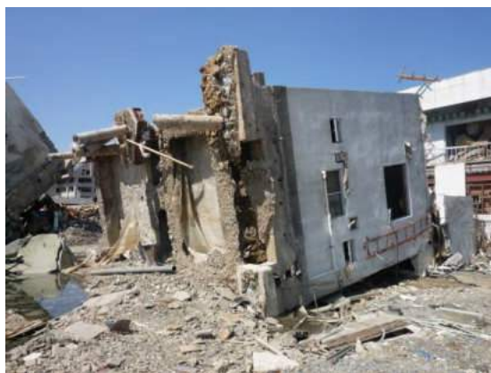
写真2 建物底面(杭の破損)
