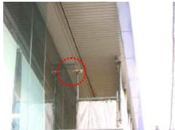
写真 5. 6-35 ガラススクリーンの被害
