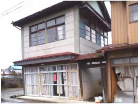
写真 5.2.1-7 町屋形式の住宅の被害
