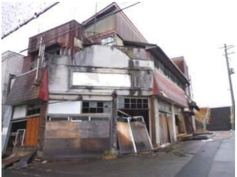
写真 5.2.1-12 老朽化した商店建築物の被害
