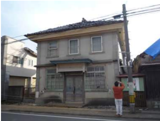
写真5.2.7-3 旧郵便局庁舎の被害
