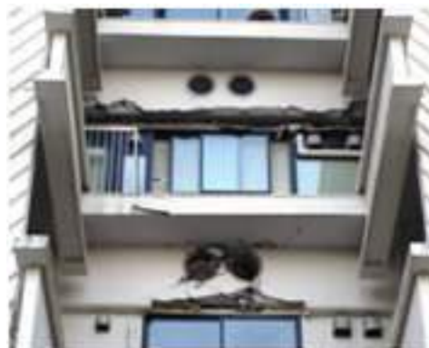
写真 5. 4-33 開口付き境界梁の付着割裂破壊 (上階) とせん断破壊 (下階)
