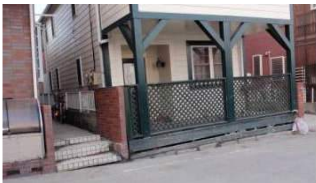
写真 5.5.2.2-13 左側が沈下・傾斜した住宅
