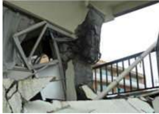
写真 5.4-46 腰壁付き短柱の軸崩壊
