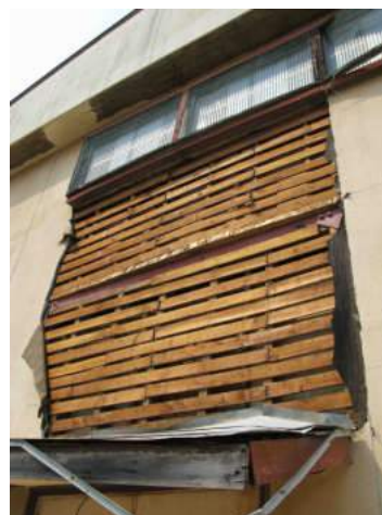
写真 5.3-45 外装仕上げの落下 (SSM-2)
