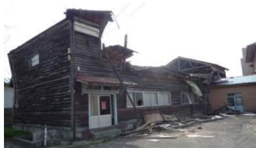
写真 5.2.2-10 2階が崩壊した学校建築
