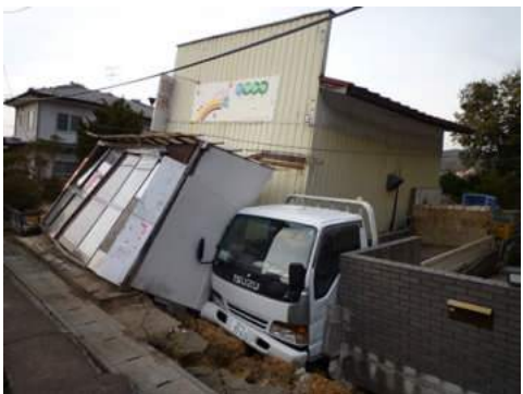
写真 5.2.5-5 地盤変状に伴う住宅被害 (青葉区折立 5 丁目)
