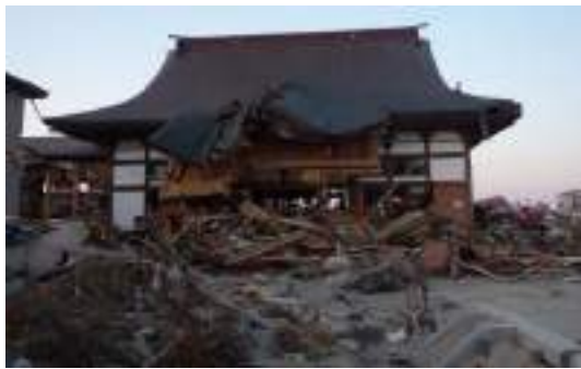
写真 6. 3. 11-3 大きく損壊した寺社建築 (②)
