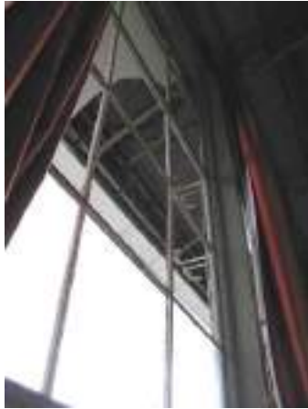
写真 5. 6-48 在来工法による軒天井の被害
