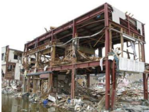
写真 6.4.2-17 残存する S 造 (大船渡市) (露出柱脚、1 階途中から日の字断面、2 階床は木製)
