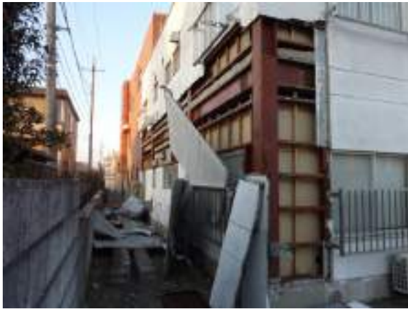
写真 5.6-28 ラスモルタル外壁の脱落被害
