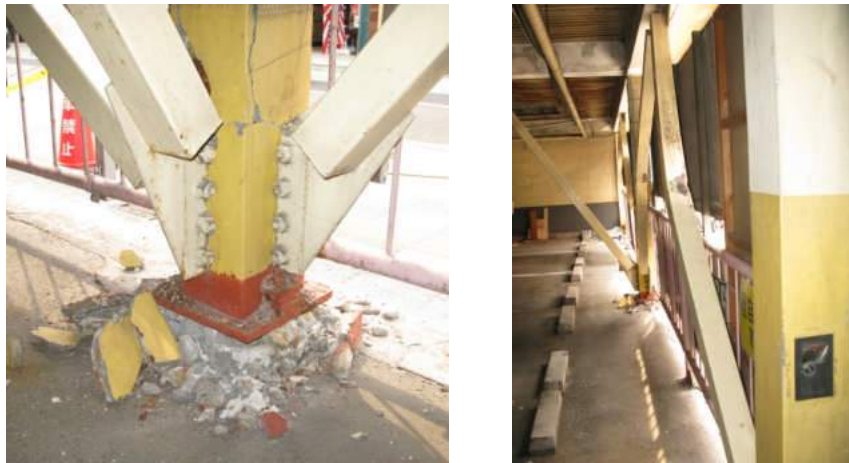
(a) 柱脚の損傷 (b) ブレース (□-100) の座屈
