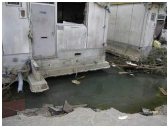
写真3 周辺地盤の洗掘
