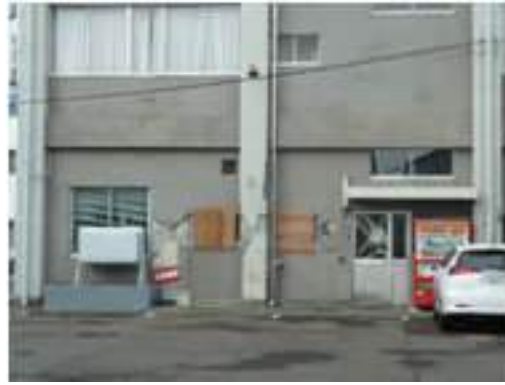
写真 5.4-38 腰壁付き短柱のせん断破壊
