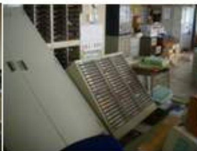
5階（ロッカーの転倒）
