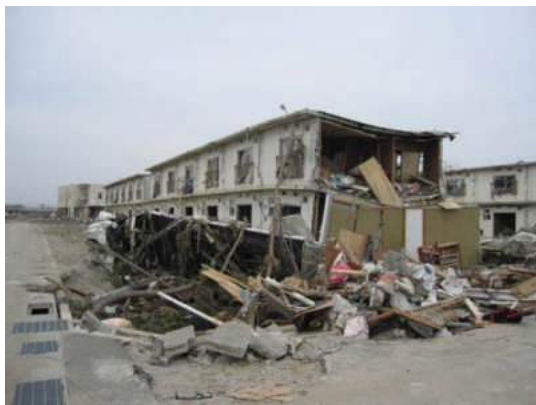
写真1 建物東端1戸分の崩壊
