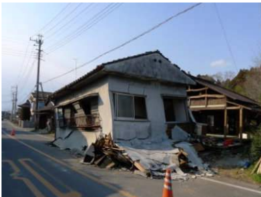
写真 5.2.10-5 倒壊した住宅 (那珂市瓜連)
