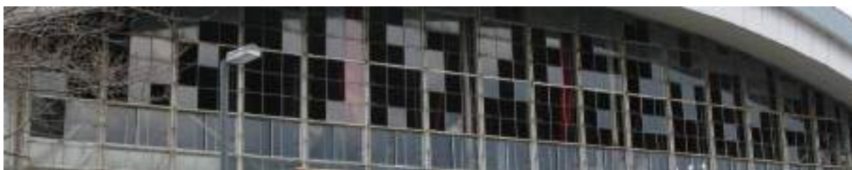
写真 5.6-58 鋼製サッシによる窓のガラスの被害
