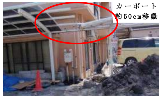
写真 5.5.2.2-4 移動したカーポート
