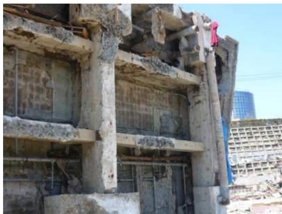
写真 3 基礎部分 (垂れ下がった PC 杭)
