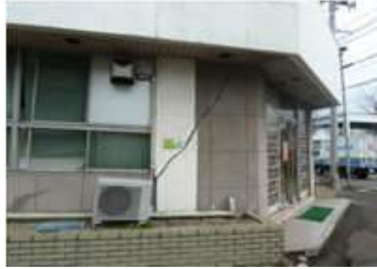
写真 5.4-42 袖壁付き短柱のせん断破壊
