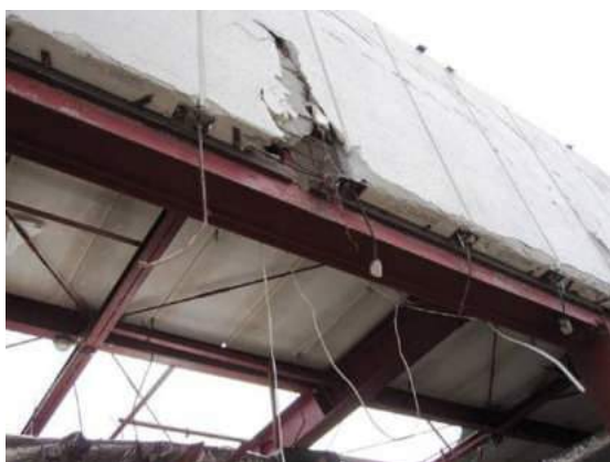
写真 3 損傷した ALC パネル
