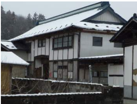
写真 5.2.1-17 長屋門の土塗り壁剥落 (栗原市栗駒桜田)
