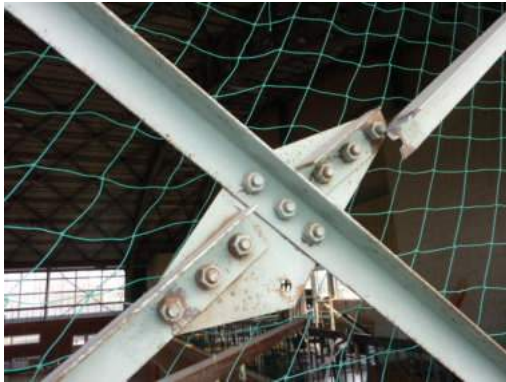
(a) 接合部の破断
