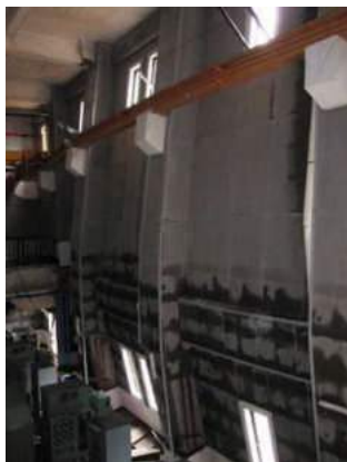
写真 3 耐力壁の面外変形
