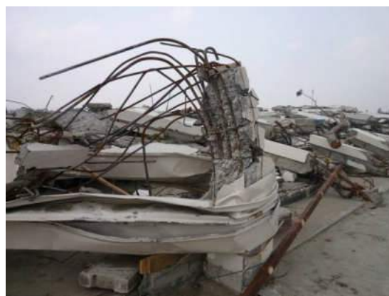
写真2 倒壊したRC造柱
