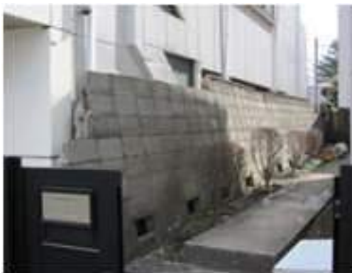
写真 5.4-153 コンクリートブロック塀の倒壊
