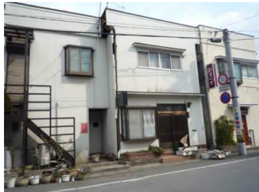
写真 5.2.6-8 外壁モルタルが剥落した住宅
