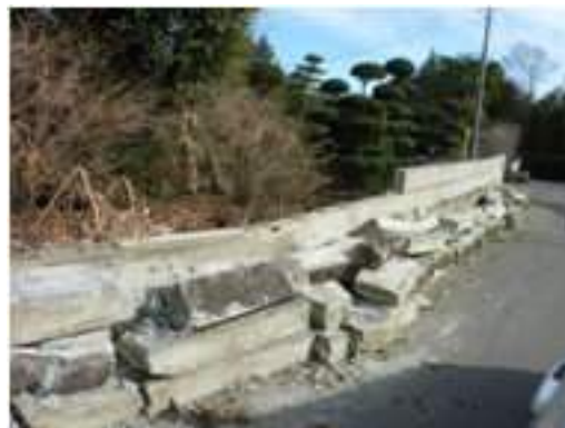
写真 5.4-212 ブロック塀の被害
