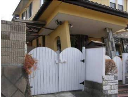
写真 5.2.8-11 地盤変状により大きく傾いた住宅
