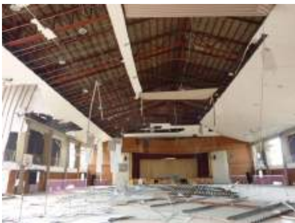
写真 5.6-40 在来工法による天井等の脱落被害
