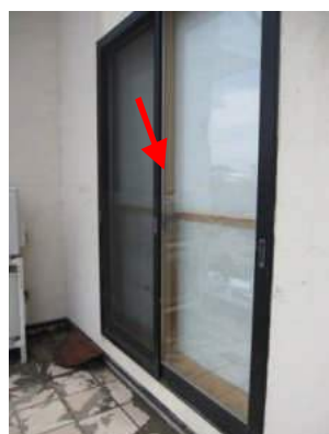
写真3 2階窓ガラスの浸水痕
