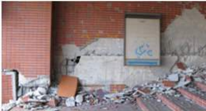
写真 5.4-171 壁及びSRC柱脚の損傷
