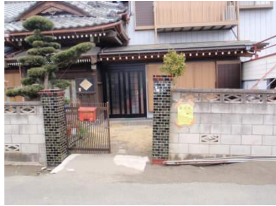
写真 5.5.2.1-6 ブロック塀の段差
