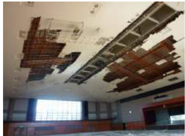
写真 5.6-39 在来工法による天井の脱落被害
