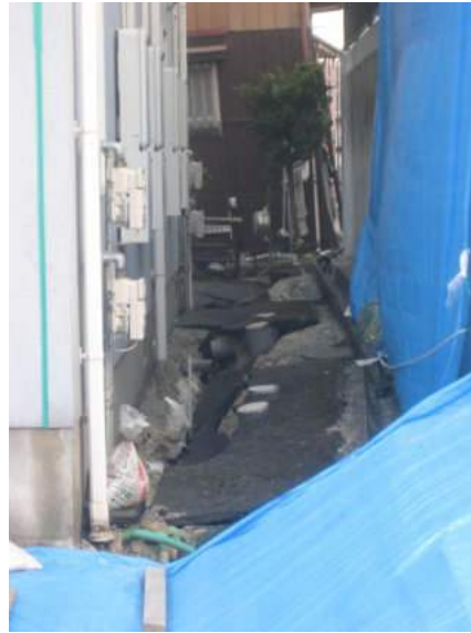
写真 5.5.2.3-18 周辺地盤の沈下・変状によるライフラインの損傷
