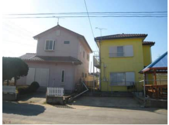
写真 5.5.2.1-46 液状化により傾斜した戸建て住宅群
