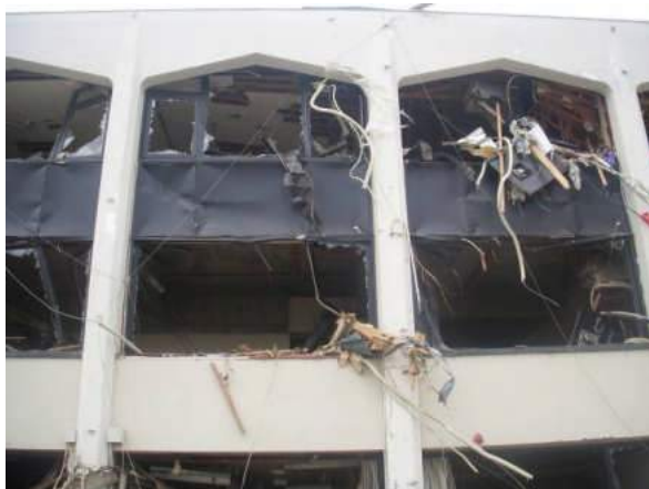
写真2 開口部と内装材の損壊
