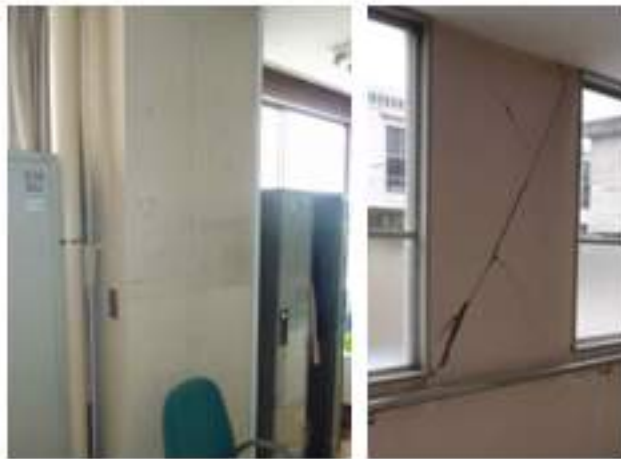
写真 5.4-65 柱と方立て壁のせん断ひび割れ
