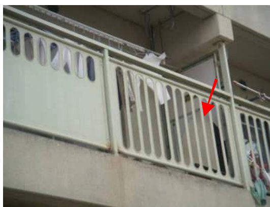
写真2 住戸間の仕切りの破損状況 (2階)
