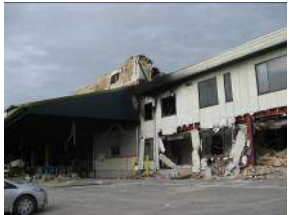
写真 7.3.1-3 仙台塩釜港北側の倉庫2の火災
