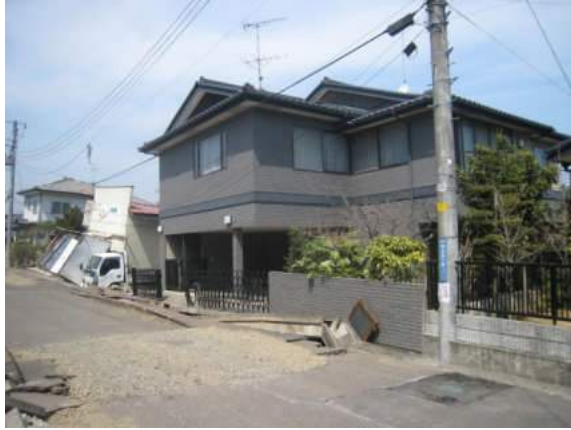
写真 5.5.2.3-3 宅地盛土の滑動・地盤変状による住宅の移動・沈下・傾斜
