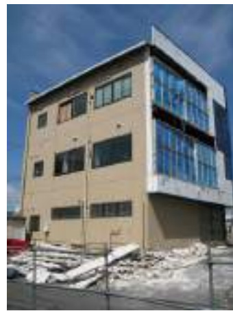
写真 5.6-19 ALC パネル外壁の脱落被害
