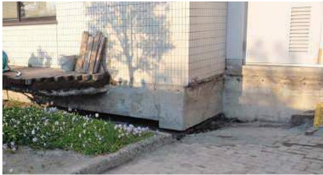
写真 5.5.2.2-16 周辺地盤が沈下した建物
