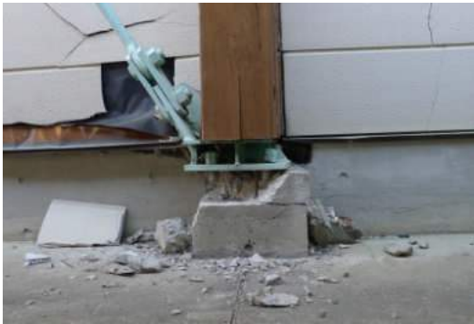
写真 5.2.10-9 基礎コンクリートの破損
