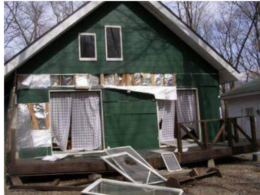
写真 5.2.7-8 大きく損壊した建物 (豊原乙地区)
