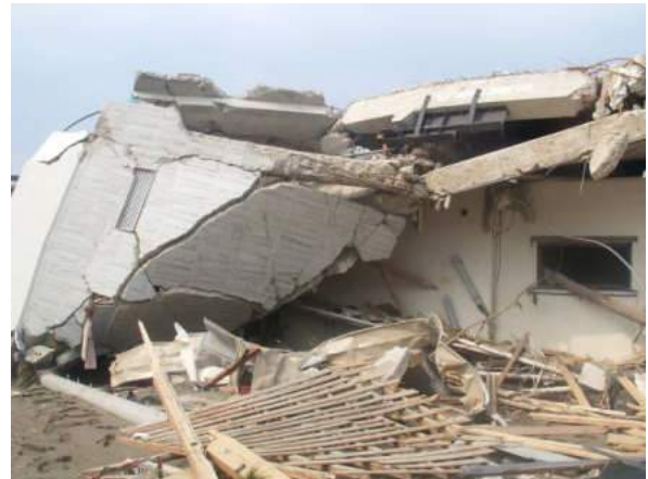
写真3 耐力壁の倒壊
