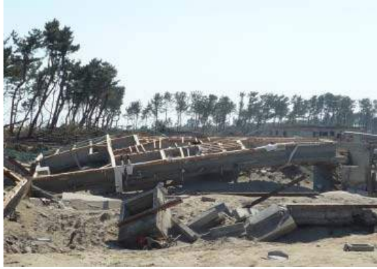
写真 6.3.10-1 漂着したか地盤が さらわれたべた基礎
