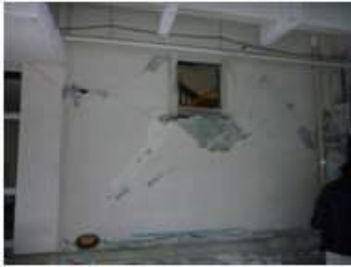
写真 5.4-201 開口部付き耐力壁の破壊
