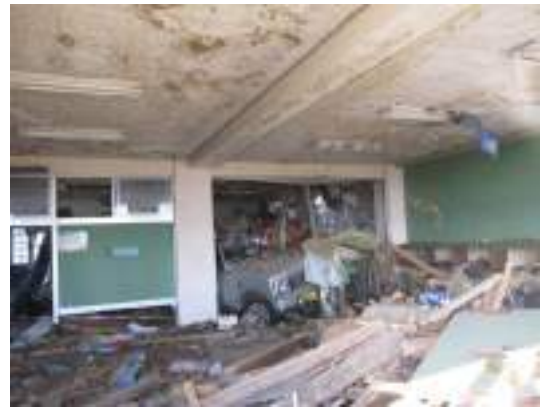
写真 6. 3. 10-16 1 階教室の状況
