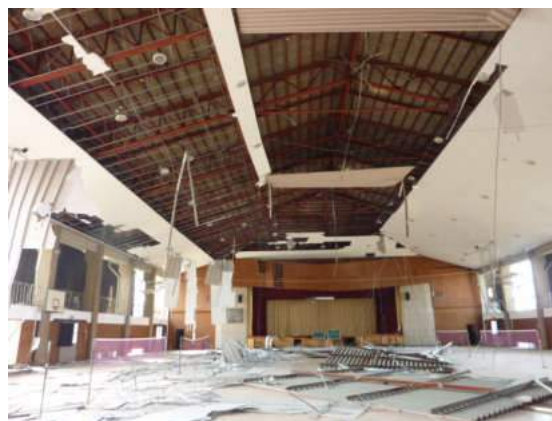
写真 5.3-43 天井材脱落 (MIT-7)
