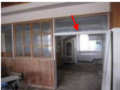
写真 6. 3. 14-11 室内の浸水痕
