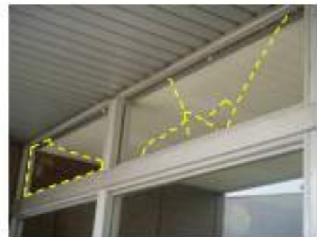
写真 5.4-67 ガラスの破損
