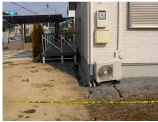
写真 5.2.8-4 地盤のひび割れとすべり
