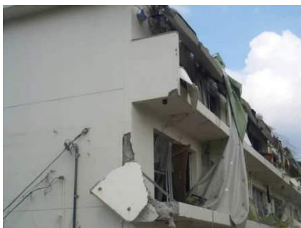
写真3 屋根スラブとベランダ手すりの損壊
