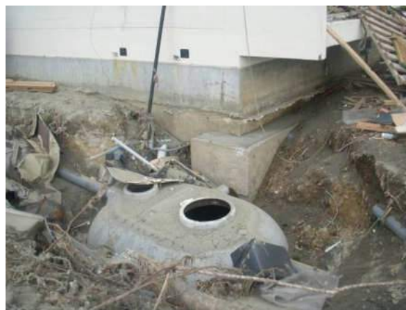
写真4 地盤の洗掘状況
