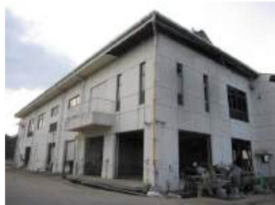
写真 6.3.12-13 屋根及び窓ガラスの損傷
