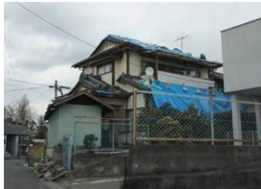
写真 5.2.6-20 屋根瓦の被害
