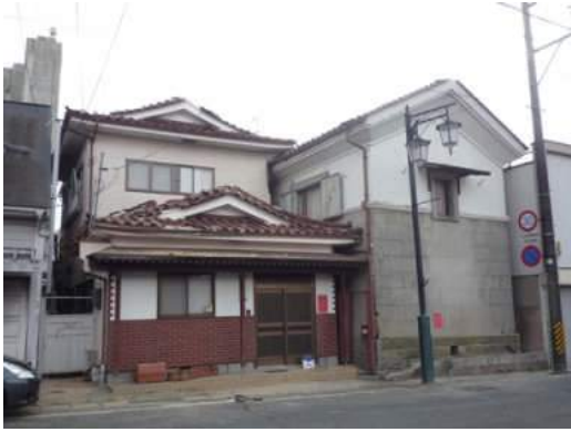
写真 5.2.6-17 残留変形が残る木造住宅
