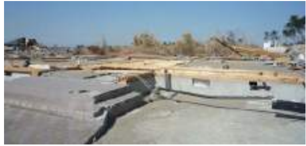
写真 6.3.10-2 基礎と土台が残る被害例
