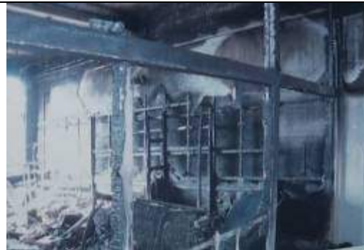
写真 7.3.16-2 火災室（備品庫）
