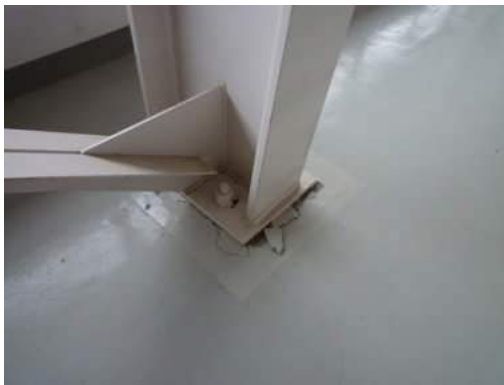
写真 5.3-30 モルタルの損傷 (栗原市)
