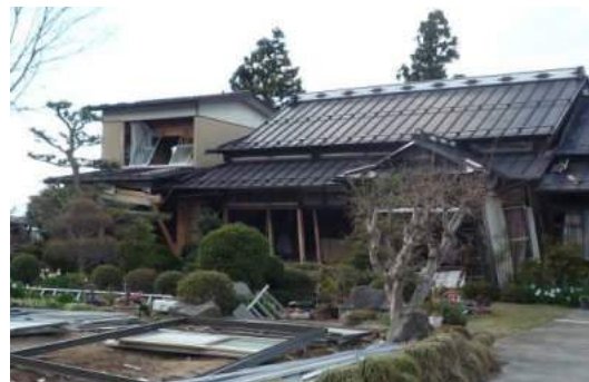
写真 5.2.3-2 残留変形の大きな住宅
