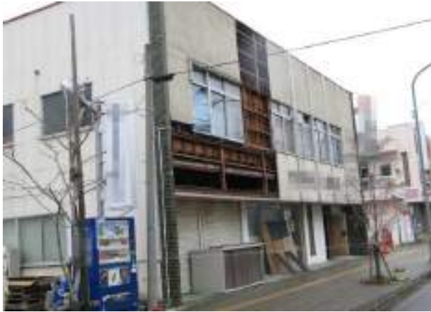
写真 5. 6-3 ラスモルタル外壁の脱落被害
