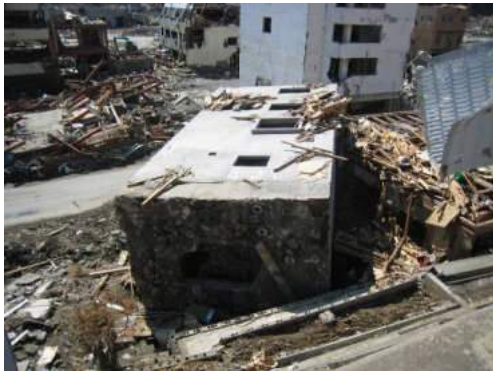
写真 6.4.1-5 4階建て杭基礎建築物の転倒
