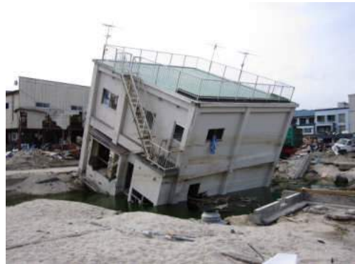
写真 6.4.1-10 洗掘による2階建て建築物の傾斜
