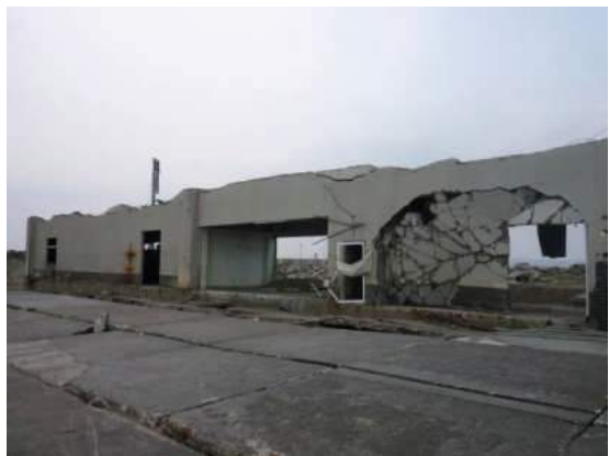
写真2 RC造建物の被害
