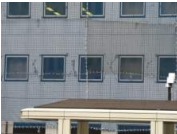
写真 5.6-1 外壁タイルの脱落被害
