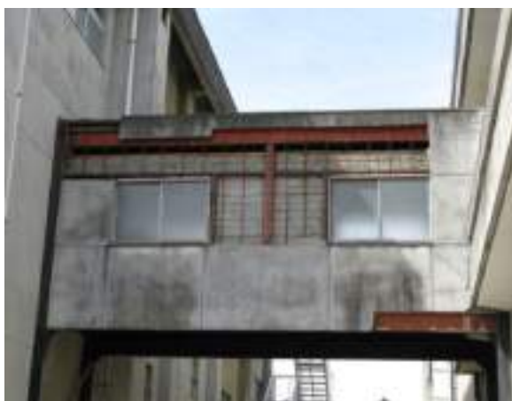
写真 5.6-17 ラスモルタル外壁の脱落被害
