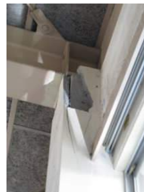
写真 5.3-22 仕上げモルタルの剥落 (MIT-27)
