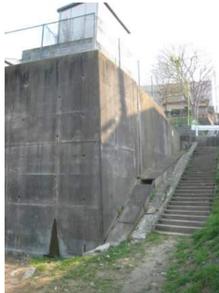
写真 5.5.2.3-14 宅地盛土の滑動・地盤変状による宅地擁壁の損傷（青山2丁目付近）
