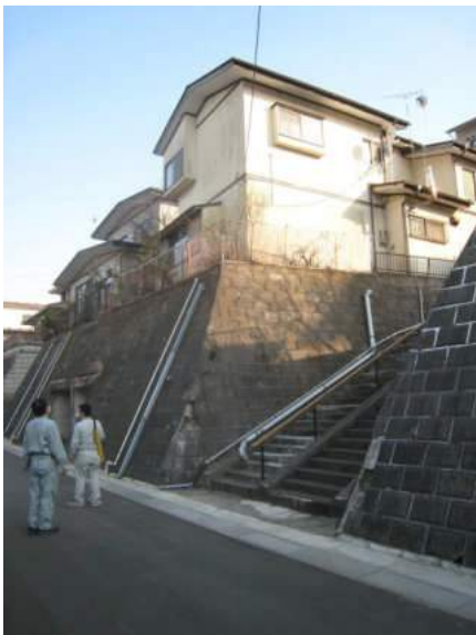
写真 5.5.2.3-13 宅地盛土の滑動・地盤変状による宅地擁壁の損傷（青山2丁目付近）
