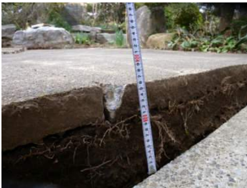
写真 5.5.2.1-9 入口付近の沈下
