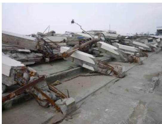
写真3 柱が同じ方向に倒壊
