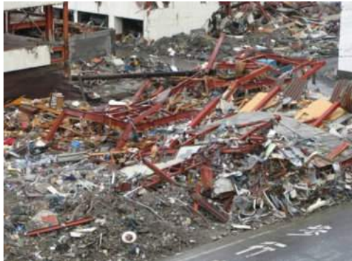
写真 6.4.2-7 1階及び2階柱の残存 (女川町)
