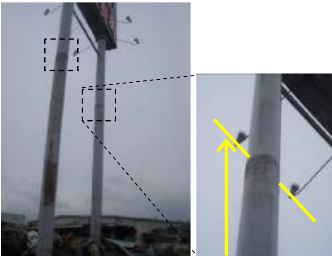
写真 6. 2. 1-8 広告塔の支柱に残った痕跡
