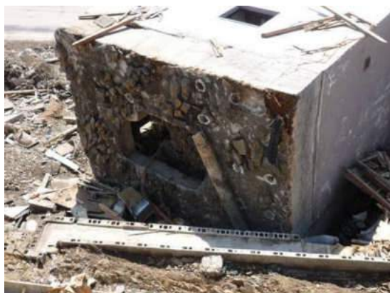
写真2 基礎底面(杭の破断) 基礎スラブ厚500mm
