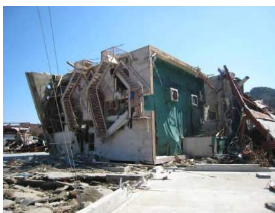
写真 2 転倒建物 (北西側から)
