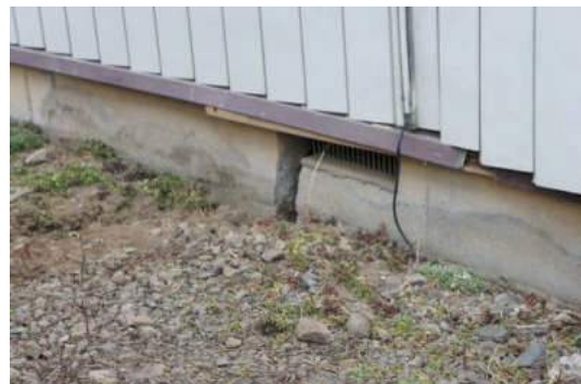
写真 5.2.7-22 写真 5.2.7-19 の無筋基礎の ひび割れ
