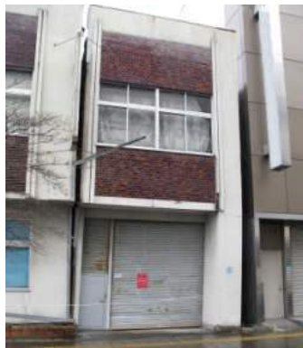
写真 5.3-4 1階の残留変形（仙台市若林区）
