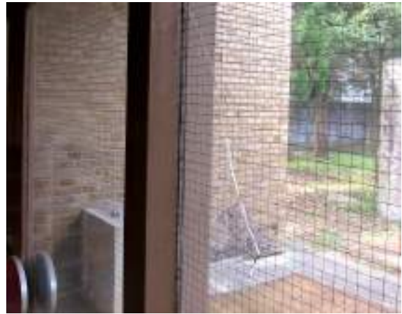
写真 5. 6-33 窓ガラスの被害
