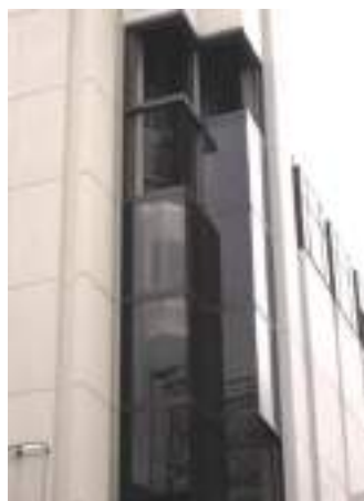
写真 5.6-11 エレベーター周りのガラス被害
