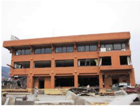
写真 6.4.1-13 衝突による非構造部材の損傷
