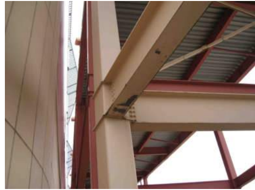
(b) 梁端部塗装の剥がれ
