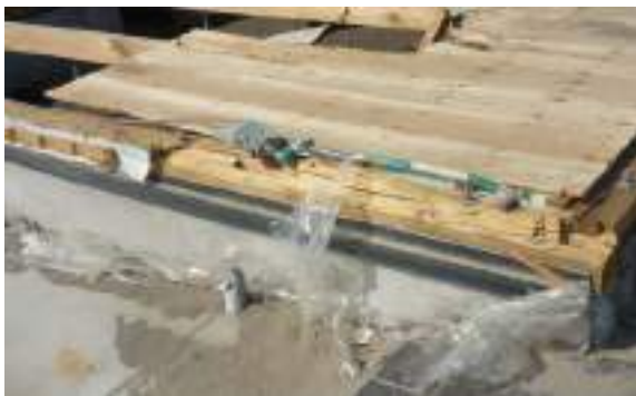
写真 6.3.10-5 土台が割裂した例
