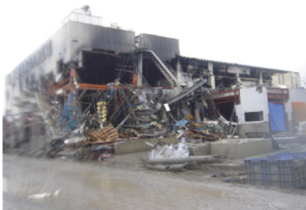
図 6 南気仙沼地区の被災冷凍工場
