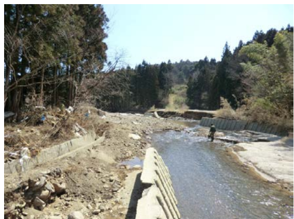
写真-10 滝集落, 簗ノ子川の護岸破損状況
