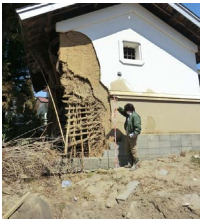
写真-7 滝集落家屋の被災状況
