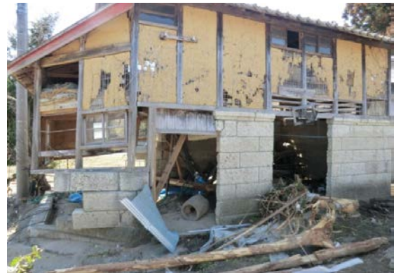
写真-8 滝集落家屋の被災状況
