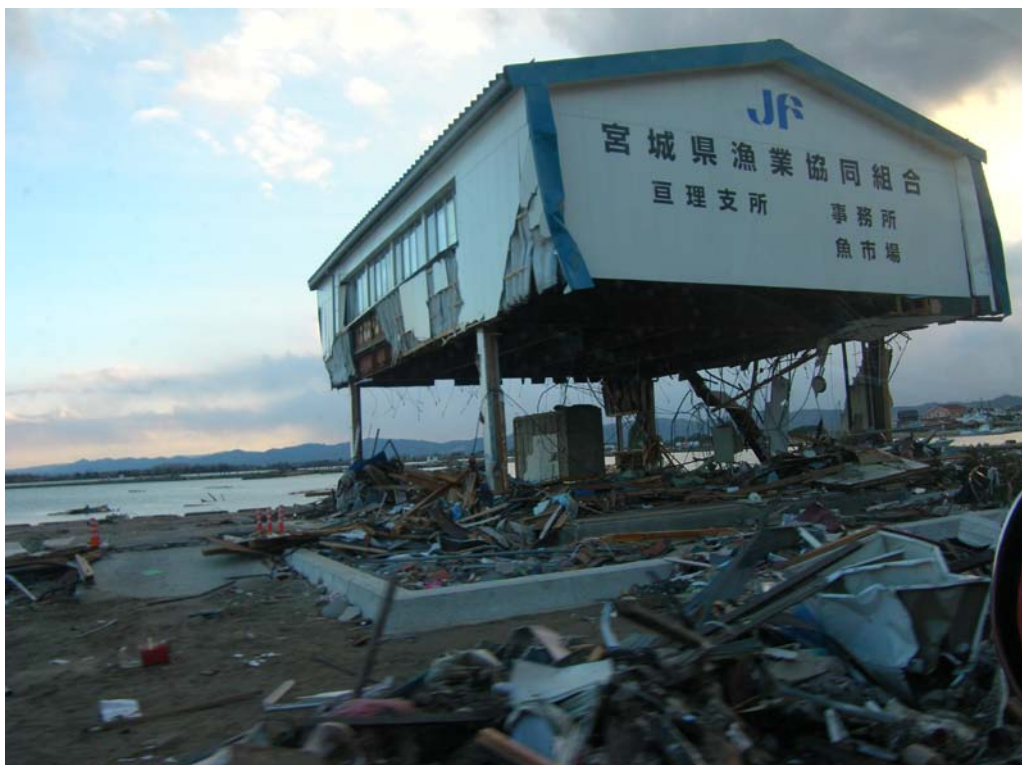
宮城県漁業協同組合亘理支所の被害状況
