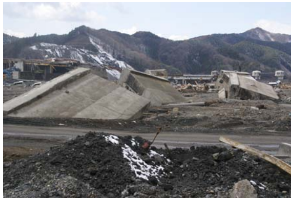
倒壊した防波堤
