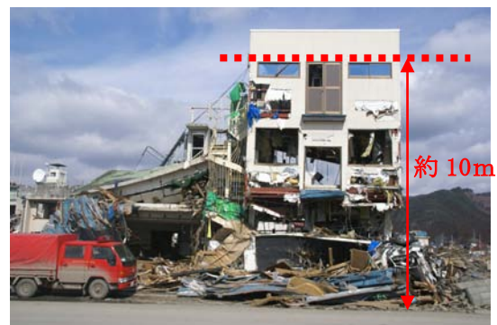
被災した大槌消防署
