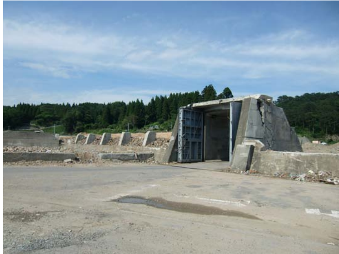
写真2 津波で損壊した田老地区の防潮堤
