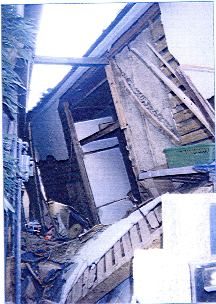
【写真⑥】『幸運にも隣人は大工さん』 大工道具をもった専門家の助けがあって、二階の押入れ から救出された。 崩壊を防ぐつかい棒はさすが。
