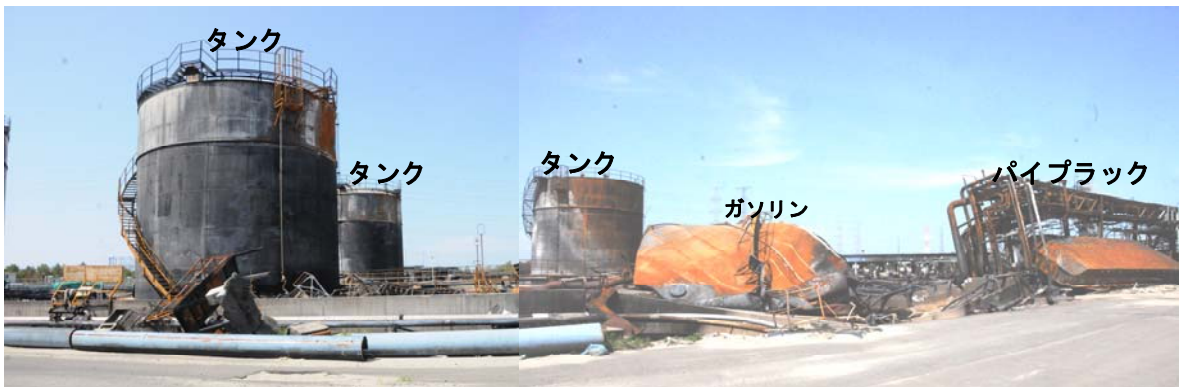
図5 石油タンクエリアの状況
