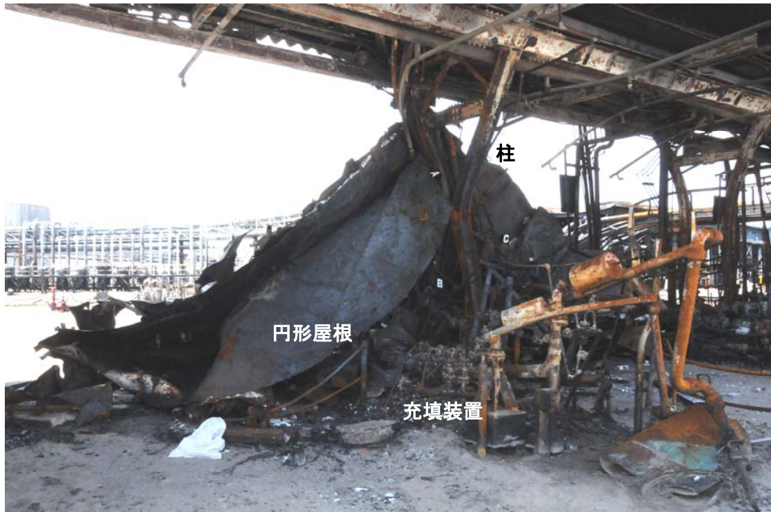
図3 アスファルトタンクの屋根が接触しているガス積荷場の状況
