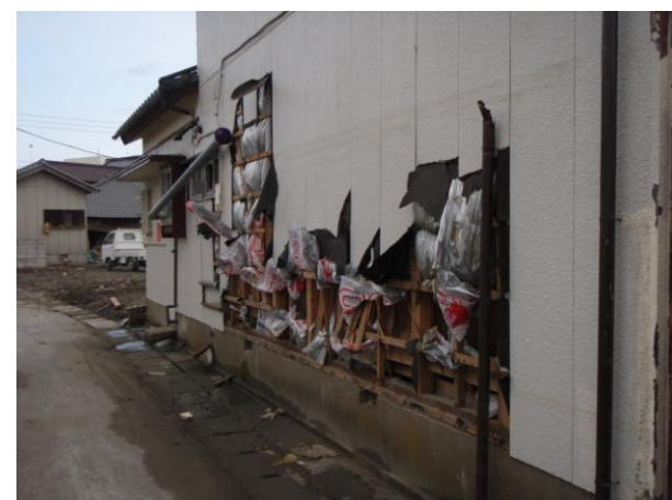
いくつかの住宅の壁面には水没した痕跡と思われる線が残っていた。
