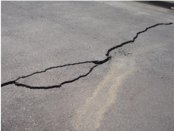
神栖市役所付近の地面の亀裂。地震発生当日、市役所ではこれまでなかった強い揺れを感じたという。
