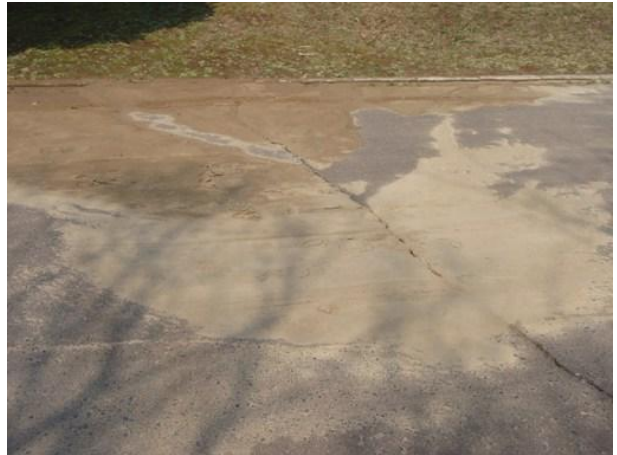
市役所裏の公園では液状化により噴出した泥が各所で見られた。
