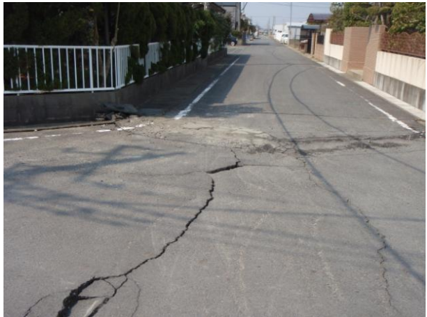
地割れから噴き出した泥が乾いて砂となり、路面が滑りやすくなっていた。
