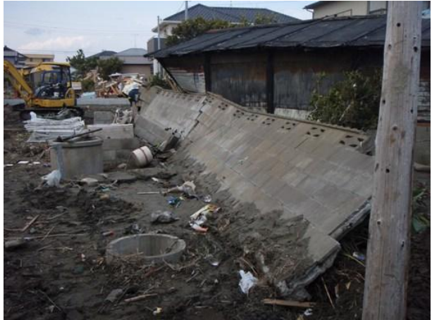
被災区域の至る所でブロック塀が倒壊していた。
