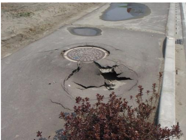
歩道が陥没したことによりマンホールが浮き上がり、アスファルトが割れていた。
