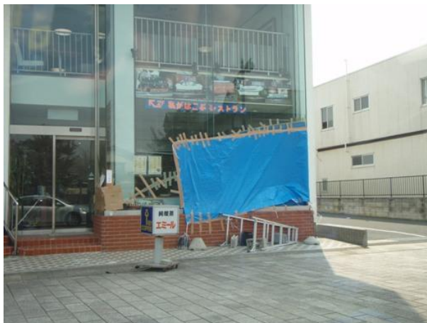
カフェ店のガラスが損壊し、ブルーシートが貼られていた。
