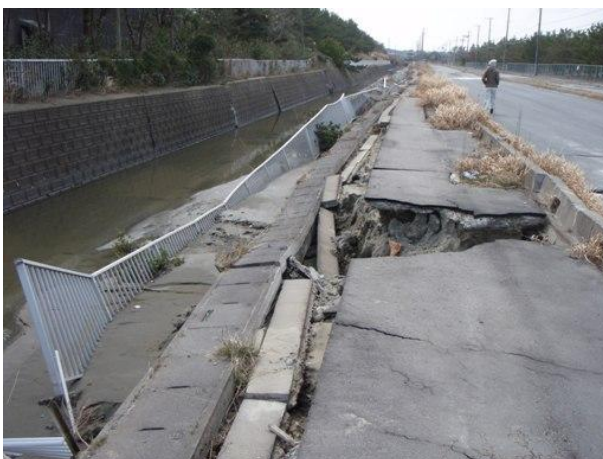
工業地帯を流る川の岸壁が広範囲にわたって崩落し、柵が砂に埋もれていた。
