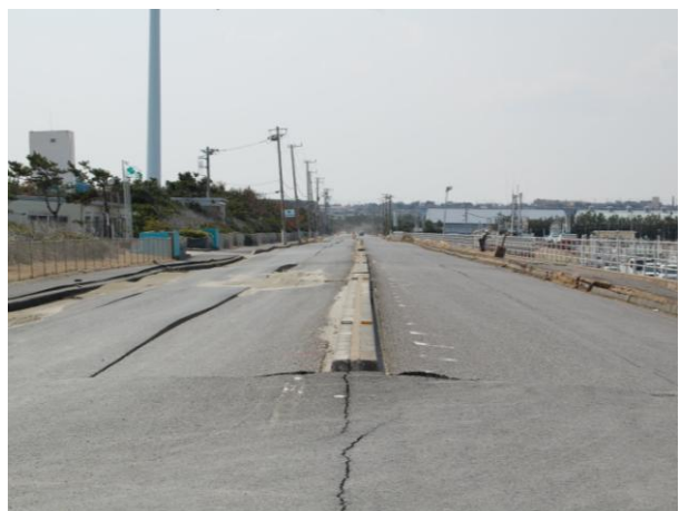
鹿嶋港内各所において液状化により泥と水が噴出していた。
