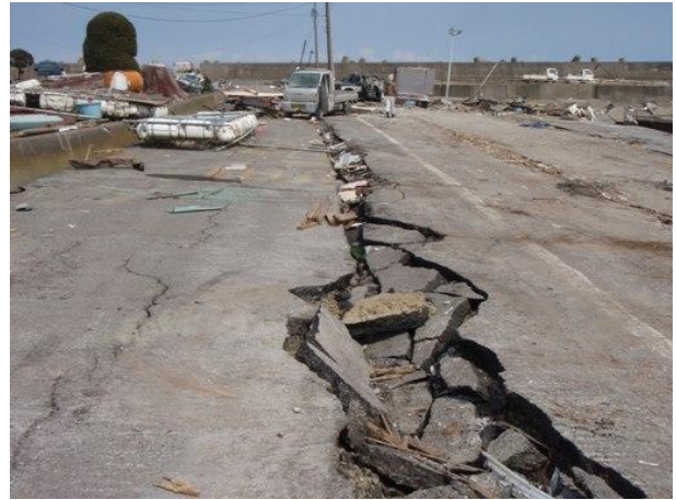
港湾部の各所で地割れがみられた。
