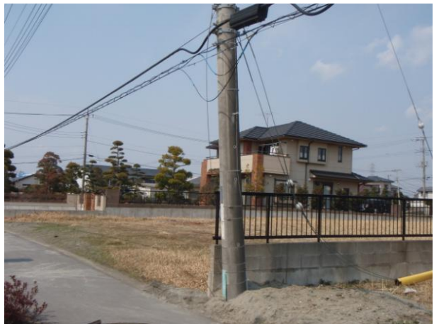
液状化により1メートル以上沈み込んだ電柱。また、大きく傾いた電柱も数多く見られた。
