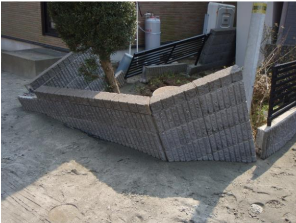
液状化による塀の損壊が各所で発生していた。
