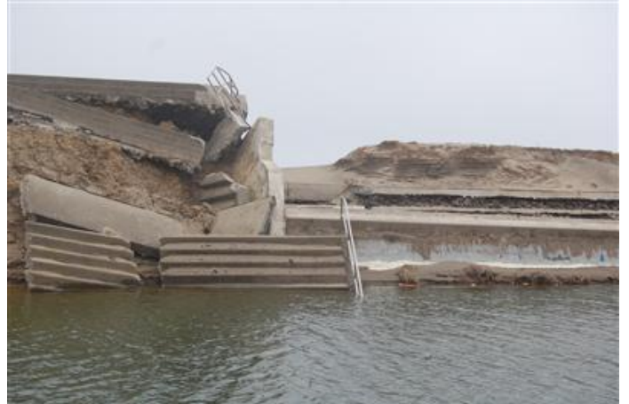
荒浜地区、防潮堤・防波堤も津波により壊滅した
