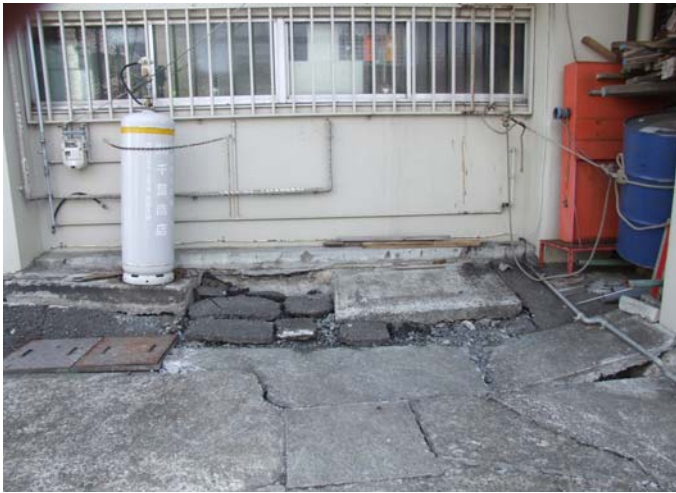
庁舎周囲の地盤が沈下
