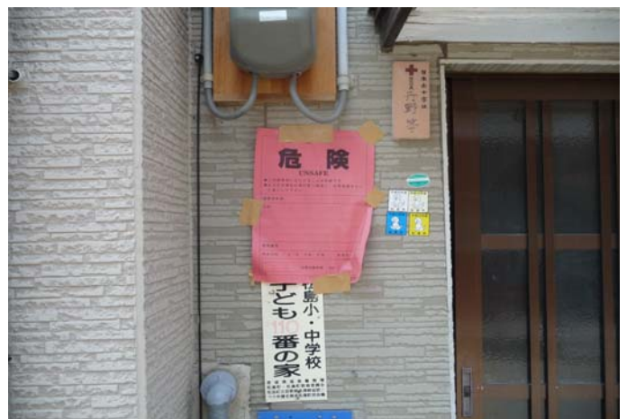
危険と判定された家屋(陸前富山駅付近)
