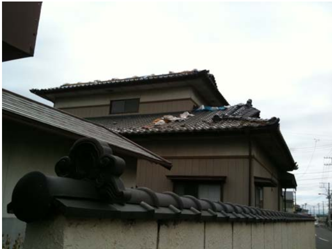
被害を受けた屋根瓦
