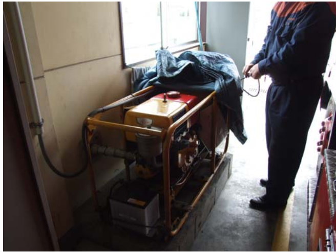
非常電源を作動させた
