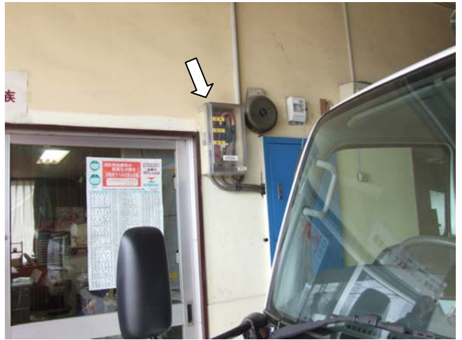
商用電源と非常電源の切替盤
