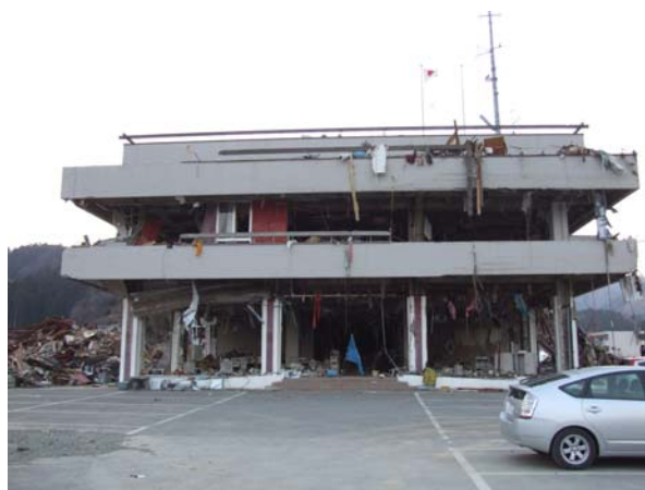
女川町役場 全体が水に浸かった
