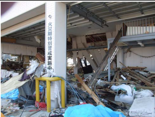
庁舎の内部まで押し寄せた瓦礫
