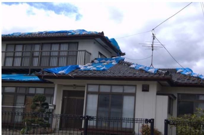
名取市内の被害
