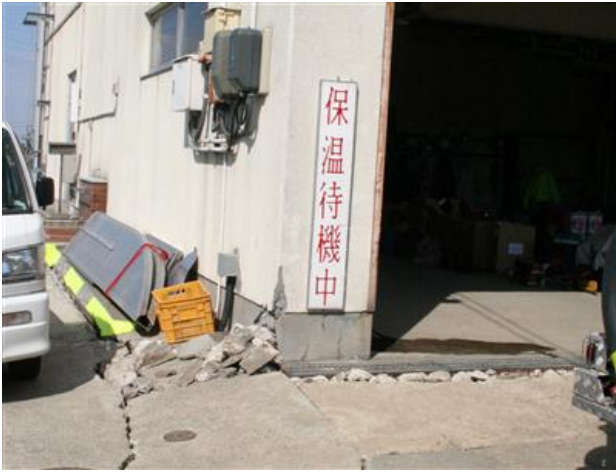
庁舎基礎部分には段差、ひび割れが見られた
