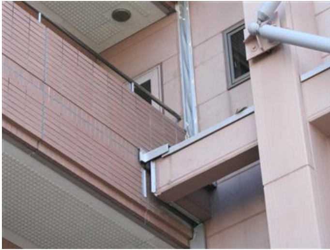
庁舎は地震のためか接合部にズレが生じている
