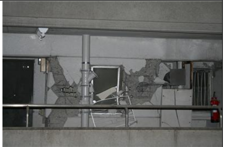
各階で写真の様なコンクリートの割れが見られた
