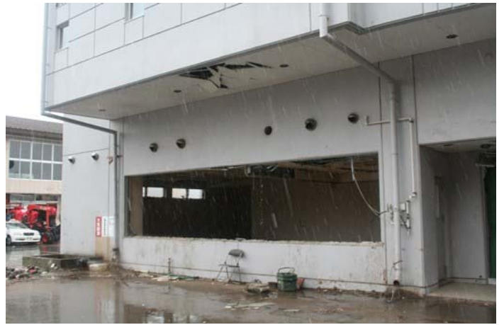
消防署 1 階の被害様子
