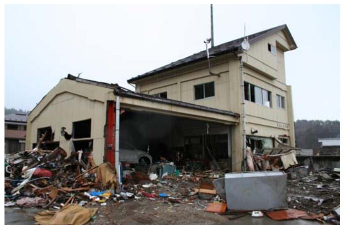
瓦礫の流れ込んだ車庫内部、車も見える
