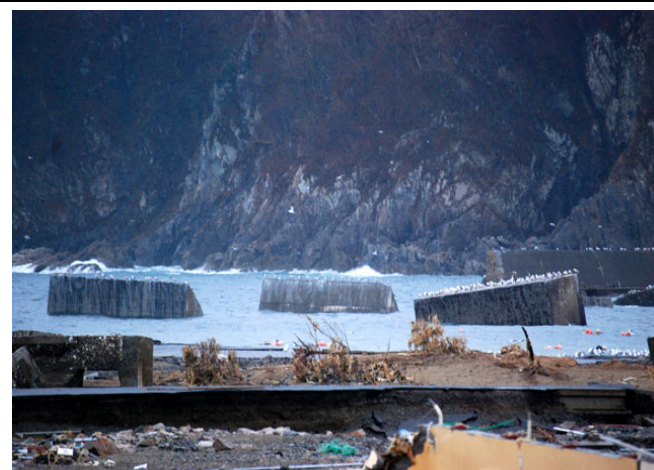
海上に残る防潮堤・防波堤の残骸
