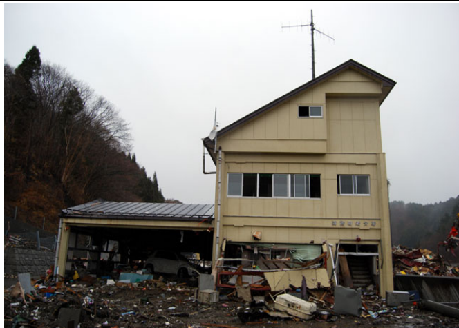
津波による被害で使えなくなった庁舎
