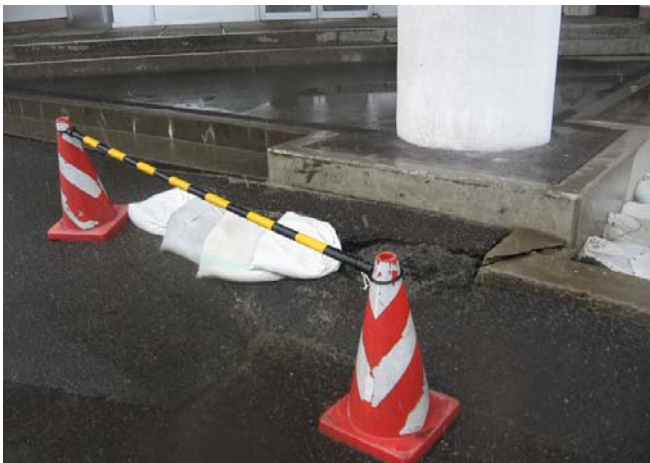
消防署玄関前の亀裂
