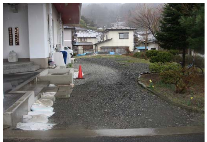
消防署玄関付近の被害、応急処置後
