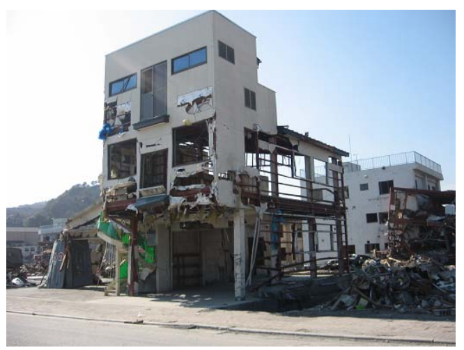
庁舎正面、玄関及び1階事務スペースは流失か
