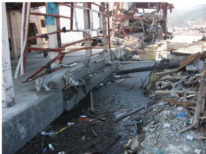
庁舎周辺の被害
