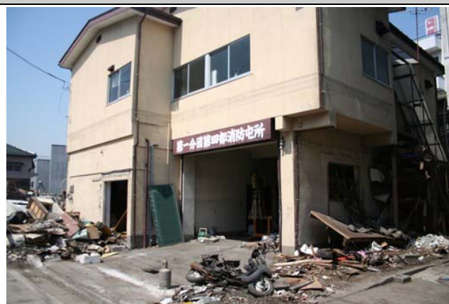
消防本部の付近にある消防団屯所の被害様子
