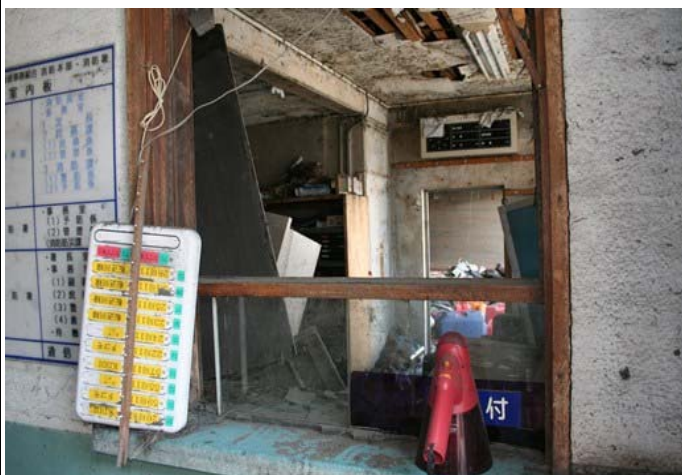
消防本部庁舎の内部、天井も津波のためか崩落
