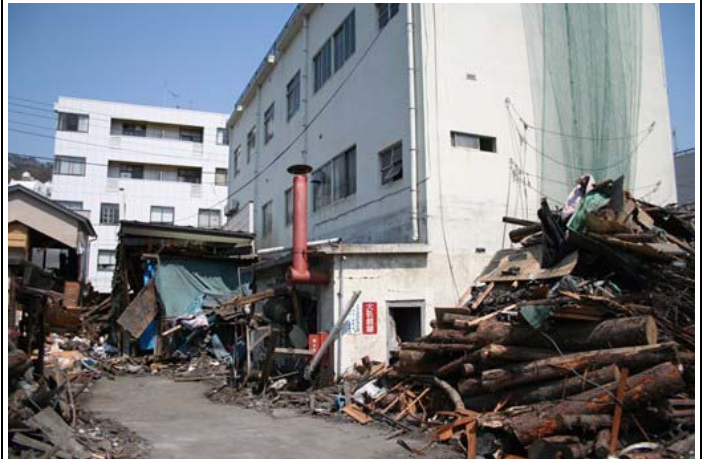
消防本部の裏側、壁体に浸水跡が見られる
