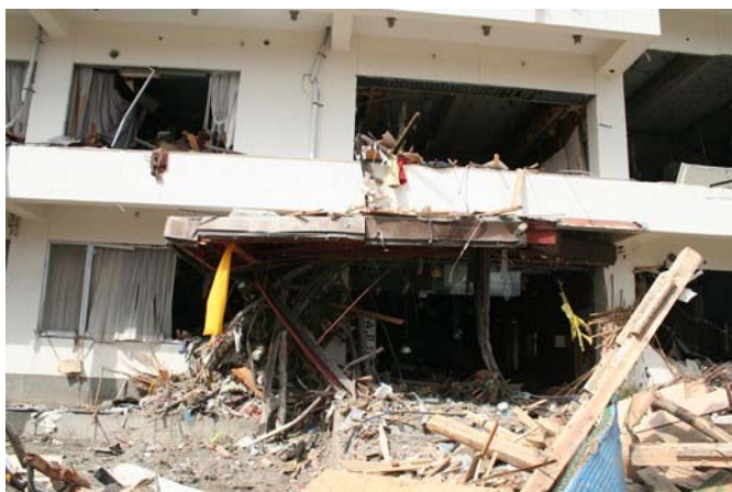
消防署の隣にある中央公民館の被害
