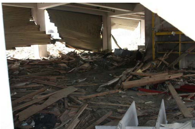
消防署内部の被害
