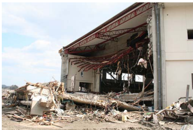
消防署の隣にある市民体育館の被害
