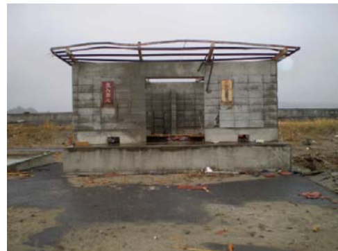
被害状況の写真 2
