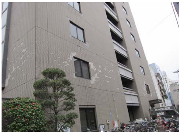
庁舎壁面タイルが一部滑落
