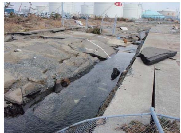
被害状況の写真 2
