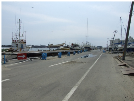
塩竈市魚市場付近の被害の様子 (亀裂が入り段差が生じた道路)
