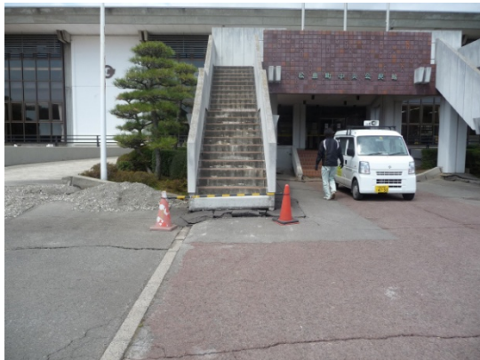
松島町中央公民館の被害の様子
