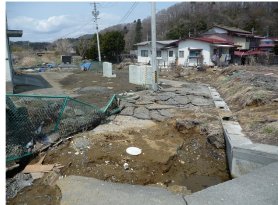
陸前富山駅（仙石線）周辺の被害の様子
