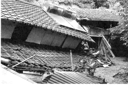
がけ崩れでつぶれた住家
