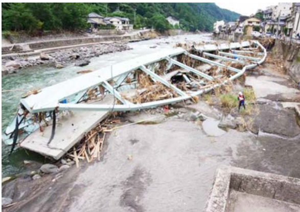
写真2 新天ヶ瀬橋の落橋
