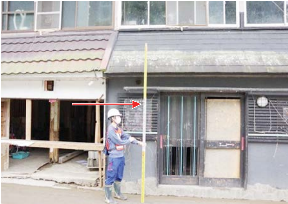
写真1 天ヶ瀬での洪水痕跡
