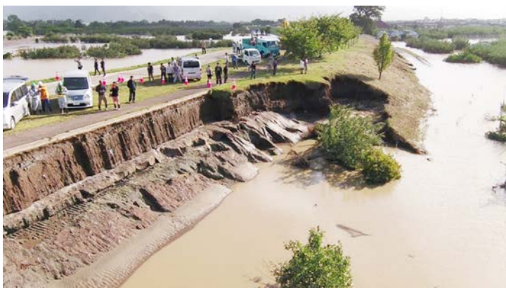
写真3 堤防の侵食と桜堤の喪失：国土交通省北陸地方整備局
