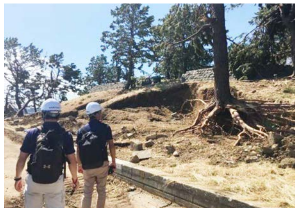
図-7 波浪により侵食された斜面
