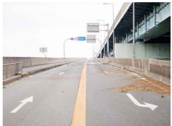
図7 台船の衝突により橋桁が動いた甲子園浜の県道573号線の被災状況
