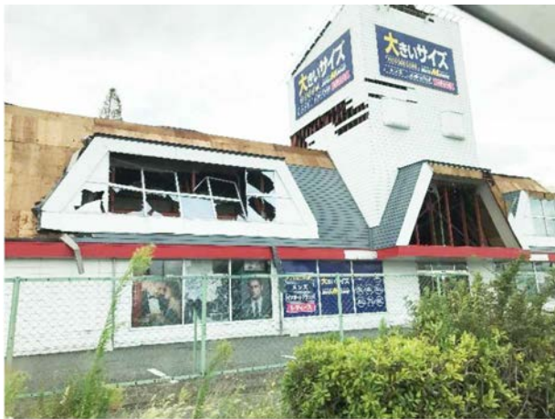
写真5 店舗のガラス破損、外装材剥離（大阪府貝塚市、著者撮影）
