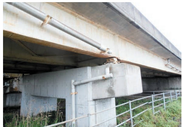
図-10 4月16日の地震後の九州自動車道木山川橋の被害
