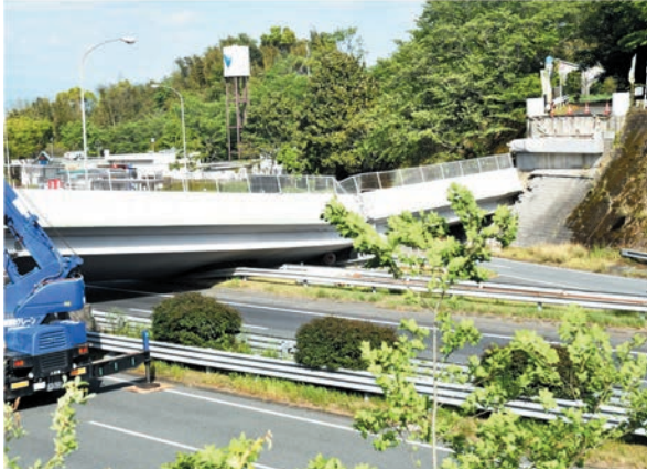
図-11 4月16日の地震後の九州自動車道を跨ぐ府領第一橋の被害
