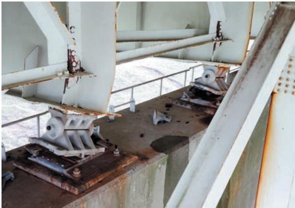
図-12 4月16日の地震後の大分自動車道並柳橋の被害
