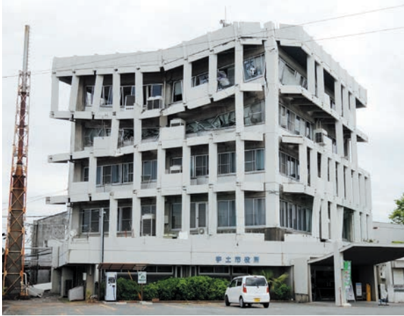
図-9 4月16日の地震後の宇土市役所の被害
