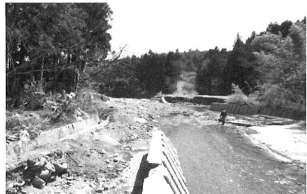
写真-10 滝集落、蟹ノ子皮の護岸破損状況
