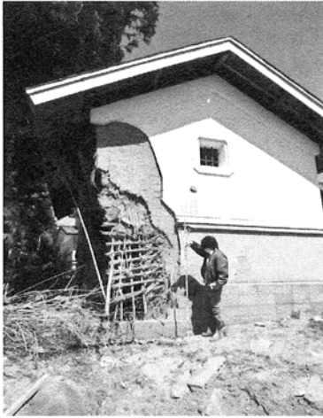
写真-7 滝集落家屋の被災状況
