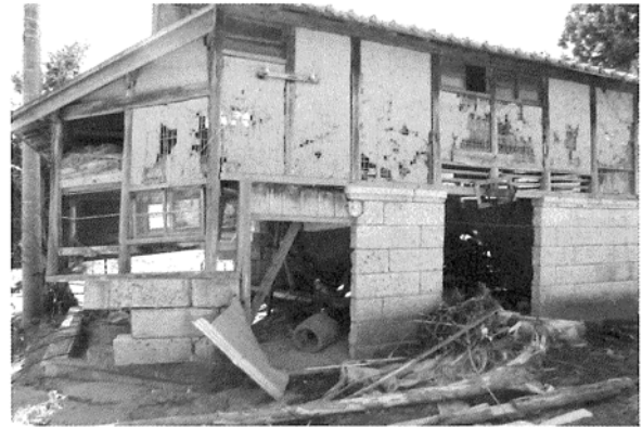
写真-8 滝集落家屋の被災状況
