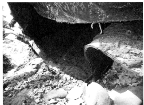
図6 ガソリントankの底板と側板の溶接接合部の破断部
