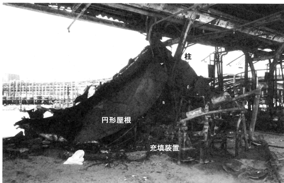
図3 アスファルトタンクの屋根が接触しているガス積荷場の状況
