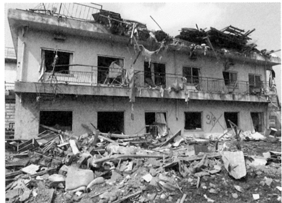
図5 津波が建物に残した瓦礫
