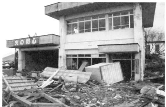
一階が浸水破損した野田分署庁舎
