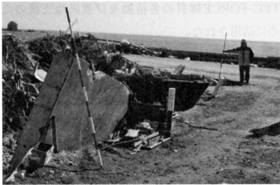
道路の被災状況調査（陥没箇所）
